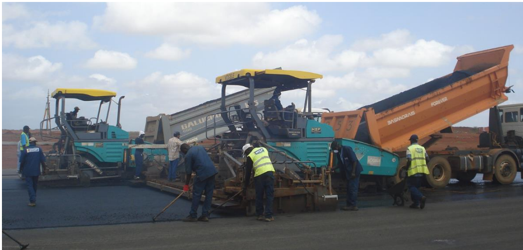
Figura 3.15 – Pavimentação simultânea pelas duas espalhadoras com uma largura de 21 metros de pavimentação de desgaste
