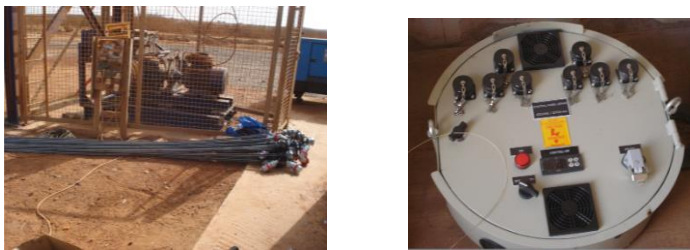
Figura 2.8 – Resistências elétricas e painel de controlo do aquecimento
