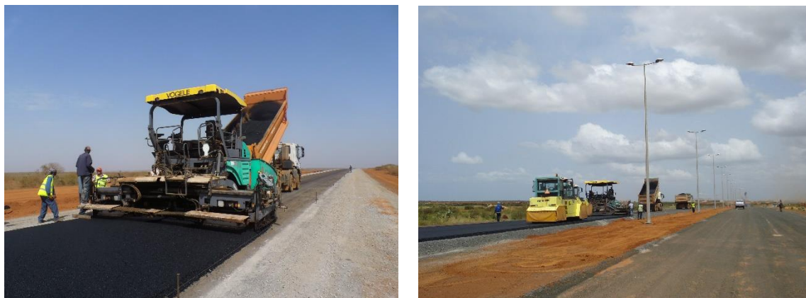
Figura 1.3 – Pavimentação dos caminhos de acesso ao aeroporto incluídos no pacote de trabalhos contratuais “Avenant nº2”
