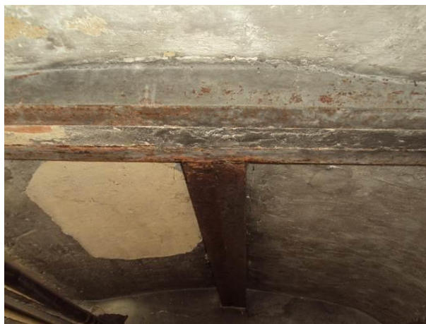
Figura 23: Oxidação dos perfis metálicos (Fonte: Autor, 2016)
