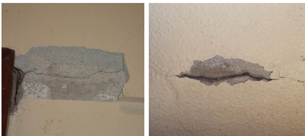
Figura 26: Destacamento acentuado do reboco no piso 1 (Fonte: Autor, 2016)
