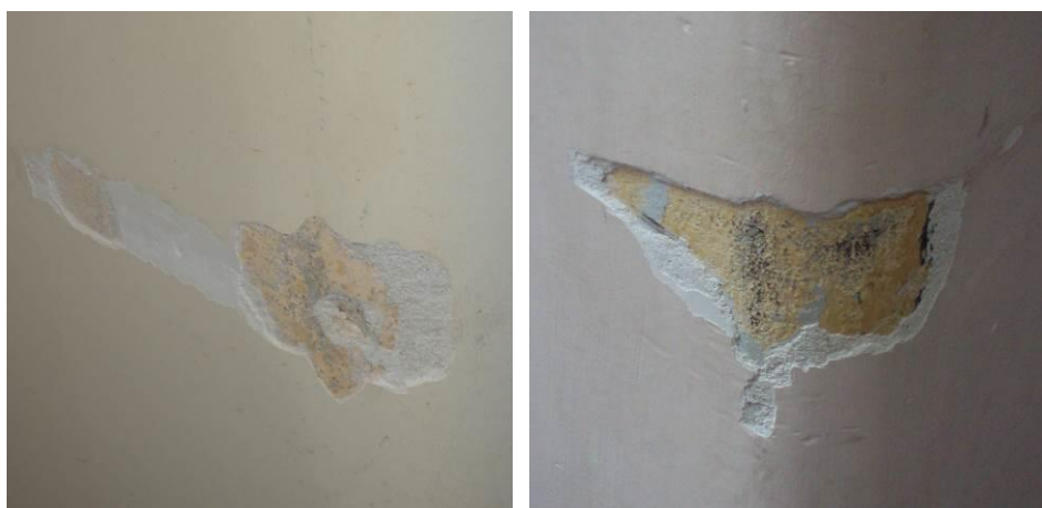
Figura 25: Destacamento acentuado do reboco no piso 0 (Fonte: Autor, 2016)
