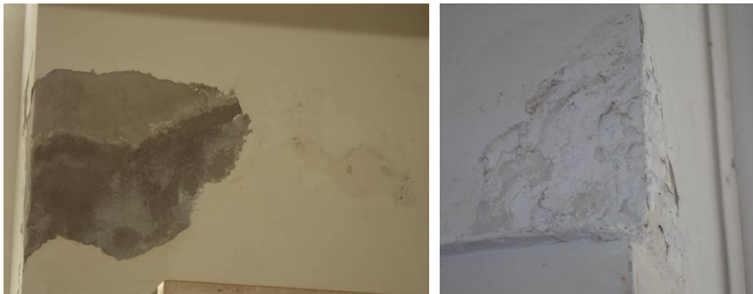
Figura 30: Manchas de humidade no piso 1 (Fonte: Autor, 2016)
