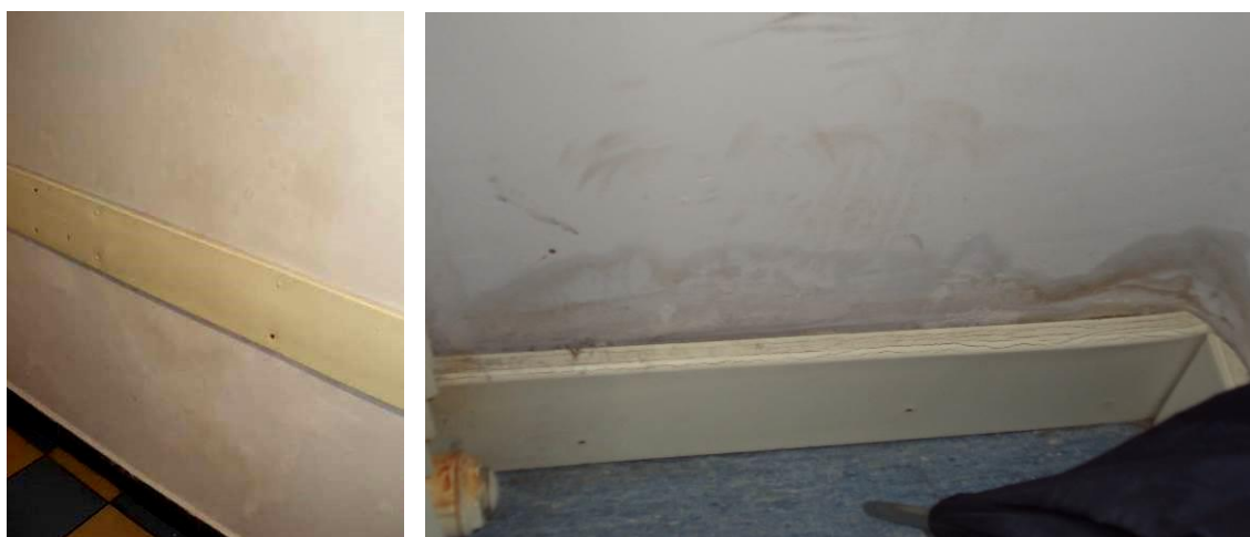
Figura 29: Manchas de humidade no piso 0 (Fonte: Autor, 2016)
