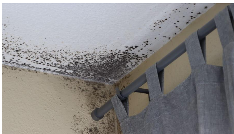
Figura 3.11 – Presença de condensações que conduzem ao aparecimento de vegetação parasitária
