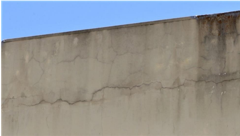
Figura 4.4 – Fissuração longitudinal na platibanda, escorrimentos e presença de vegetação parasitária
