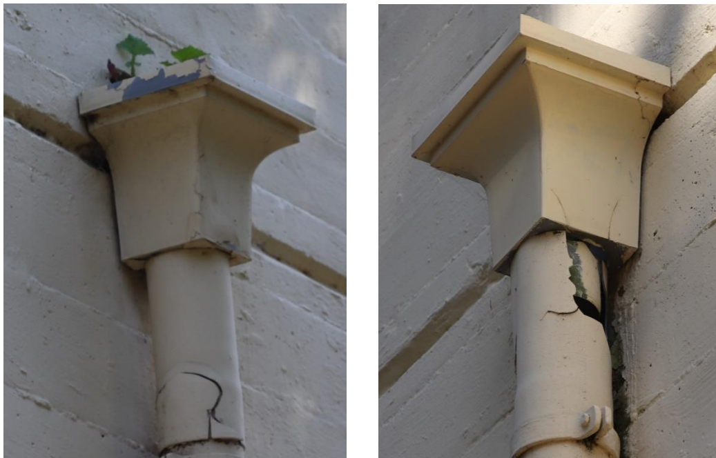
Figura 4.2 – Elementos danificados no SDAP
