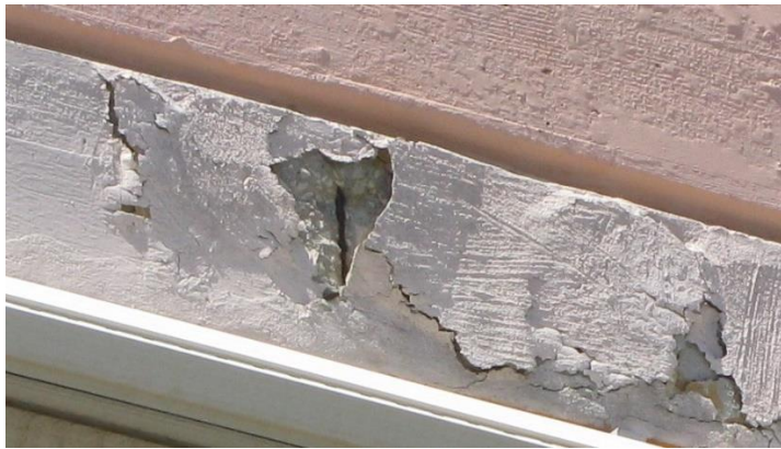
Figura 3.14 – Corrosão das armaduras por insuficiente espessura de recobrimento
