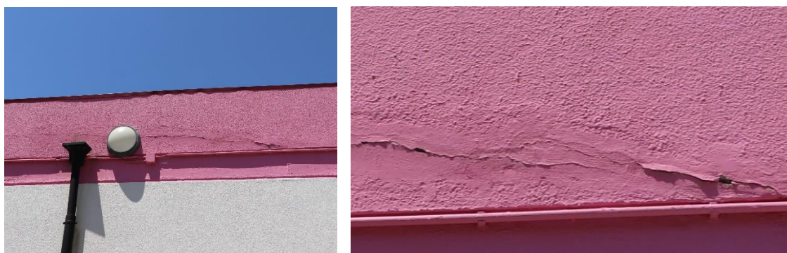
Figura 4.1 – Intervenção de reabilitação executada de forma desadequada
