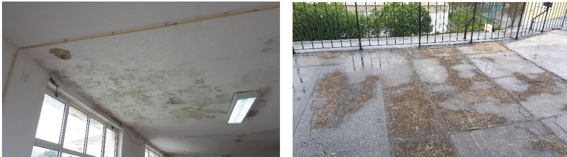
Figura 1.1 – Anomalias em tetos causadas por ausência de manutenção da cobertura
