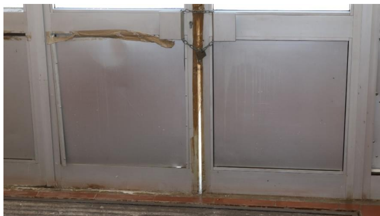
Figura 3.12 – Deformações de portas exteriores que dificultam ou impossibilitam a sua abertura/fecho
