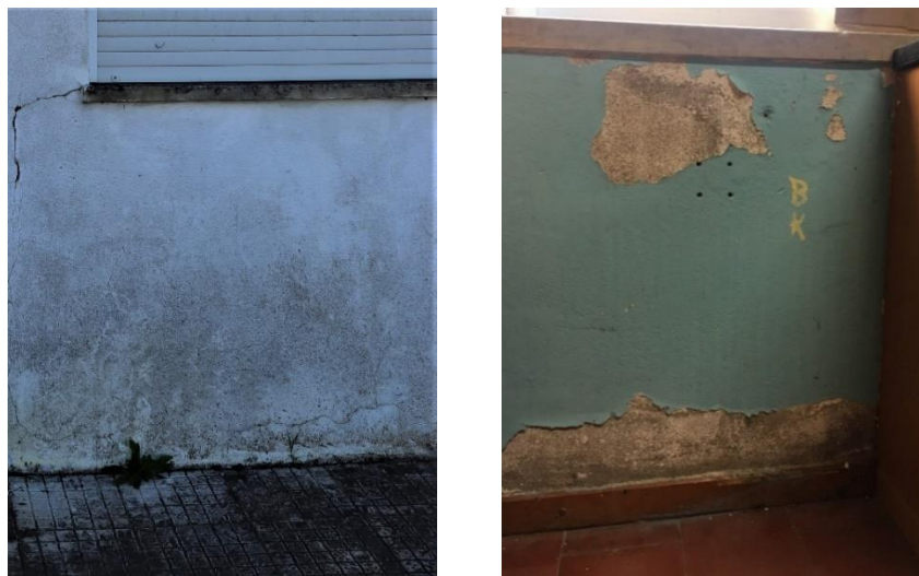
Figura 4.5 – Efeitos da presença da humidade ascensional nas paredes exteriores
