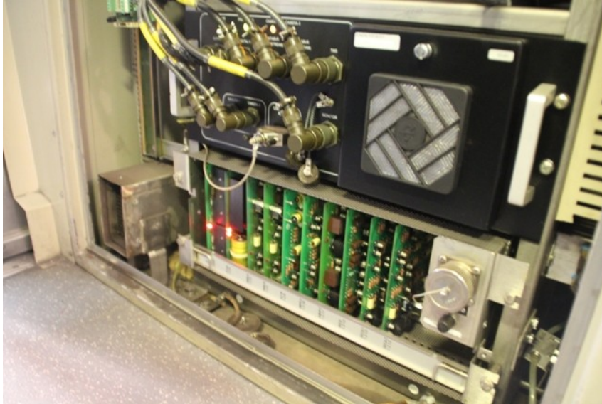
Figura 3.8 - Cofre de Aparelhagem
