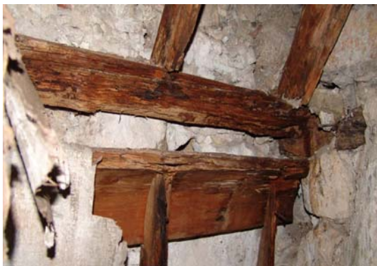
Fotografia 49 – Igreja de Barcarena Podridão cúbica das madeiras
