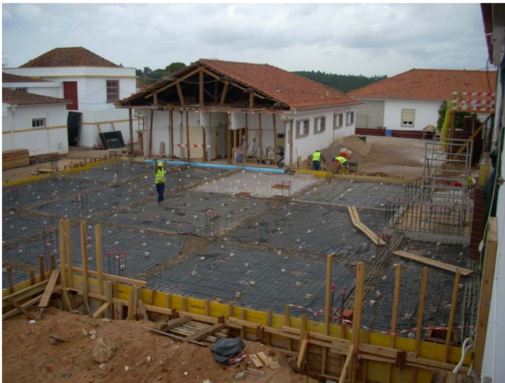
Fotografia 10 - Centro de Saúde de Mora – Laje térrea
