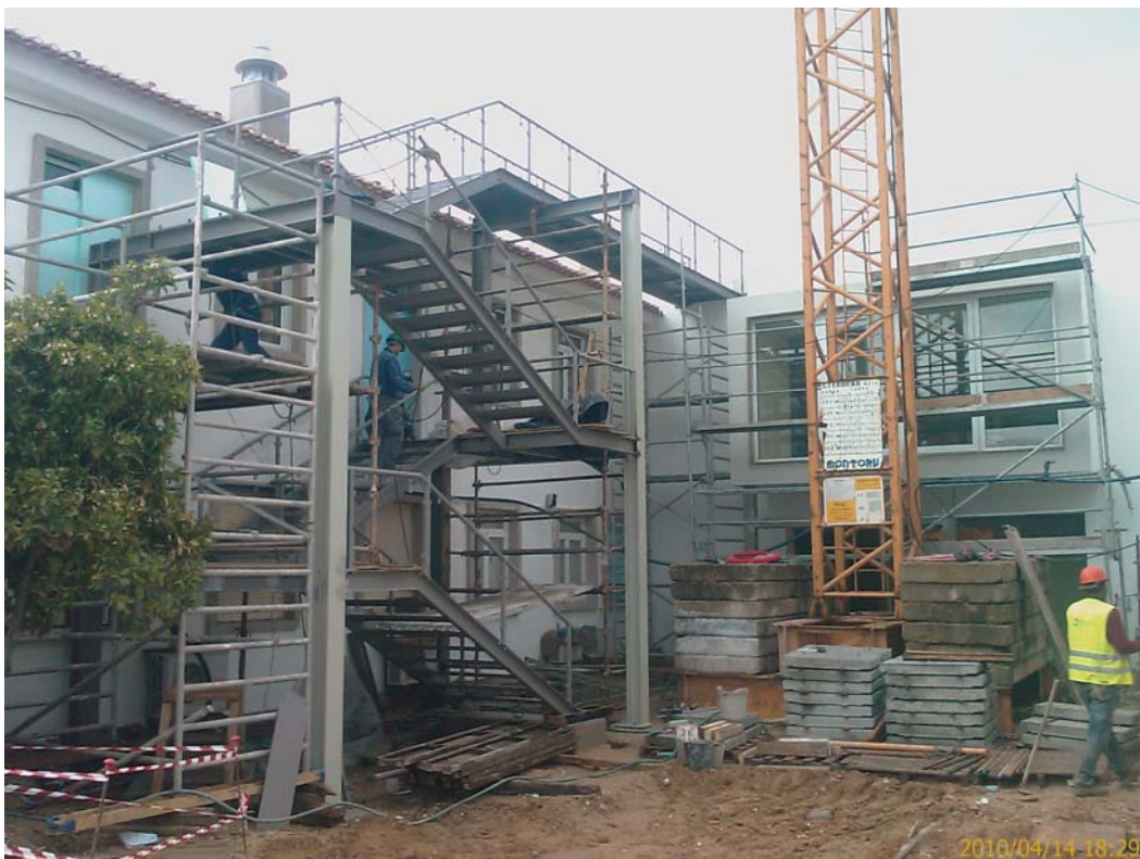
Fotografia 24 - Centro de Saúde de Mora – Escada de emergência e de acesso à cobertura
