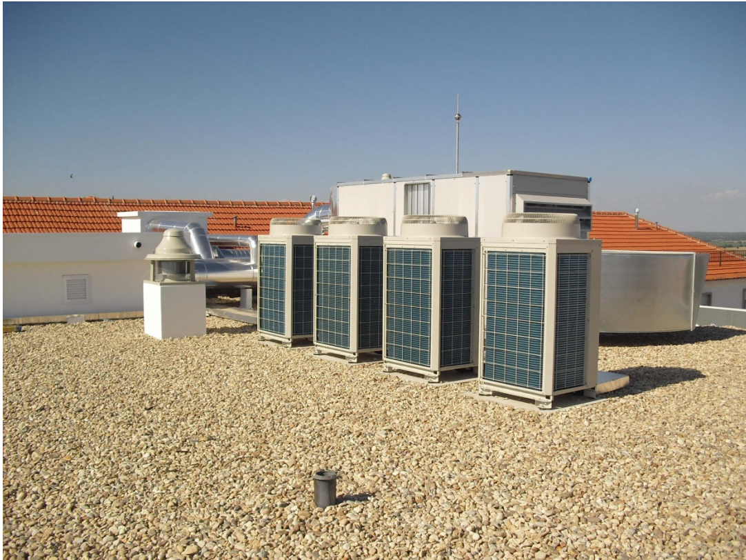
Fotografia 25 - Centro de Saúde de Mora – Equipamento de AVAC na cobertura
