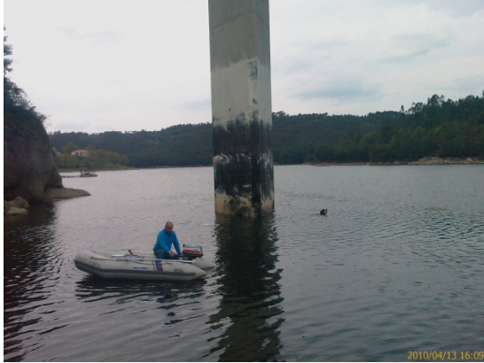
Fotografia 45 – Inspeções Aguieira - Equipa de mergulhadores na Ponte de S. João das Areias
