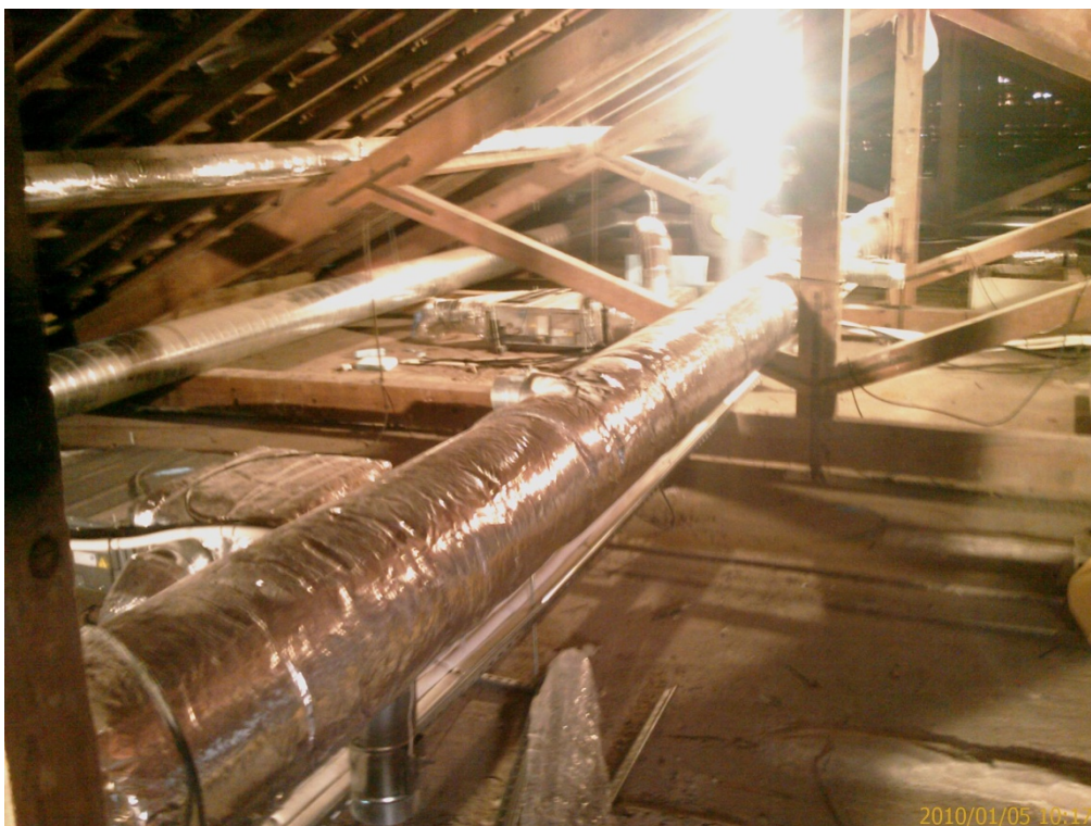
Fotografia 16 - Centro de Saúde de Mora – Rede de Ar Condicionado (Edifício existente)
