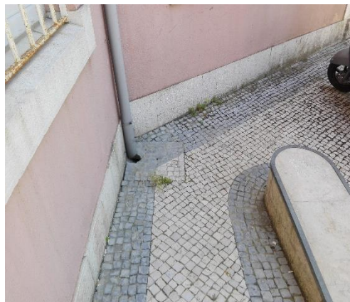
Figura nº 22 – Posicionamento deficiente do tubo de queda
