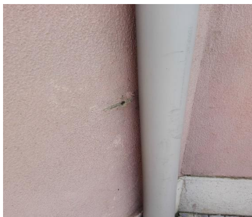
Figura nº 25 – Posicionamento deficiente do tubo de queda
