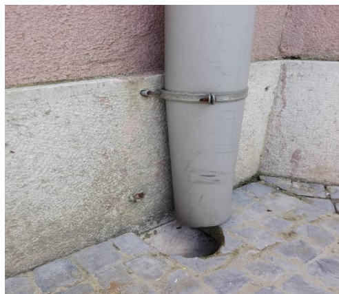
Figura nº 24 – Posicionamento deficiente do tubo de queda
