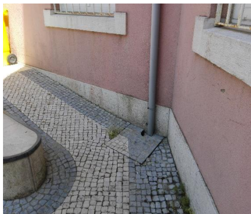
Figura nº 23 – Posicionamento deficiente do tubo de queda
