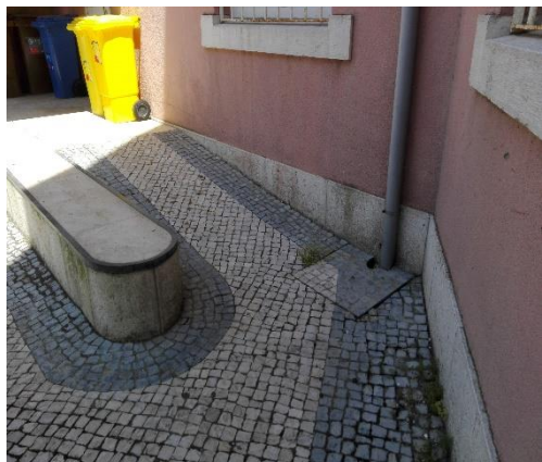
Figura nº 21 – Posicionamento deficiente do tubo de queda
