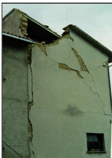
Figura 4.16- Fendas verticais do tipo 7; Fendas diagonais e horizontais do tipo 3 e tipo 11 (Busche, PG, 1998).
