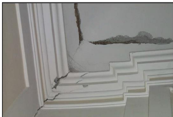
Figura 4.21- Fendas interiores do tipo 7. Grau de dano: D2-D3 (Tortora, CS, 1998).
