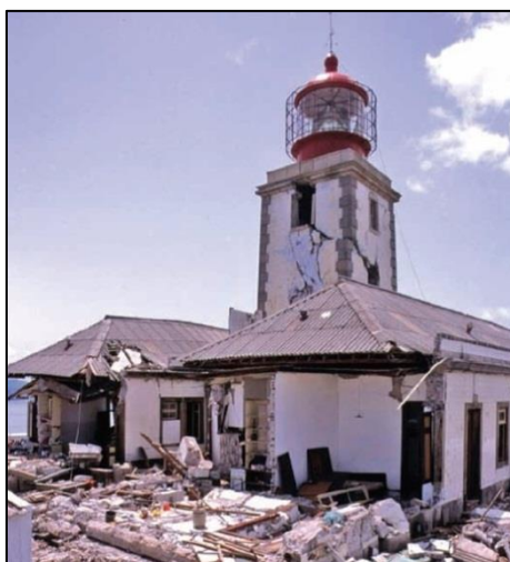
Figura 2.5- Danos causados no Farol da Ribeirinha (Madeira & Silveira, 2007).
