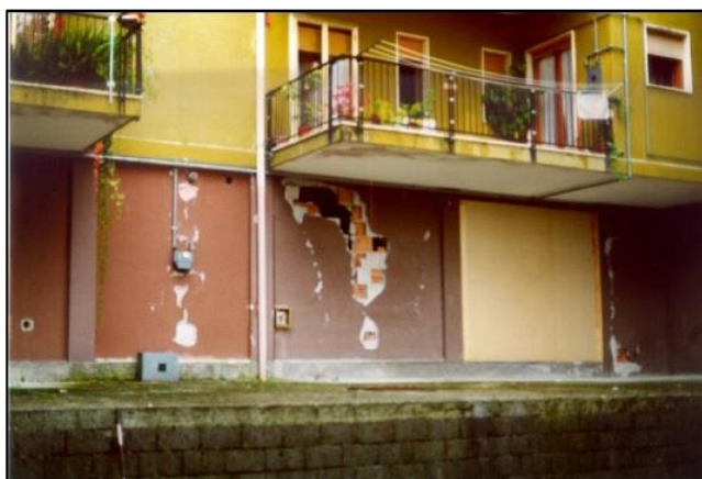
Figura 4.43 - Grau de dano do enchimento: D4. (Castelluccio Inferiore, PZ, 1998).
