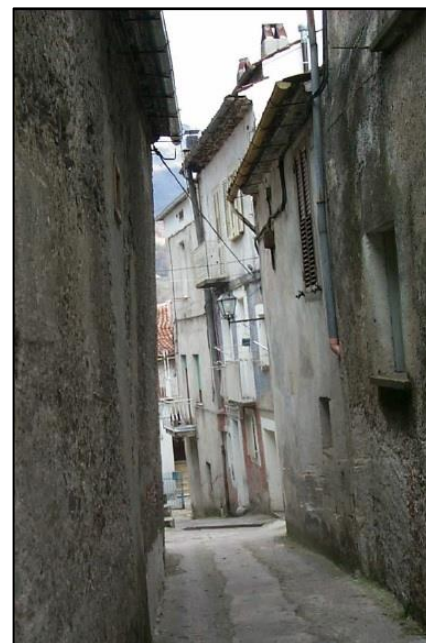
Figura 4.15- Desaprumo pré-existente. Grau de danos pré-existent do edifício: D1 (Baggio, et al., 2007).
