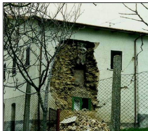
Figura 4.24- Fendas do tipo 12 e do tipo 3, com espessura de alguns cm. Grau de dano: D4. (Busche, PG, 1996).
