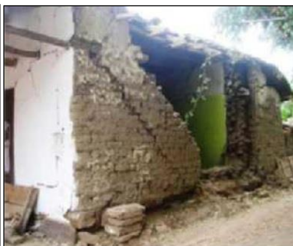
Figura 2.10- Colapso através do mecanismo de falha fora do plano (Astroza, Ruiz, & Astroza, 2012).
