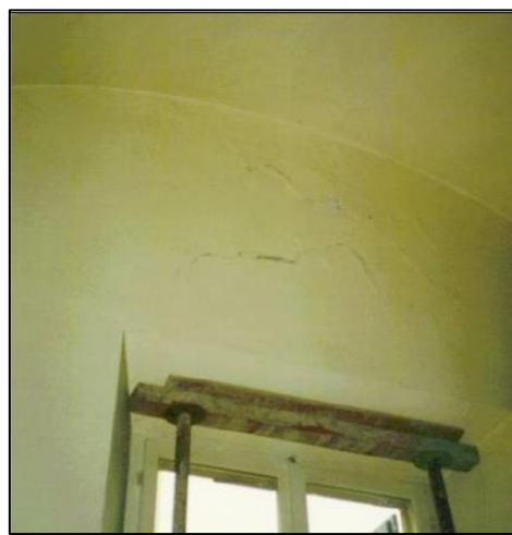
Figura 4.13 - Fissuras verticais do tipo 1 e do tipo 2. Grau de dano: D1. (Correggio, RE, 1996).
