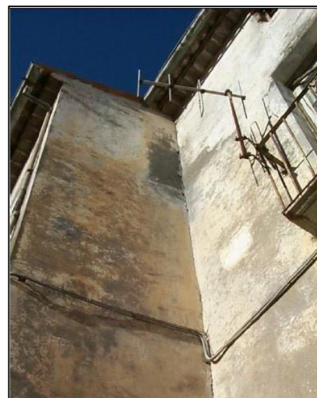
Figura 4.14- Fendas verticais ao longo de duas paredes ortogonais (tipo 6). Grau de danos: D1 (Tortora CS, 1998).
