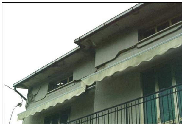
Figura 4.25- Fendas do tipo 12; Fenda no canto do tipo 9. Grau de dano: D4-D5. (Busche, PG, 1998).
