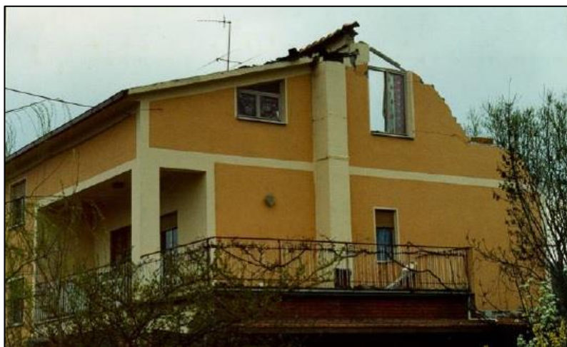
Figura 4.35- Grau de dano da cobertura: D4-D5 (Baggio, et al., 2007).
