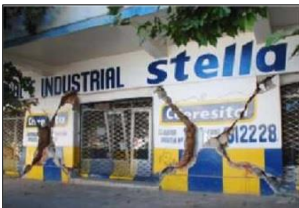
Figura 2.15- Danos no plano de corte de paredes (Astroza, Ruiz, & Astroza, 2012).
