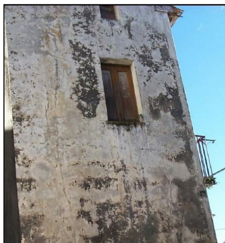
Figura 4.12 - Fendas verticais do tipo 1 e do tipo 6. Grau de dano: D1. (Tortora, CS, 1998).
