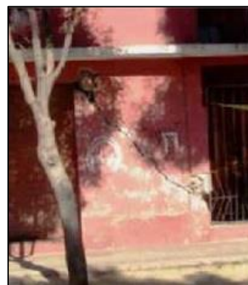
Figura 2.16- Danos em pilares de betão armado (Astroza, Ruiz, & Astroza, 2012).
