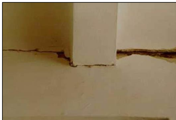
Figura 4.26- Grau de dano da estrutura horizontal: D2-D3. (Treia, 1998).
