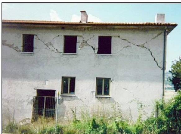
Figura 4.18- Fendas diagonais nos pilares do tipo 3, ligadas com as fissuras do tipo 1; Grau de dano: D4 (Baggio, et al., 2007).
