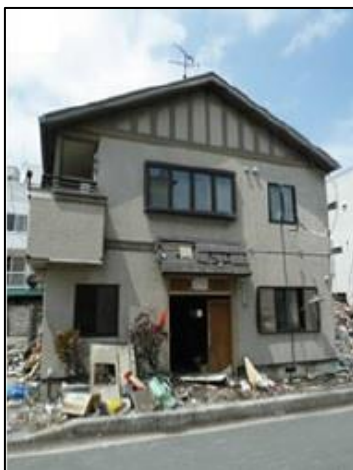
Figura 2.7- Danos em edifício com estrutura de madeira, Kamaishi 2011 (Fraser, et al., 2012).
