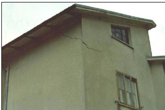
Figura 4.23- Fendas do tipo 9. Grau de danos: D2-D3. (Cerqueto, PG, 1998).
