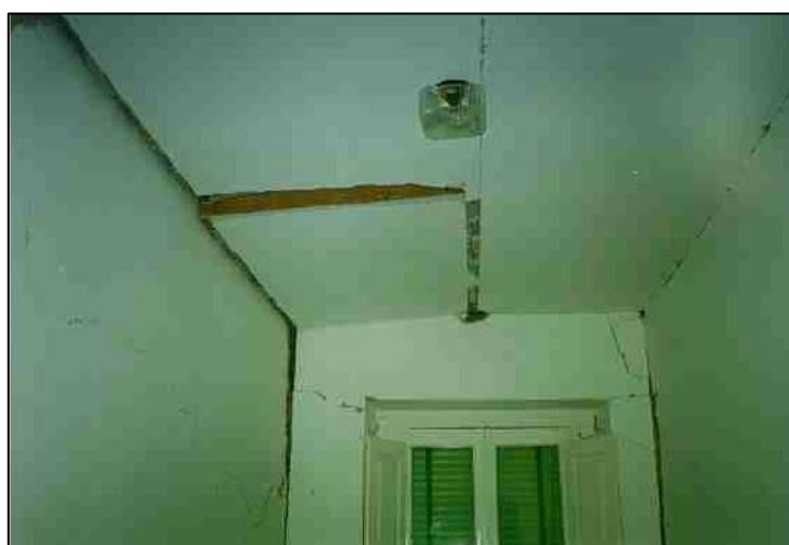
Figura 4.32- Grau de dano do teto: D4. Grau de dano das estruturas verticais: D4.
