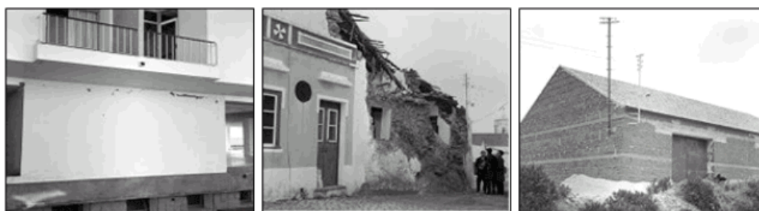
Figura 2.1- Danos em edifícios afetados pelo sismo de 1969 (Marecos & Castanheta, 1970).
