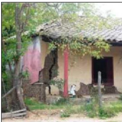
Figura 2.9- Fissuras verticais nos cantos (Astroza, Ruiz, & Astroza, 2012).
