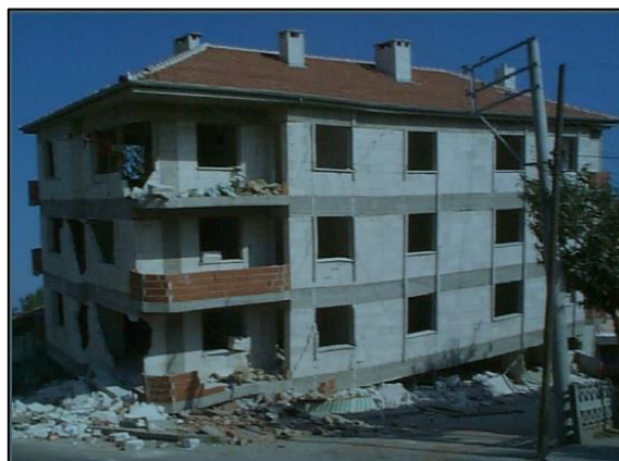
Figura 4.47- Colapso devido a soft story no piso térreo. Grau de dano: D5 (Turkey, 1999).
