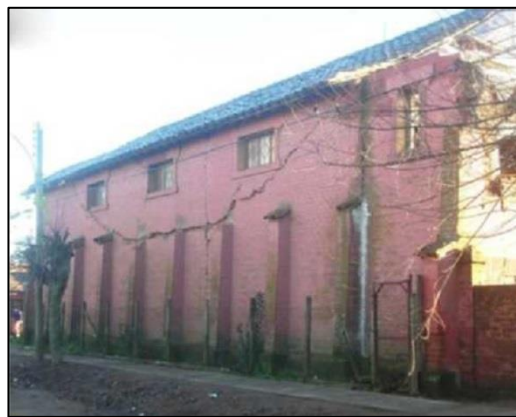
Figura 2.12- Danos típicos de edifícios de alvenaria não reforçada, em Putuchurch (Astroza, Ruiz, & Astroza, 2012).
