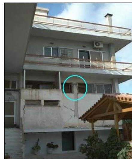
Figura 4.10 – Presença de pilar curto (Baggio, et al., 2007).
