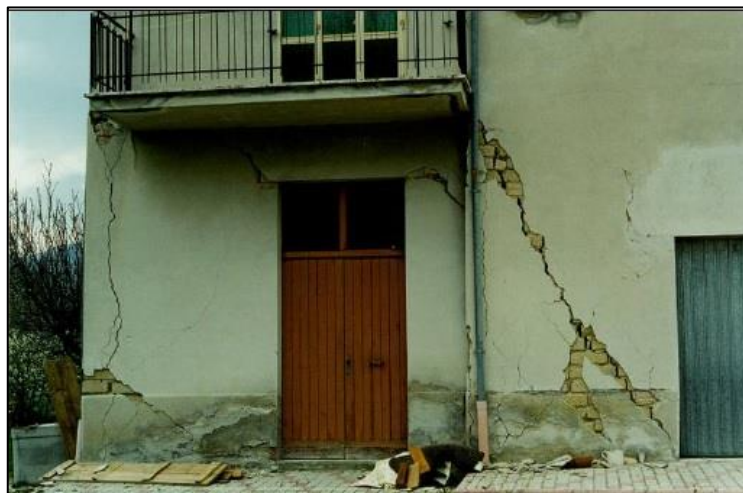
Figura 4.30- Fendas verticais do tipo 7 e fendas diagonais do tipo 3 em pilar de alvenaria. Grau de dano da parede: D3.
