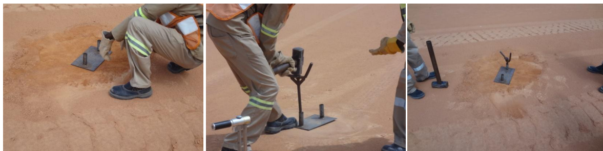
Figura 3.29: Execução de furo no solo com recurso a placa guia e vara de cravação (Troxler).
