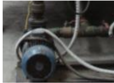
Bomba circulação nº1
