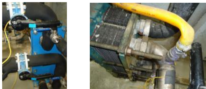
Figura 4.7 – Permutadores de calor (Fonte: CCenergia, 2014)
