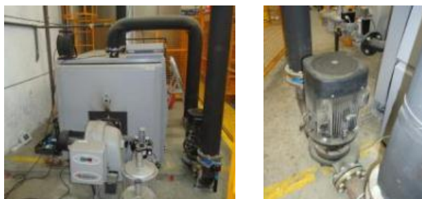
Figura 4.6 – Caldeira e bomba de água
