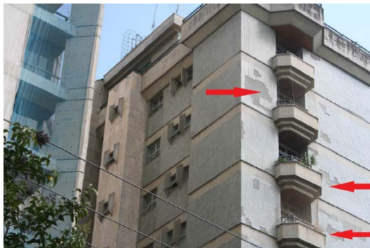
Figura 2.29 Descolamento num edifício de habitação [2].
