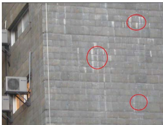
Figura 2.30 Eflorescências na fachada de um edifício [2].
