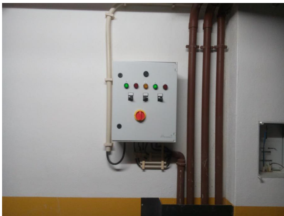
Figura 28 - Quadro de Grupo de Bombagem.
