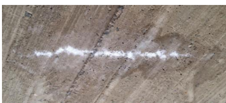
Figura 2.4 - Manchas de eflorescências visíveis no betão (adaptado de Brito et al., 2002).
