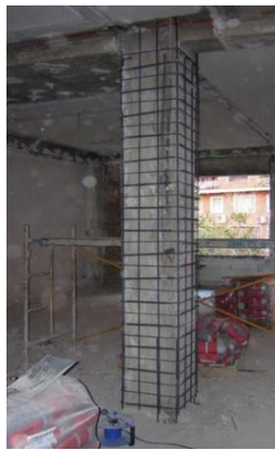
Figura 6.17 - Encamisamento de um pilar (adaptado de Correia, 2011).
