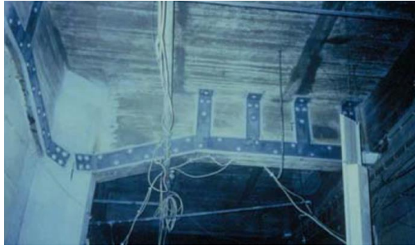
Figura 6.18 - Reforço de estrutura em betão com chapas de aço coladas (adaptado de Correia, 2011).
