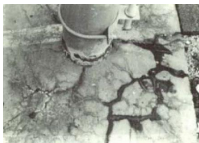
Figura 2.11 - Sapata de uma torre de rede elétrica com betão contaminado com sulfatos (adaptado de Brito et al., 2002).
