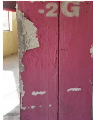
Figura 8.6 - Eflorescências e criptoflorescências nos pilares do piso -2 (Fonte: Autor).
