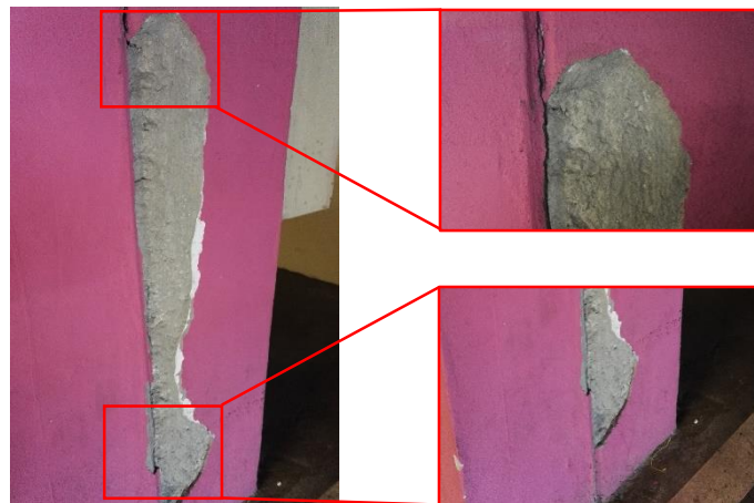
Figura 8.8 - Destacamento de betão num pilar do piso -2 (Fonte: Autor).
