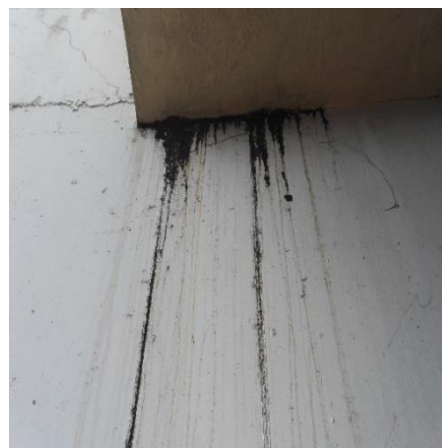
Figura 8.3 - Infiltrações na zona das escadas (Fonte: Autor).
