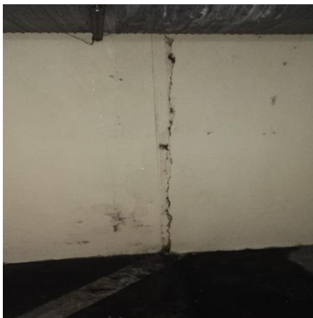
Figura 8.2 - Infiltrações na parede do parque de estacionamento (Fonte: Autor).
