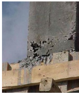
Figura 2.2 - Vazios no betão (Brito et al., 2002).
