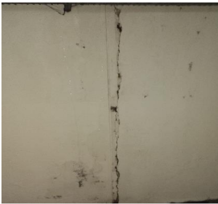
Figura 8.9 - Fissuração nas paredes dos parques de estacionamento (Fonte: Autor).
