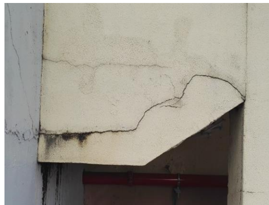
Figura 8.10 - Fissuração nas escadas de acesso aos escritórios (Fonte: Autor).
