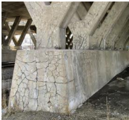
Figura 2.10 - Fissuração devido a reação álcalis-silica (Thomas et al., 2011).
