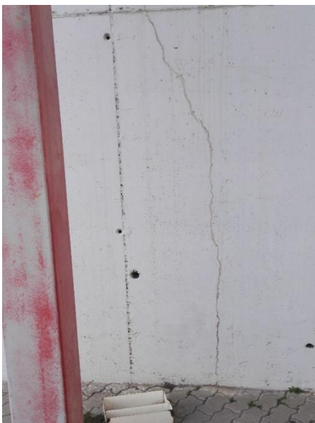
Figura 8.11 - Fissuração visível no muro de suporte (Fonte: Autor).
