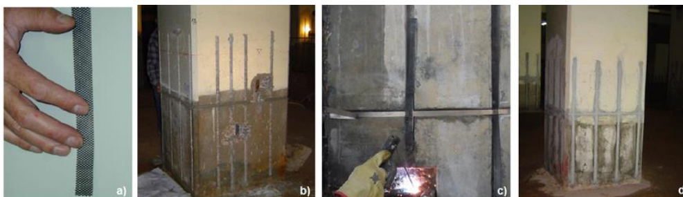
Figura 6.8 - Fitas de Ti/MMO a), abertura de roços no betão b), instalação das fitas nos roços c), aplicação de argamassa de enchimento nos roços d) (adaptado de Correia, 2011).
