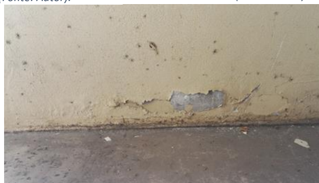
Figura 8.7 - Criptoflorescências nas paredes dos pisos de estacionamento (Fonte: Autor).
