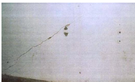
Figura 2.9 - Fissuração devida a assentamentos diferenciais de apoios (adaptado de Brito et al., 2002).
