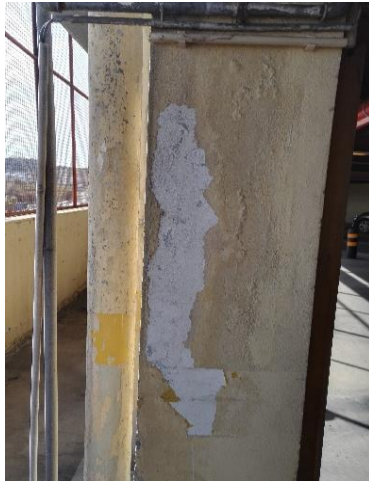
Figura 8.5 - Eflorescências e criptoflorescências nos pilares no piso -1 (Fonte: Autor).
