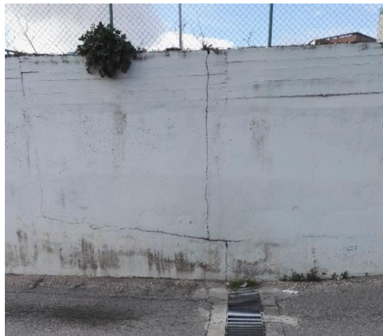
Figura 8.4 - Manchas de humidade nos muros de suporte (Fonte: JR)
