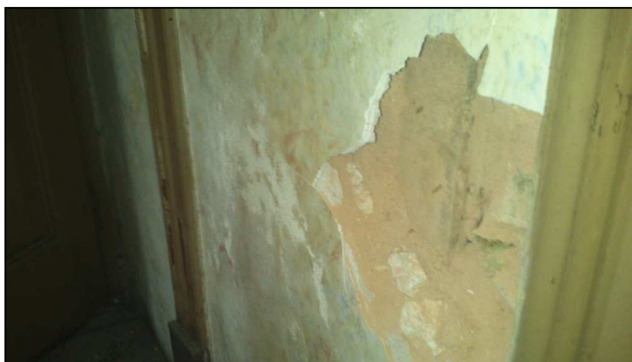
Figura 22- reboco degradado em parede
