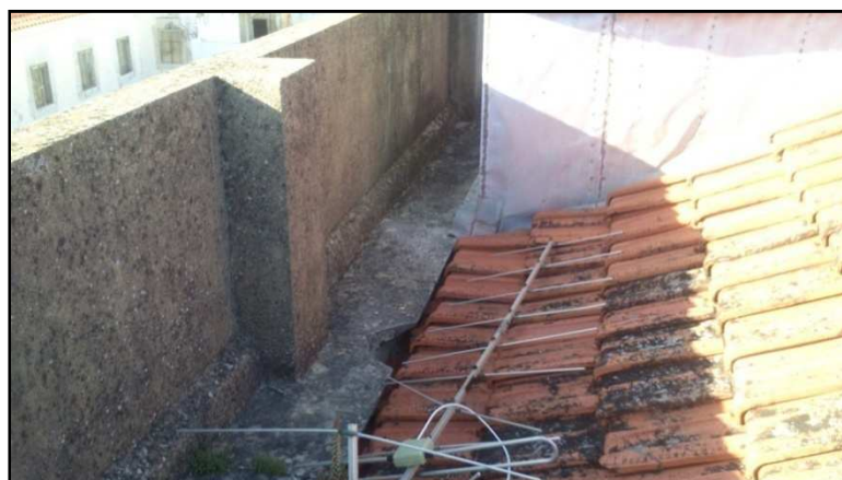
Figura 33- Platibanda necessitando de limpeza superficial e conservação pontual
