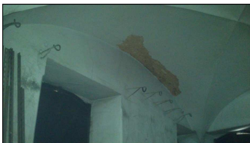
Figura 14 - Reboco apresentando destacamentos pontuais na abóbada
