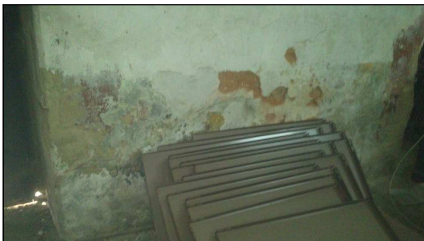
Figura 15 - Reboco degradado numa parede da loja
