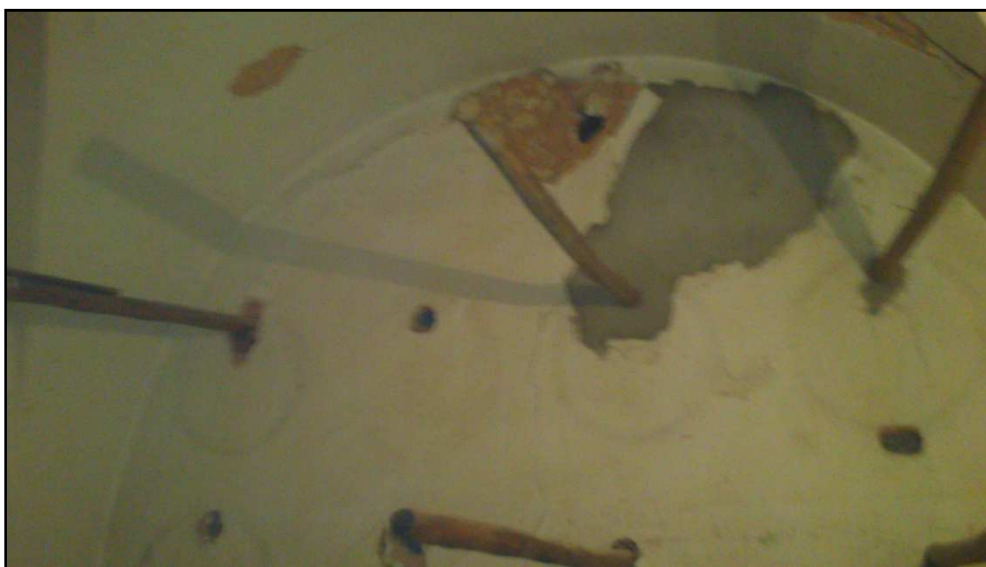
Figura 18 - Reboco da parede e abóbada degradada na oficina
