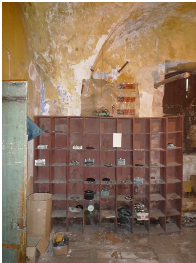
Figura 17 - reboco degradado na contra-loja
