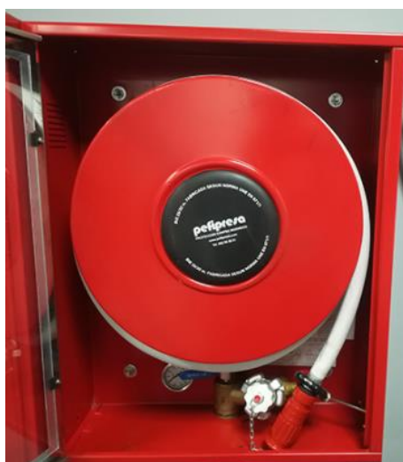
Figura 2.23 – Boca de incêndio do tipo carretel [41]
