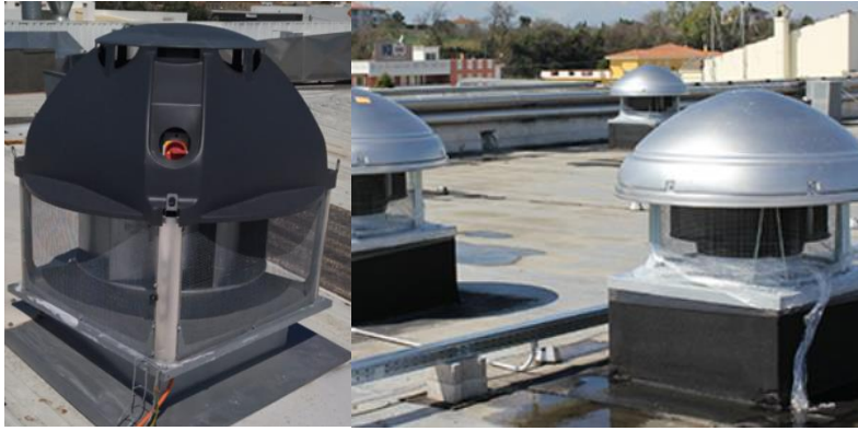
Figura 2.38 – Ventiladores de extração de fumo [59]
