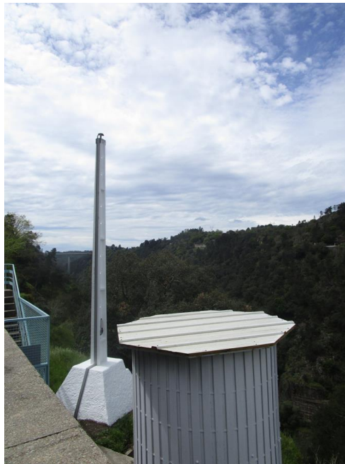
Figura 2.8 – Estação GNSS na margem esquerda, instalada num poste de média tensão.
