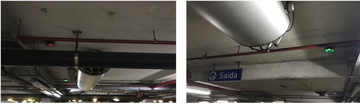
Figura 1.2: Ventiladores de impulso colocados com obstruções como vigas e tubagens.
