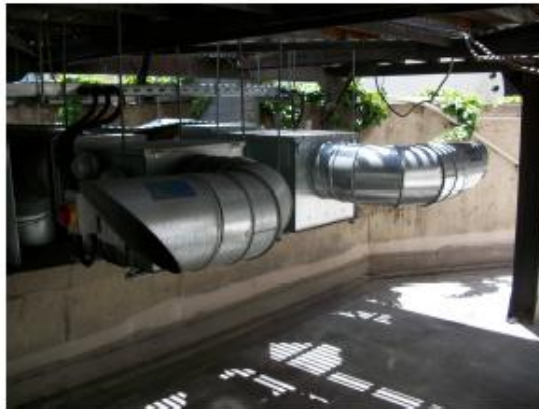
Figura 30 – Ventiladores de insuflação (esq.) e extracção (dir.).
