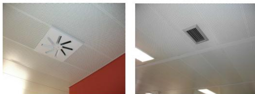
Figura 28 – Grelha de insuflação. Figura 29 – Grelha de extracção.
