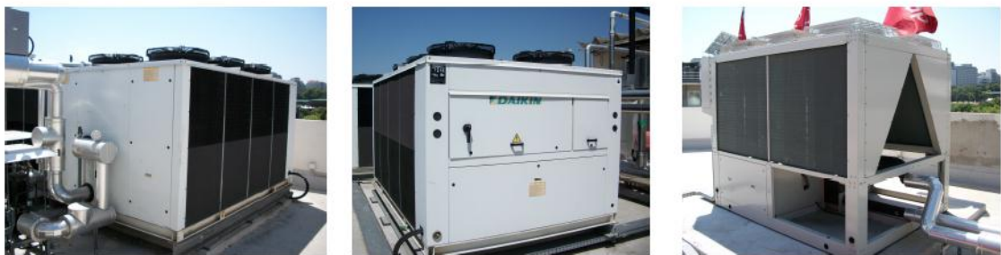
Figura 27 – Chillers/Bombas de calor.
