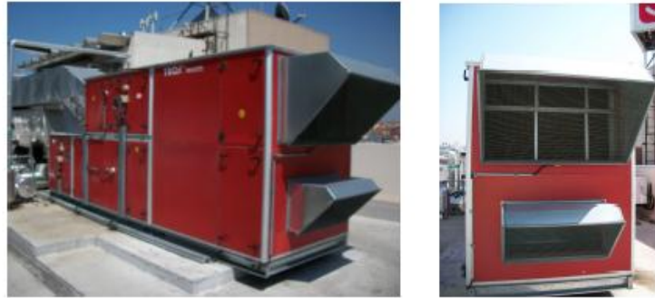
Figura 26 – Unidade de tratamento de ar novo (UTAN).
