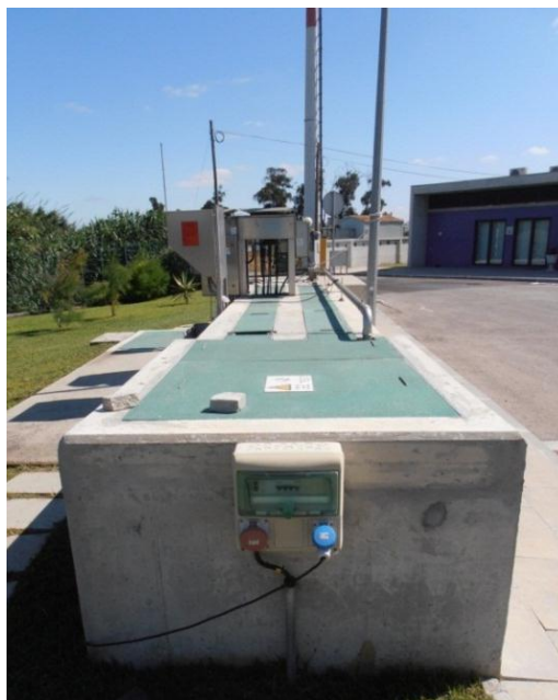
Figura 5-4 – Dispositivo de desinfecção UV da ETAR de Alcochete
