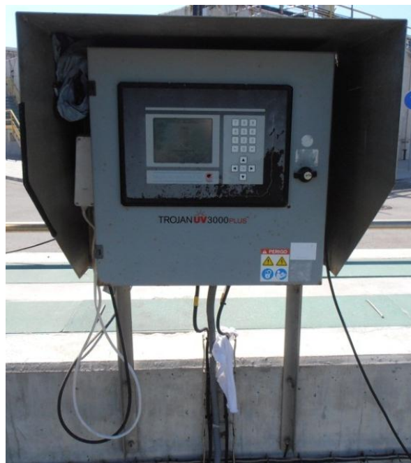
Figura 5-6 – Painel de controlo do sistema de desinfeção por UV da ETAR de Alcochete
