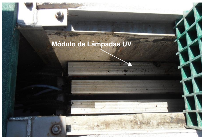
Figura 5-7 – Módulos de LBPEI instalados no canal de desinfecção na ETAR de Alcochete
