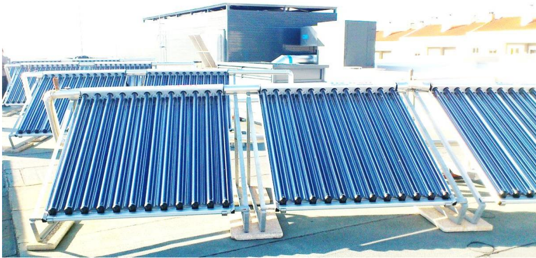
Figura 2.1 - Painéis Solares Térmicos (4)
