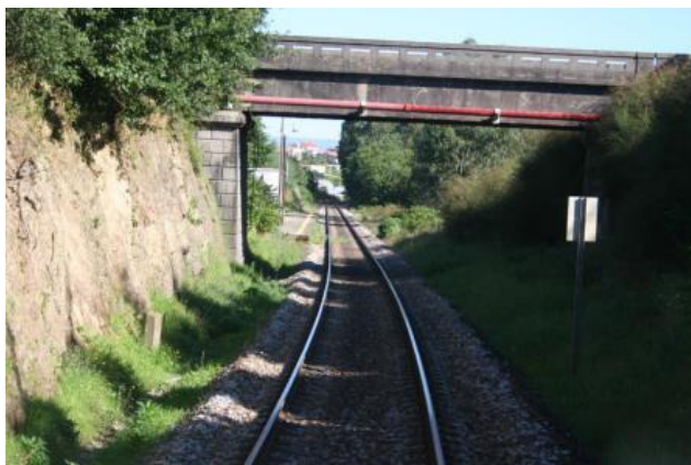
Figura 3-3 Zona de rebaixamento na PSR ao PK 43+026 em São Miguel da Carreira
