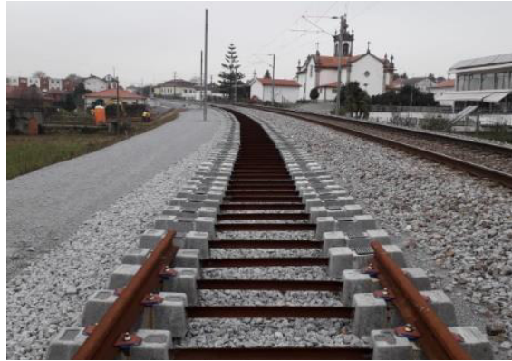
Figura 5-9 Barras de carril com as respetivas fixações
