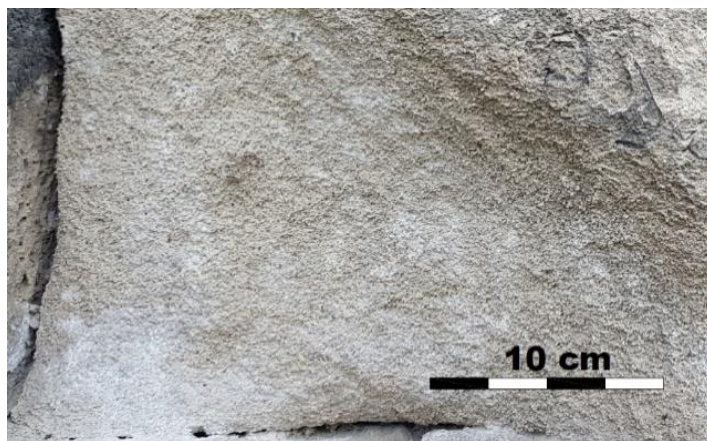
Figura 4.12 - Desintegração granular e presença de eflorescências salinas.
