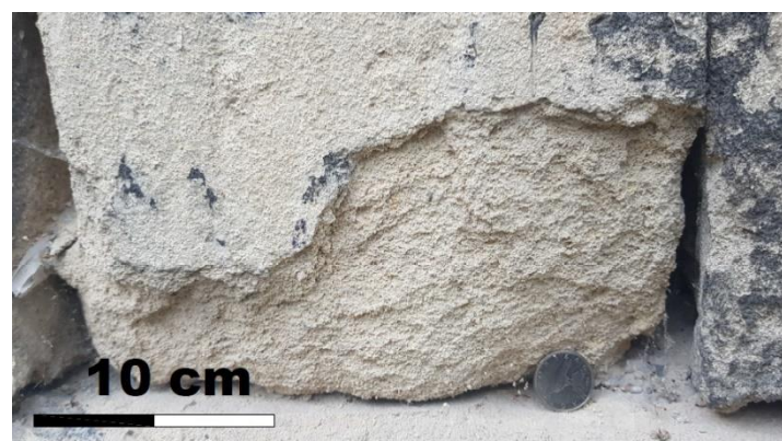
Figura 4.11 - Crosta branca espessa com destacamento.
