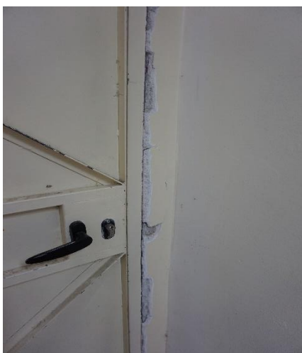
Figura nº 3 – Destacamento do Reboco na periferia da porta
