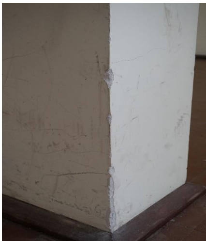
Figura nº 1 – Destacamento do Reboco na empena
