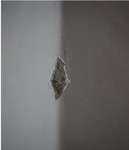
Figura nº 9 – Destacamento do Reboco
