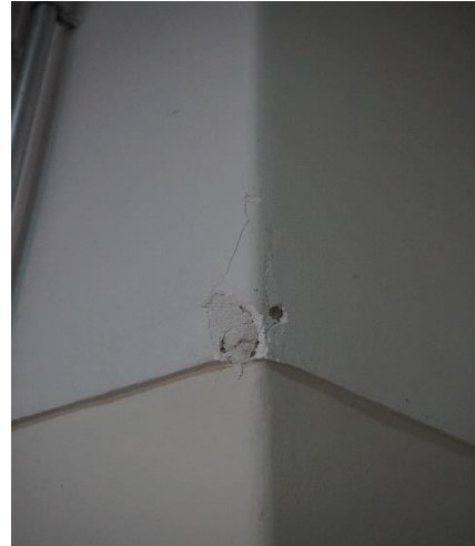
Figura nº 10 – Destacamento do Reboco
