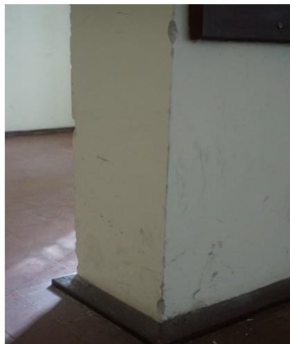
Figura nº 2 – Destacamento do Reboco na empena
