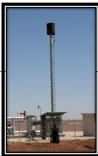
Figura 5: Caldeira para queima do biogás
