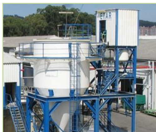
Figura 6 - Estação de tratamento de águas residuais
