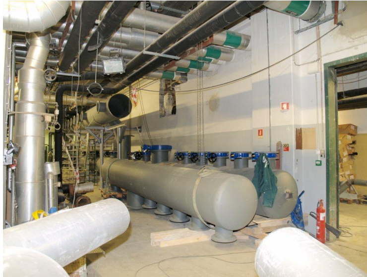
Figura 30 – Foto do Coletor “H” instalado no Edifício
