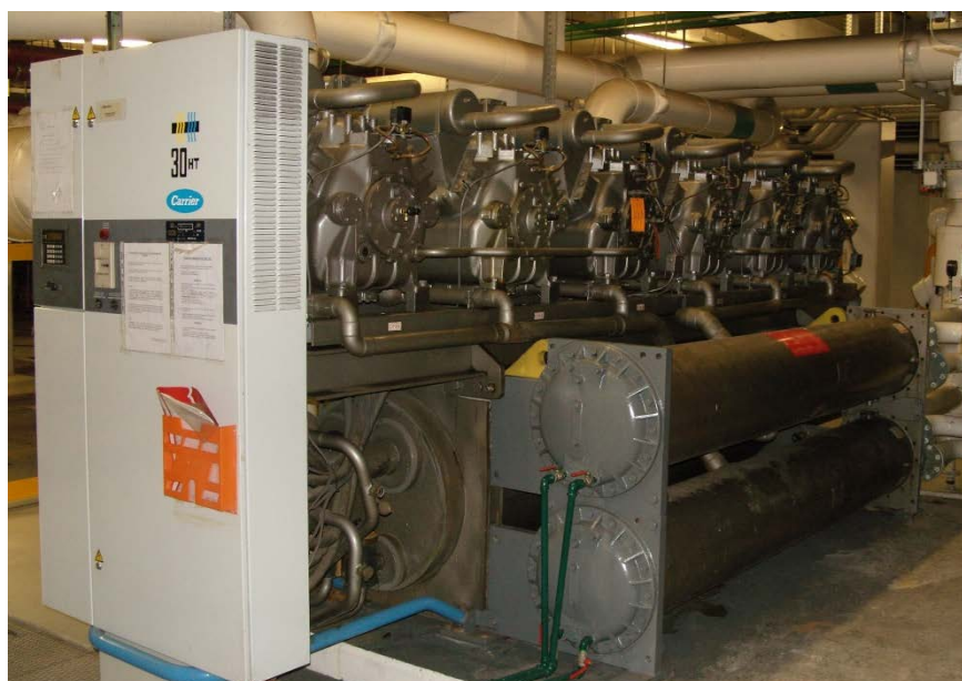
Figura 3.4 – Grupo produtor de água fria (Carrier® - 30HTY370)
