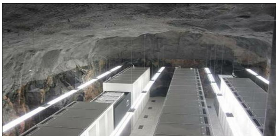
Figura 1.3 - Data Center dentro de um bunker [s12]
