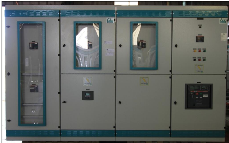
Figura 2.18 - Quadro Geral de Baixa Tensão [s37]
