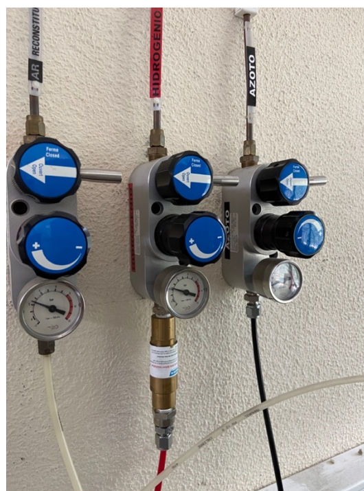
Figura 47 - Torneiras dos gases provenientes da rede.
