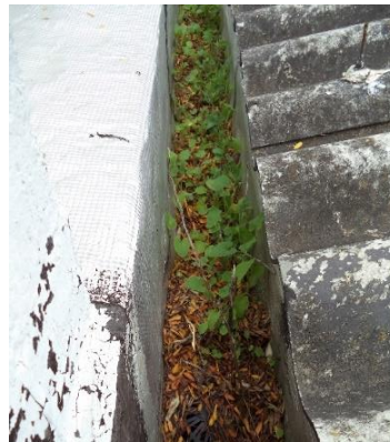
Figura 5.12- Obstrução de caleira com visível presença de vegetação - UCSP Lapa (Fonte: Autor)
