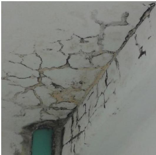
Figura 5.22 – Destacamento em parede interior na zona do teto - UCSP Lapa (Fonte: Autor)
