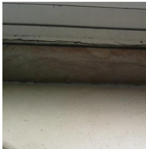
Figura 5.3 – Pormenor, na zona da janela, do estado de degradação da madeira e do material isolante - UCSP St Condestável (Fonte: Autor)
