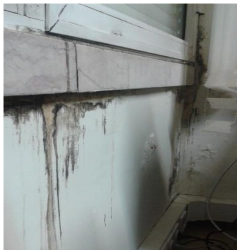
Figura 5.2 – Vão envidraçado com manifestações de humidade - UCSP St Condestável (Fonte: Autor)
