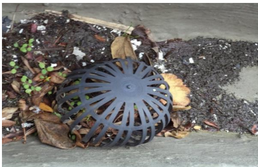
Figura 5.13 - Pormenor de um ralo de pinha, deslocado do tubo de queda, totalmente coberto de detritos - UCSP Lapa (Fonte: Autor)
