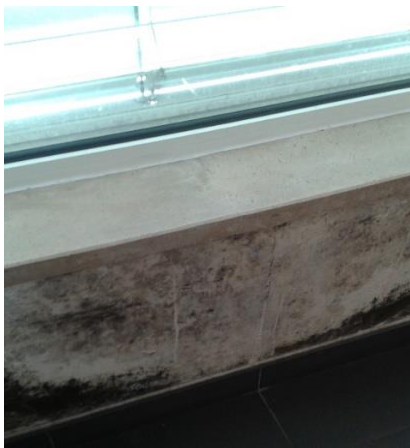
Figura 5.5 – Parede junto a porta com manifestações de humidade - CS Paço De Arcos (Fonte: Autor)
