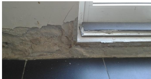
Figura 5.6 - Estado de degradação da parede devido à humidade por infiltração devido ao terraço - CS Paço De Arcos (Fonte: Autor)
