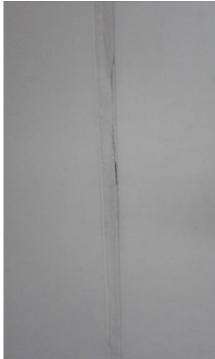
Figura 5.18 - Fissura em junta de dilatação - CS Oeiras (Fonte: Autor)
