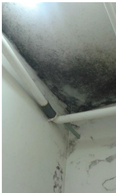
Figura 5.9 - Humidade por infiltração no teto de uma cave - UCSP St Condestável (Fonte: Autor)
