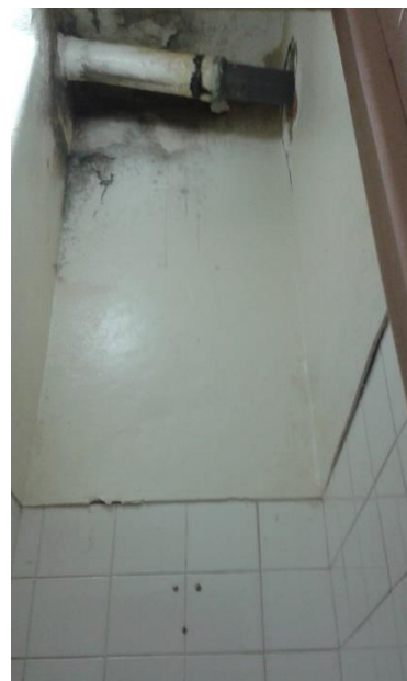
Figura 5.10 - Humidade por infiltração no teto de uma cave - UCSP St Condestável (Fonte: Autor)
