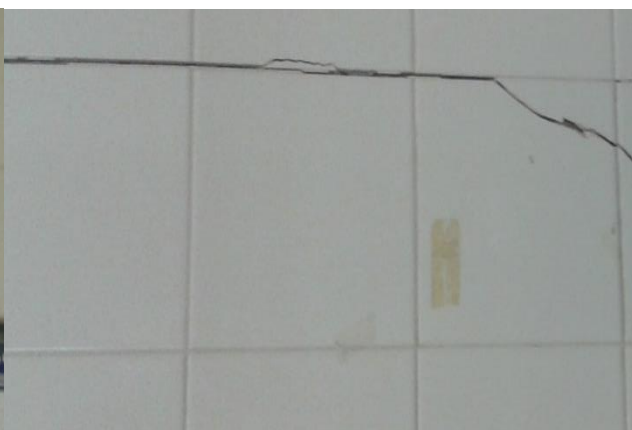
Figura 5.17 - Fissura em revestimento cerâmico - UCSP Lapa (Fonte: Autor)
