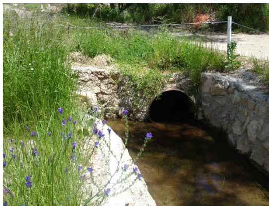
Figura 56 – Pormenor da restituição das águas
