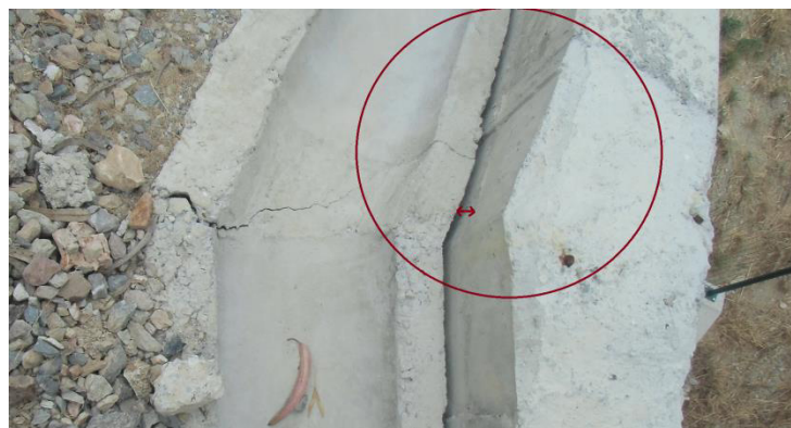
Figura 77 – Ligeiro assentamento da drenagem
