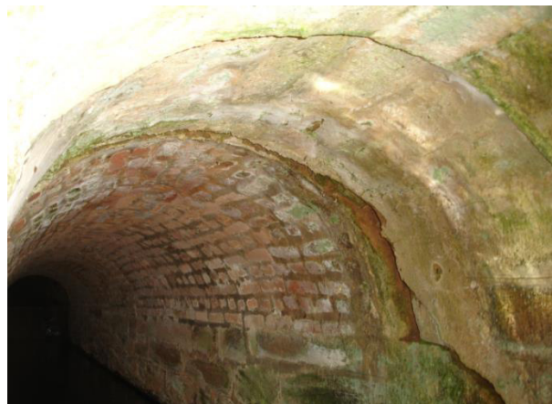
Figura 53 – Danos na PH ao km 236+680 [figura cedida pelo departamento de Geotecnia da REFER Engineering]
