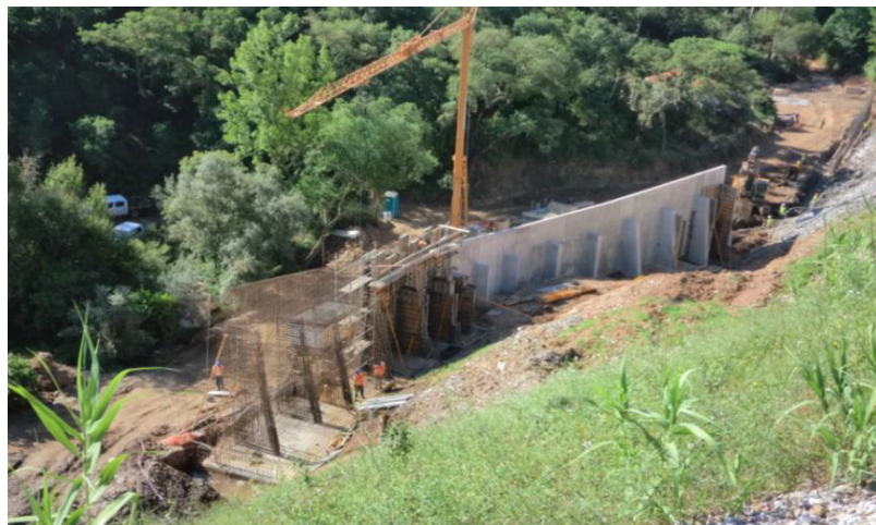
Figura 47 – Muro com contrafortes [figura cedida pelo departamento de Geotecnia da REFER Engineering]
