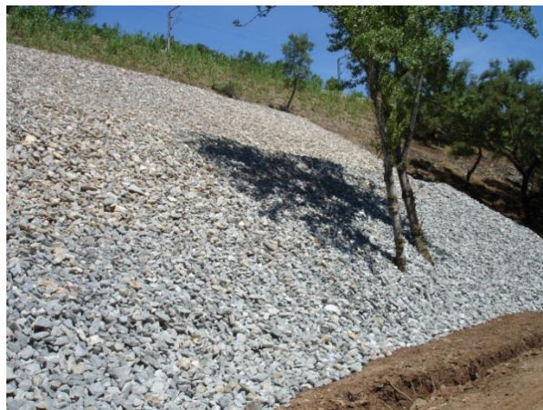
Figura 46 – Colocação de enrocamento [figura cedida pelo departamento de Geotecnia da REFER Engineering]
