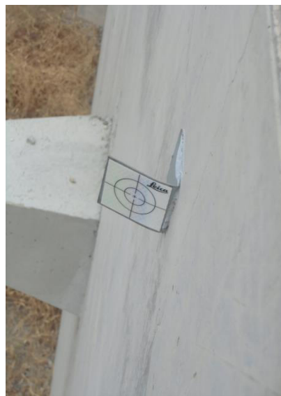
Figura 60 – Alvo topográfico num muro de suporte
