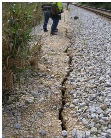
Figura 39 - Fenda no passeio do lado esquerdo da via [figura cedida pelo departamento de Geotecnia da REFER Engineering]
