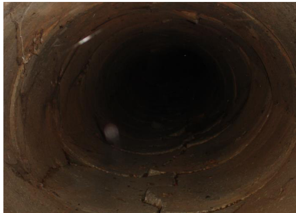
Figura 52 – Danos na PH ao km 236+480 [figura cedida pelo departamento de Geotecnia da REFER Engineering]
