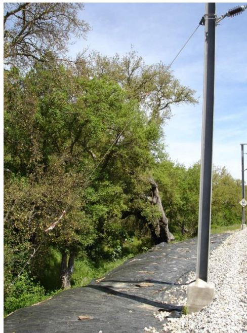
Figura 40 – Espiamento do poste de catenária [figura cedida pelo departamento de Geotecnia da REFER Engineering]
