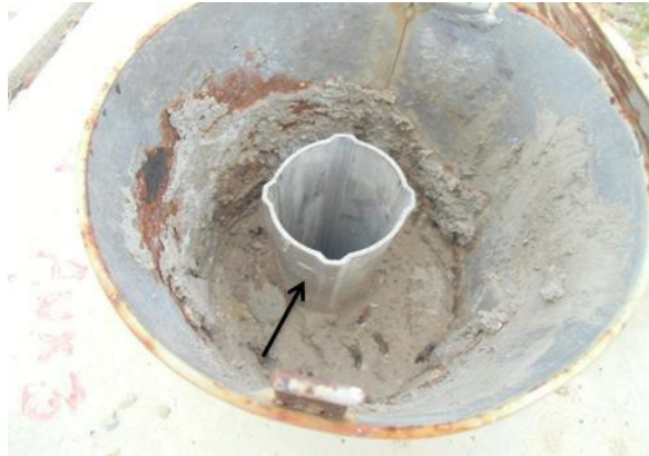
Figura 5 – Tubo inclinométrico em alumínio
