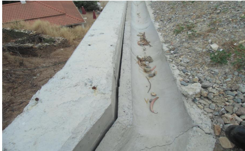
Figura 78 – Deslocamento entre a drenagem e o muro de suporte
