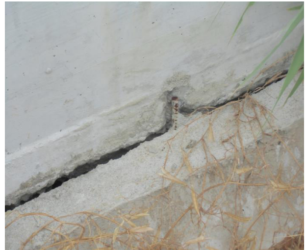
Figura 75 – Crescimento de vegetação na folga entre a parede e a drenagem
