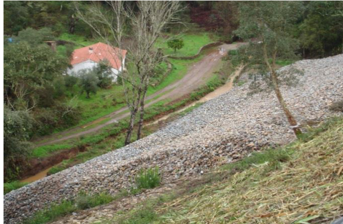
Figura 42 – Colocação de enrocamento [figura cedida pelo departamento de Geotecnia da REFER Engineering]
