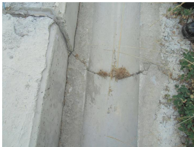
Figura 79 – Fenda na drenagem
