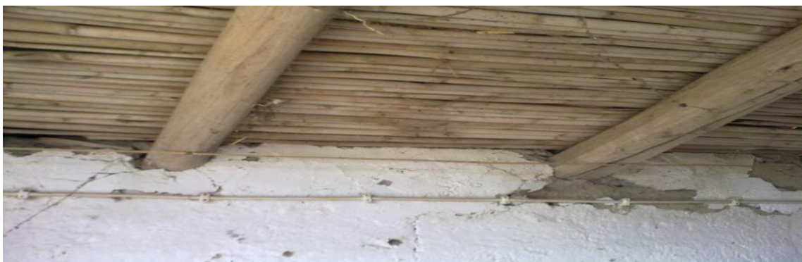
Figura 18 - Apodrecimento das vigas de madeira e destacamento do reboco (A2)
