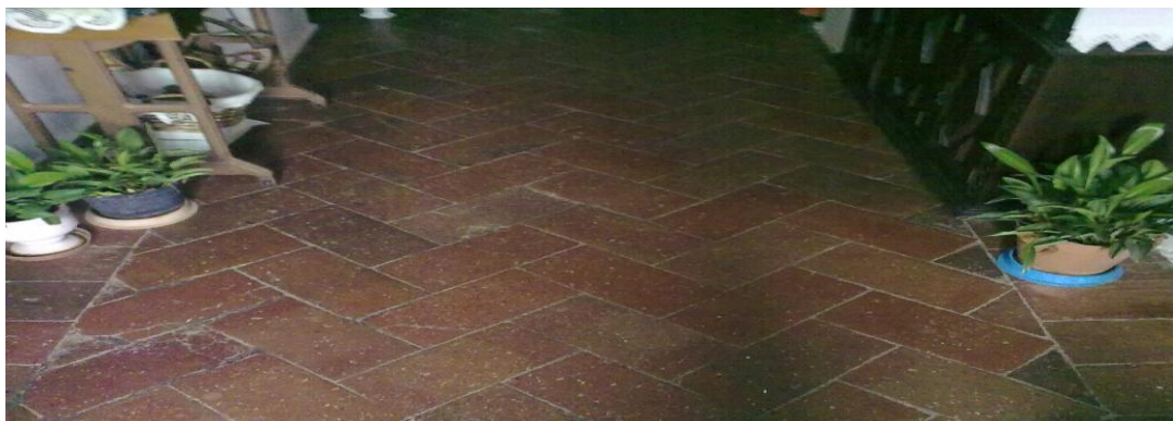
Figura 17 - Desgaste do pavimento cerâmico ( CORR )
