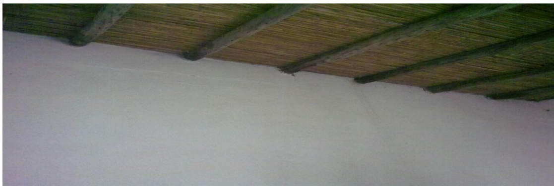
Figura 20 - Escorrência de água no interior do edifício de habitação (AI)
