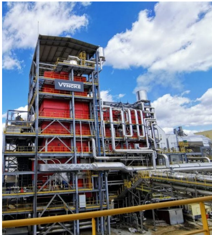
Figura 4.18 - Caldeira de cogeração Vyncke.
