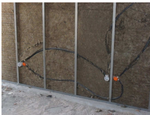
Figura 3.75 - Colocação dos equipamentos da rede eléctrica e da lã de rocha no interior das paredes
