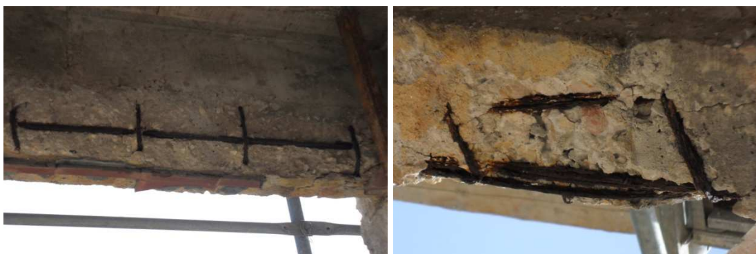
Figura 3.10 - Armaduras das vigas de bordadura corroídas
