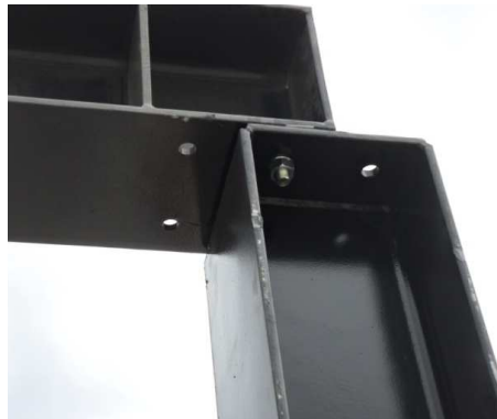
Figura 3.88 - Desvio da viga relativamente ao pilar
