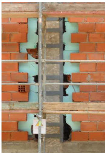
Figura 3.67 - Parede com alvenarias por fechar junto aos pilares onde não estavam aplicados reforços
