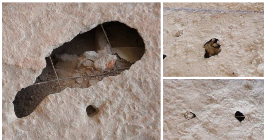
Figura 3.13 - Abobadilhas perfuradas devido à remoção do pavimento
