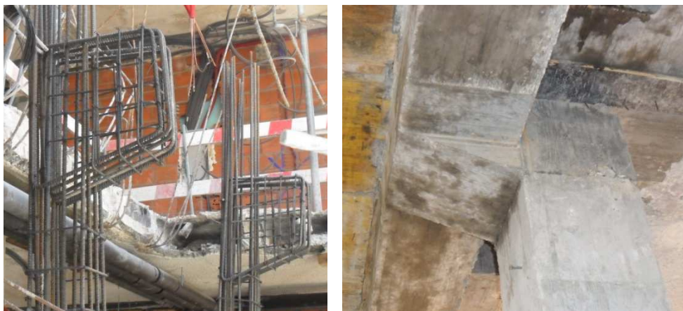
Figura 3.57 - Cachorro para desviar a viga e permitir a passagem da conduta de desenfumagem
