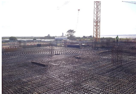
Figura 2.34 - Armação e aplicação das armaduras laje piso 0, Praia do Sal Wellness Resort .
