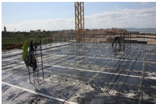
Figura 2.37 - Armação e aplicação das armaduras lote E, piso 0, Praia do Sal Wellness Resort .
