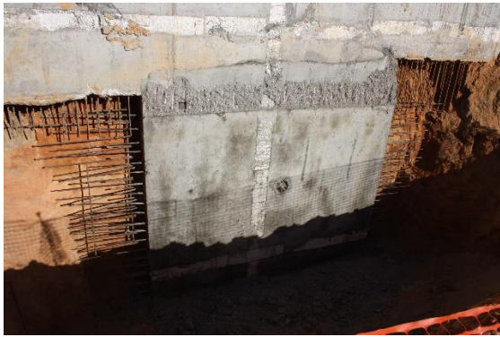
Figura 4.16 - Painel de contenção primário.
