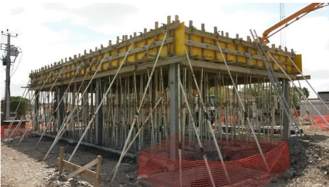
Imagem 32 - Vista geral do EC após betonagem de vigas e laje de cobertura
