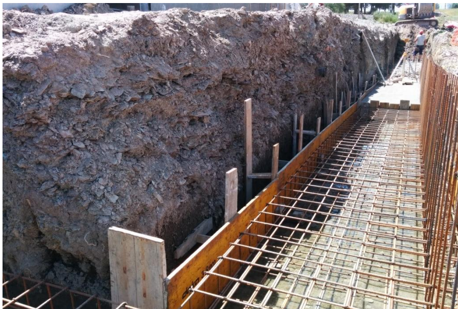
Imagem 75 - Execução de muro com altura não correspondente ao definido em projeto
