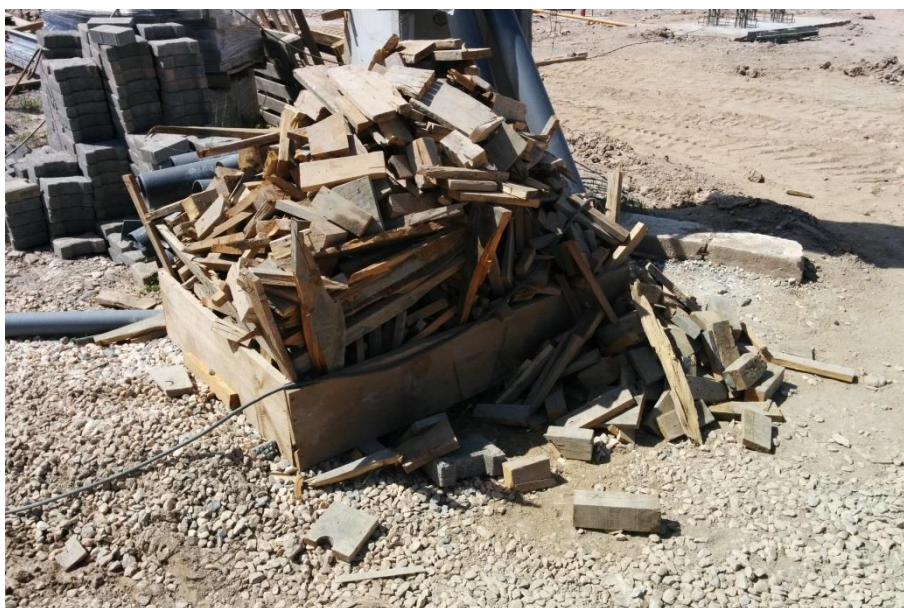
Imagem 82 - Mau acondicionamento de material sobranente
