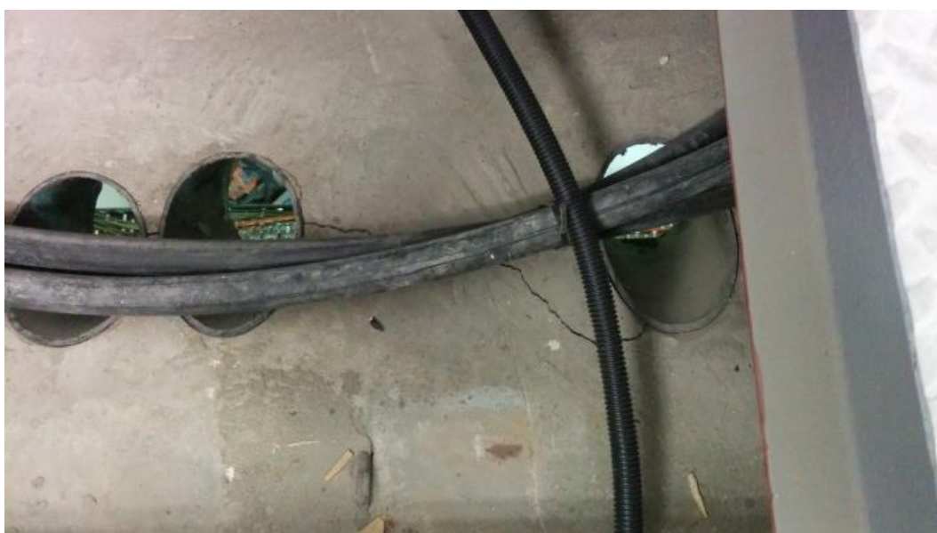
Imagem 71 - Fissuras devido a furações na laje intermédia
