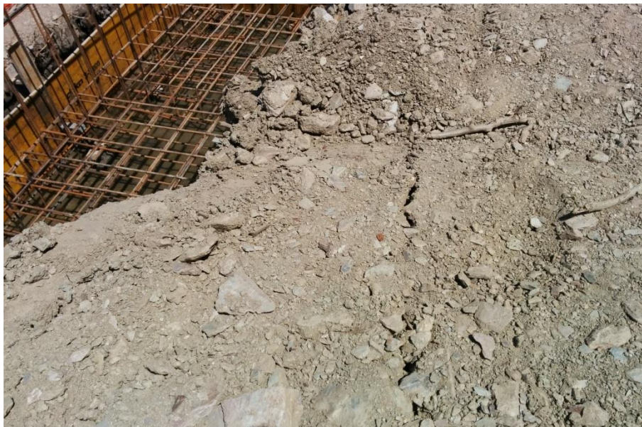
Imagem 81 - Zona periférica de escavação não delimitada e com sinais de rotura
