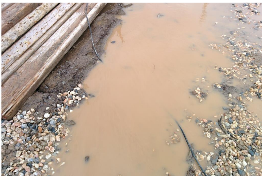
Imagem 78 - Cabo elétrico imerso em zona com acumulação de água
