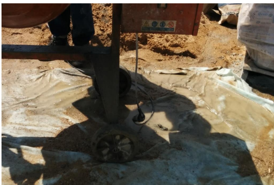
Imagem 79 - Cabo elétrico de betoneira em zona com água
