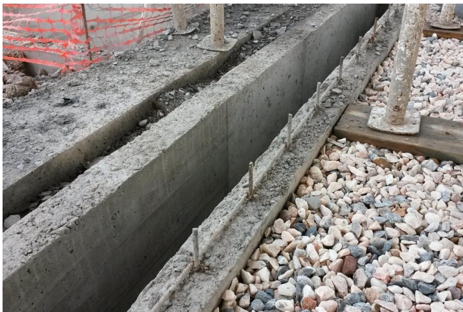
Imagem 77 - Zona de caleira não delimitada com pontas de armadura expostas
