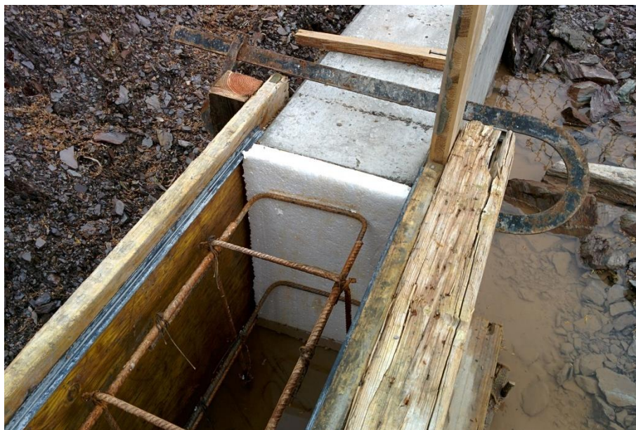
Imagem 74 - Recobrimento não respeitado
