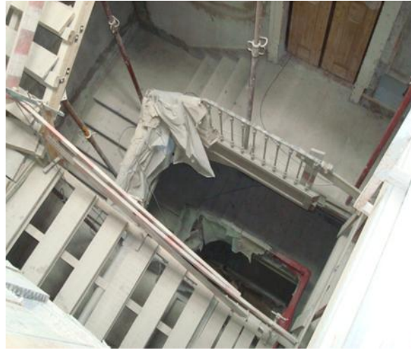
Figura 3.14. Introdução de elevadores na bomba das escadas, na Rua dos Duques de Bragança, n.º 5-A a 5-M
