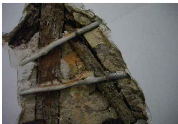
Figura 3.1. Tubagem de água na parede de frontal, com cruz de S. to André, na Rua Ivens, n.º 52 a 64
