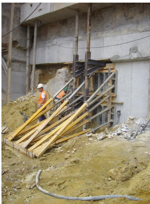
Figura 4.9. Esquadros em perfis nas micro-estacas de suporte dos painéis em betão, tipo muro de Berlim, na Rua Ivens, n.º 21 a 33 e Largo da Boa Hora, n.º 1-A
