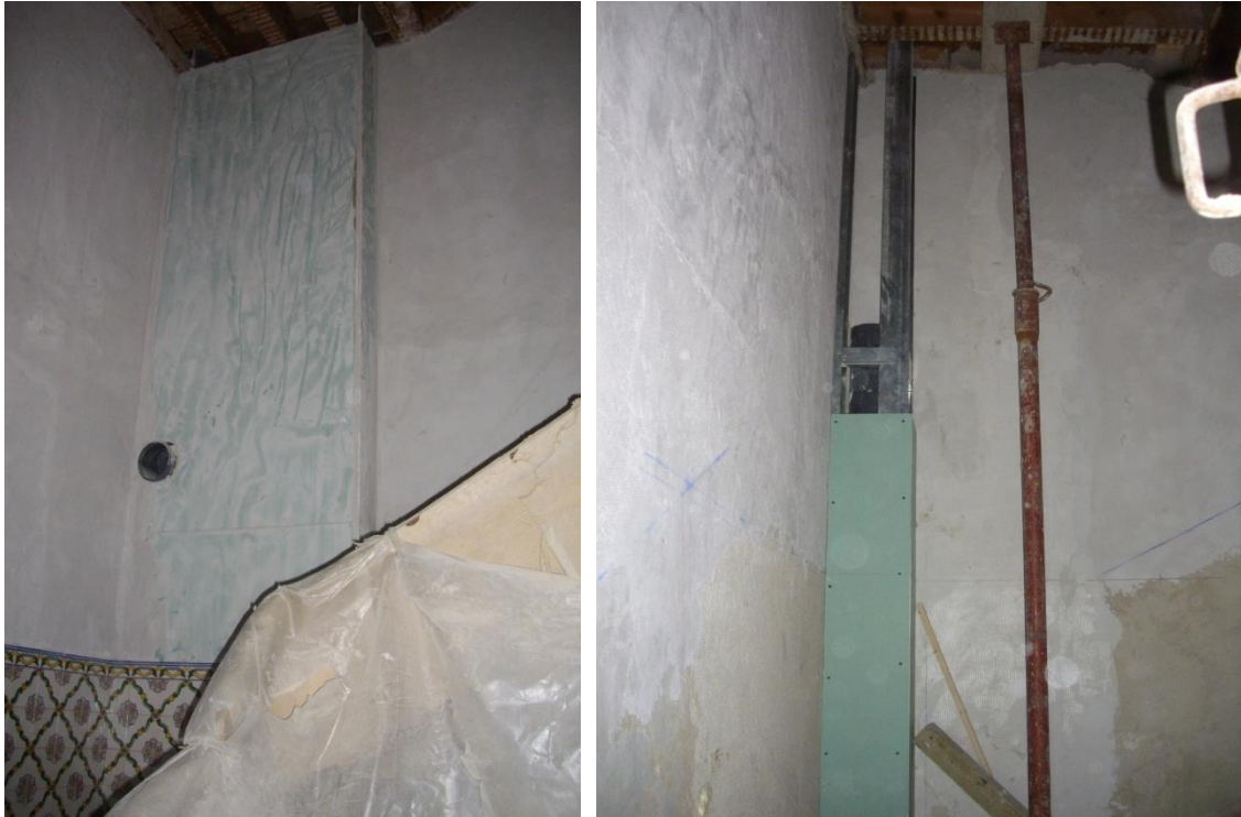
Figura 3.4. "Courettes" para passagem de redes de águas e de esgotos na zona da caixa de escadas, na Rua dos Duques de Bragança, n.º 5-A a 5-M
