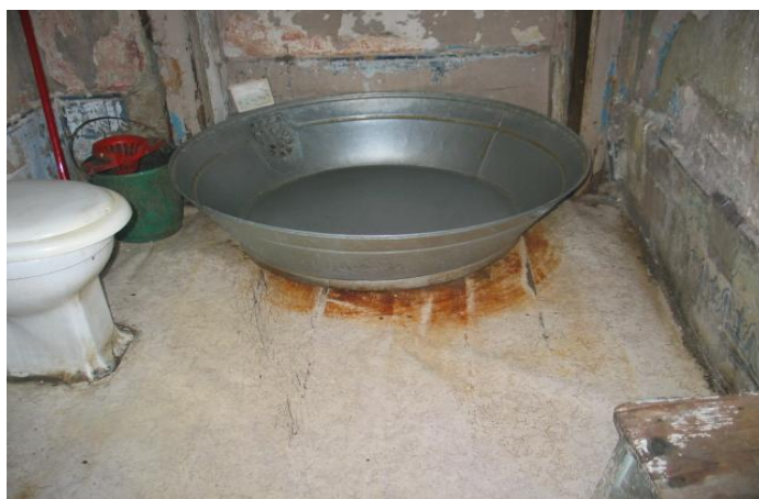
Figura 2.7. Instalações sanitárias, muito precárias, na Rua dos Fanqueiros, n.º 265
