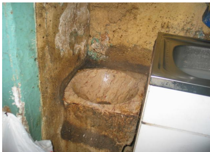
Figura 2.6. Cozinha com pia de despejo, com aspecto muito insalubre, na Rua dos Fanqueiros, n.º 265
