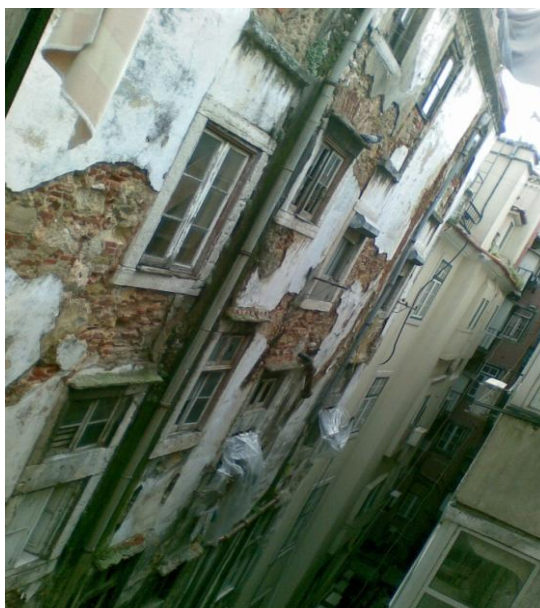
Figura 2.1. Degradação da fachada na Rua dos Fanqueiros, n.º 265
