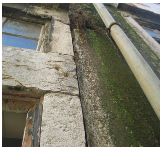
Figura 2.2. Rotura em tubo de queda de águas pluviais na Rua dos Fanqueiros, n.º 265
