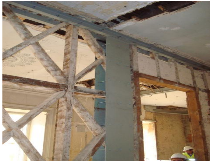
Figura 3.11. Reforço da estrutura com perfis e chapas aparafusados, na Rua Ivens, n.º 52 a 64
