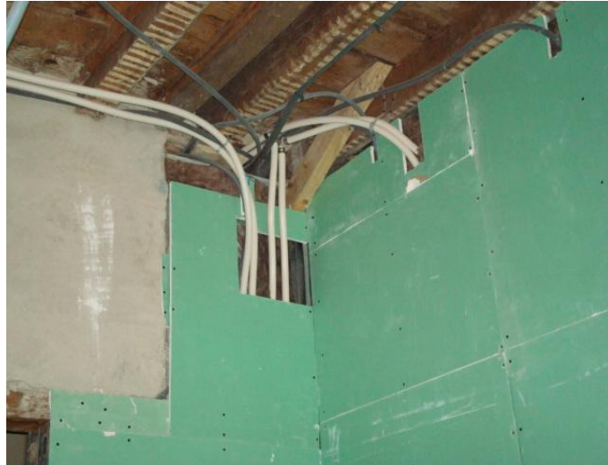
Figura 3.13. Paredes de compartimentação em gesso cartonado, na Rua dos Duques de Bragança, n.º 5-A a 5-M
