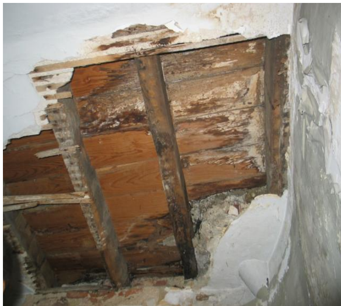
Figura 2.5. Pavimentos com forro do tecto aluído, com fasquiado à vista e elementos de madeira apodrecida, na Rua dos Fanqueiros, n.º 265
