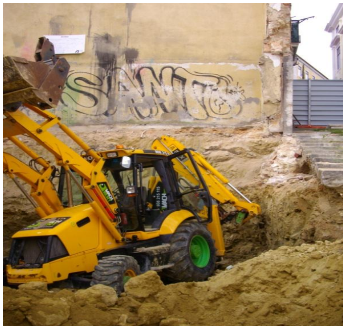
Figura 4.5. Escavação sem estrutura de suporte, na Rua Oliveira ao Carmo, n.º 81
