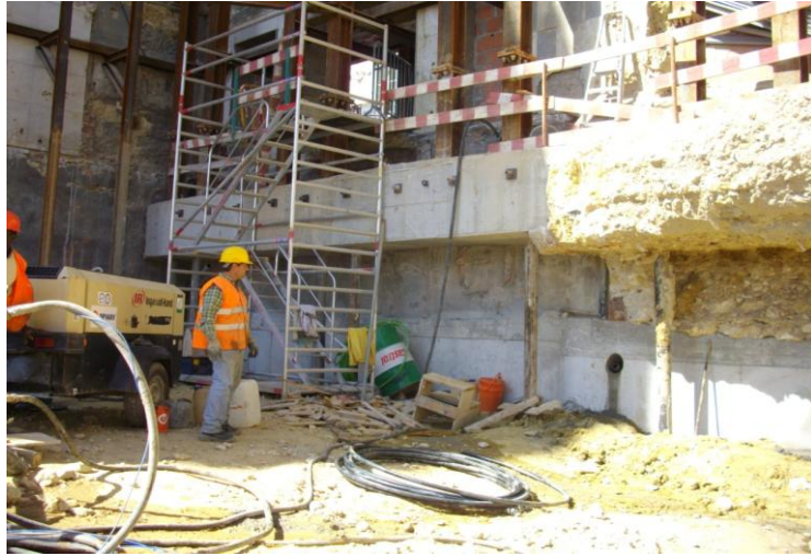
Figura 4.13. Fundação precária com recalce nas vigas de encabeçamento na Rua Ivens, n.º 21 a 33
