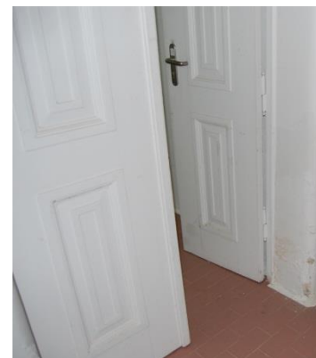
Figura 2.3.53. Porta de duas folhas, em considerável bom estado, no Piso -1 [Fonte: Autora, Data: 23-06-2016]
