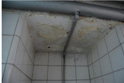
Figura 3.7.3. Manifestação de Cripto-florescências no teto duma I.S. no Piso 0, onde há passagem de tubagem para distribuição de água [Fonte: Autora, Data: 19-05-2016]
