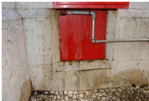
Figura 3.2.5. Rutura da canalização, provocando manchas de humidade na pedra [Fonte: Autora, Data: 01-09-2016]
