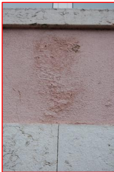
Figura 3.1.11. Empolamentos da pintura (cripto-florescências) [Fonte: Autora, Data: 03-02-2017]
