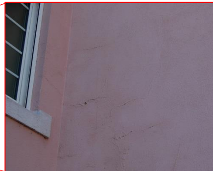
Figura 3.1.2. Pormenorização das fissuras superficiais no acabamento sem orientação definida [Fonte: Autora, Data: 18-05-2016]
