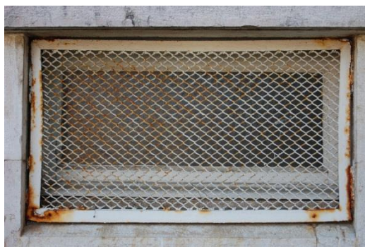
Figura 3.3.2. Aparecimento de manchas acastanhadas (ferrugem) nas grades duma janela da cave, na fachada lateral poente [Fonte: Autora, Data: 18-05-2016]
