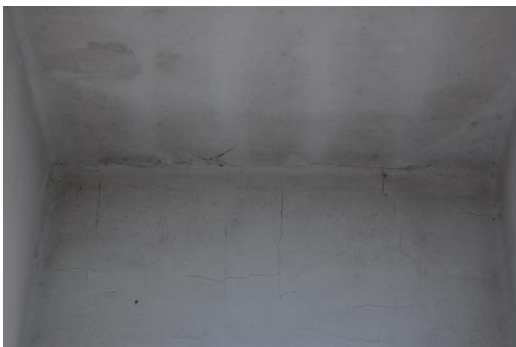
Figura 3.7.4. Manchas escuras no revestimento do teto da I.S. [Fonte: Autora, Data: 25-05-2016]
