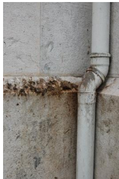
Figura 3.2.14. Deposição de guanos na fachada lateral nascente [Fonte: Autora, Data: 03-02-2017]
