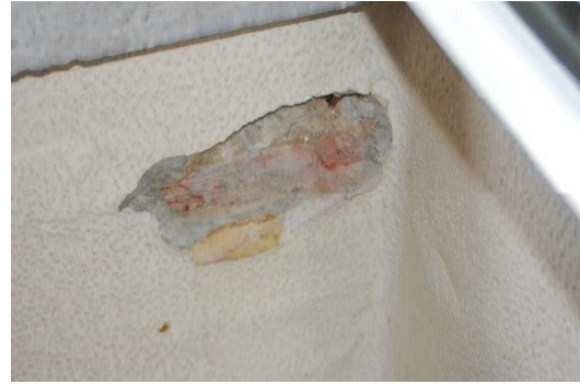
Figura 3.5.4. Destacamento do reboco, sob o peitoril, com alvenaria mista de tijolo à vista [Fonte: Autora, Data: 25-05-2016]
