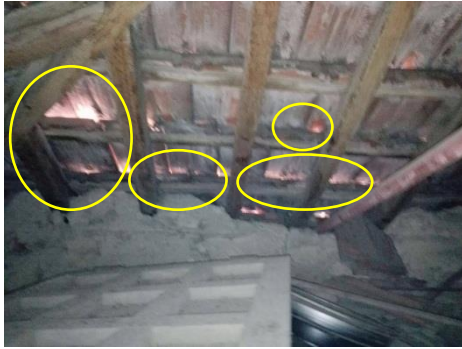
Figura 3.4.1. Entrada de pontos de luz, indicativo de deslocação ou fracturação das telhas [Fonte: Autora, Data: 23-06-2016]
