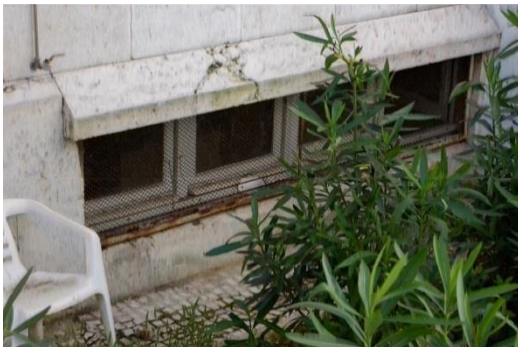
Figura 3.2.6. Pormenorização da patologia sobre a verga do vão das janelas da cave [Fonte: Autora, Data:31-05-2016]
