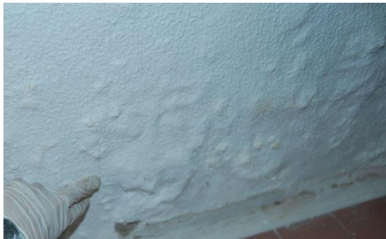
Figura 3.8.1. Desenvolvimento de bolhas na base das paredes enterradas [Fonte: Autora, Data: 23-06-2016]
