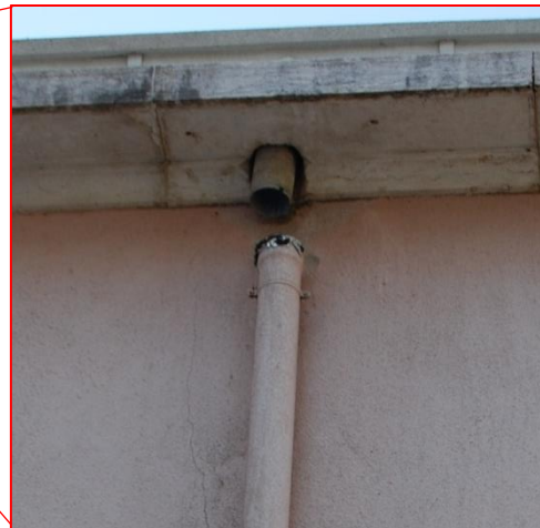
Figura 3.10.6. Tubo de queda separado do bocal [Fonte: Autora, Data: 01-09-2016]
