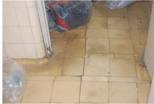
Figura 3.6.3. Empolamento do revestimento do pavimento, numa I.S. (nº28) no 1ºAndar [Fonte: Autora, Data: 25-05-2016]
