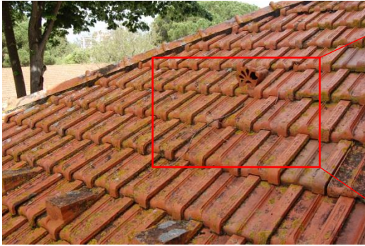
Figura 3.4.4. Manchas de tom esverdeado e esverdeado escuro, em praticamente todas as telhas cerâmicas [Fonte: Autora, Data: 25-05-2016]
