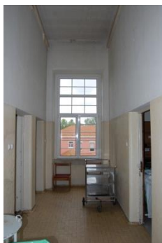
Figura 2.3.33. Revestimento da Parede interior na circulação da Ala Poente, no Piso 1 [Fonte: Autora, Data: 25-05-2016]
