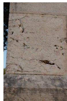
Figura 3.2.2. Formação de concavidades provocadas pela perda de material [Fonte: Autora, Data: 01-09-2016]
