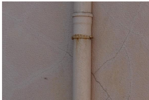
Figura 3.10.7. Corrosão da abraçadeira [Fonte: Autora, Data: 31-05-2016]
