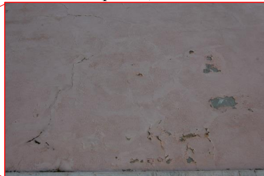
Figura 3.1.15. Destacamento da pintura [Fonte: Autora, Data: 01-08-2016]
