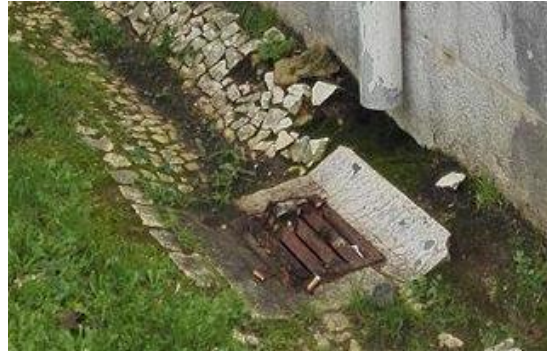
Figura 3.10.4. Sarjeta entupida [Fonte: Autora, Data: 03-02-2017]
