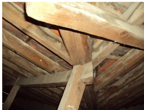
Figura 3.4.3. Alteração da cor da estrutura de madeira, devido a infiltrações que progridem devido a fenómenos de degradação [Fonte: Autora, Data: 22/07/2017]
