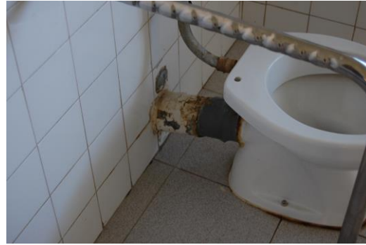
Figura 3.10.2. Incrustações e Corrosão dos elementos metálicos na rede de águas residuais [Fonte: Autora, Data: 19-05-2016]
