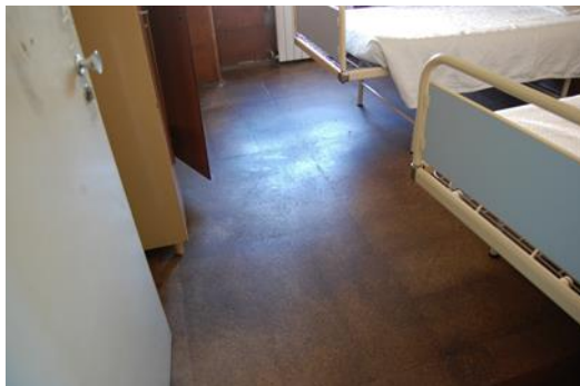
Figura 3.6.4. Desgaste superficial do pavimento em cortiça e alteração de cor, Quarto nº 27, 1ºAndar [Fonte: Autora, Data: 20-05-2016]
