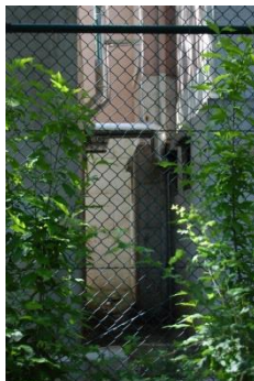
Figura 2.3.2. Pormenorização da rede de proteção [Fonte: Autora, Data: 31-05-2016]
