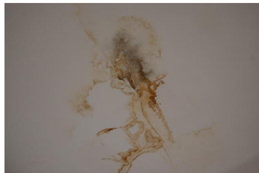
Figura 3.7.5. Manchas alaranjadas, indicativas da corrosão de elementos metálicos. [Fonte: Autora, Data: 25-05-2016]
