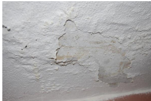
Figura 3.8.2. Destacamento do revestimento [Fonte: Autora, Data: 23-06-2016]
