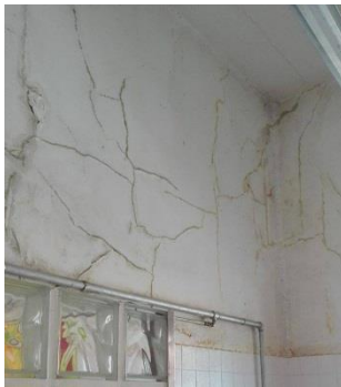
Figura 3.5.1. Fissuras aleatórias numa parede divisória dum I.S. no RC [Fonte: Autora, Data: 23-06-2016]
