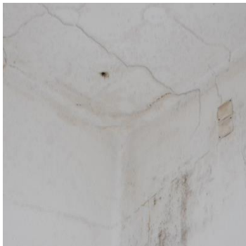
Figura 3.7.1. Fissuras na ligação teto-parede [Fonte: Autora, Data:25-05-2016]
