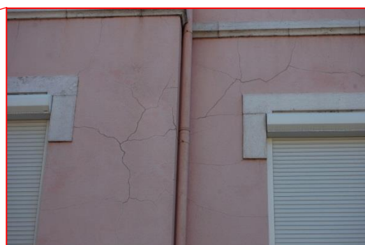
Figura 3.1.4. Pormenorização da fissura no revestimento com orientação irregular, junto dos tubos de queda [Fonte: Autora, Data: 18-05-2016]
