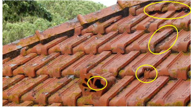
Figura 3.4.2. Telhas partidas e deslocadas e a telha de ventilação encontra-se danificada [Fonte: Autora, Data: 25-05-2016]
