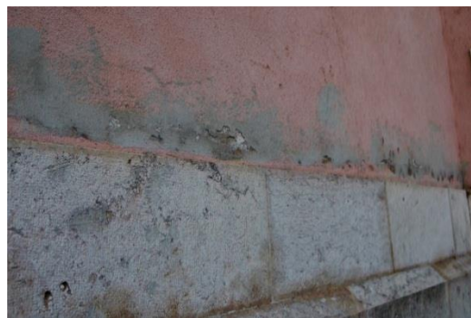
Figura 2.4.1. Reparação de fissuras não estruturais, ao longo do comprimento da Fachada lateral nascente [Fonte: Autora, Data: 01-09-2016]
