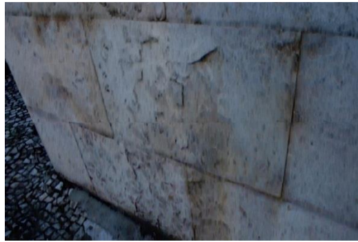
Figura 3.2.8. Escamação do revestimento de pedra [Fonte: Autora, Data:18-05-2016]
