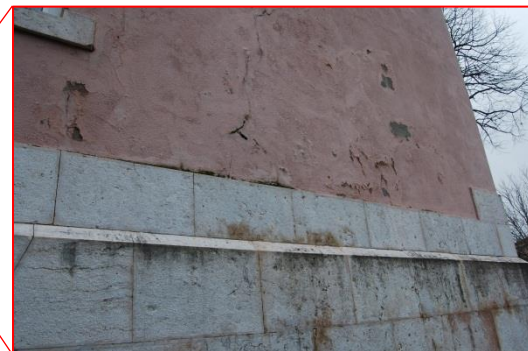
Figura 3.1.13. Deposição de sais no interior da pintura [Fonte: Autora, Data: 3-2-2017]
