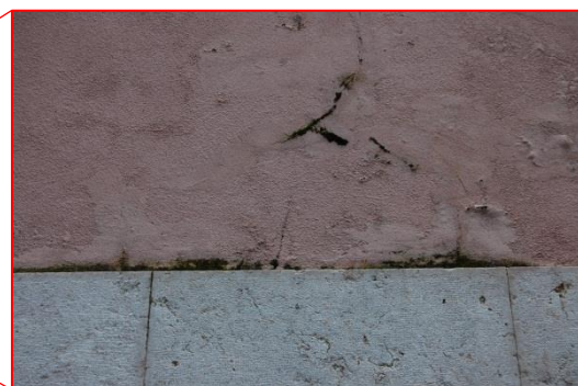
Figura 3.1.6. Vegetação no revestimento, localizada na fachada posterior, sob o vão da janela [Fonte: Autora, Data: 3-2-2017]
