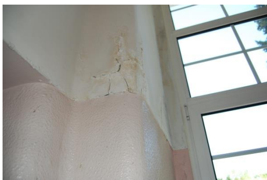
Figura 3.5.5. Aparecimento de cripto-eflorescências, junto do vão de uma janela, no RC [Fonte: Autora, Data: 19-05-2016]
