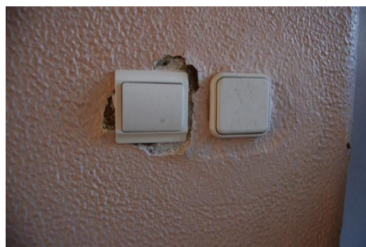
Figura 3.5.6. Aparecimento de cripto-eflorescências e eflorescências junto dos interruptores numa parede divisória [Fonte: Autora, Data: 19-05-2016]
