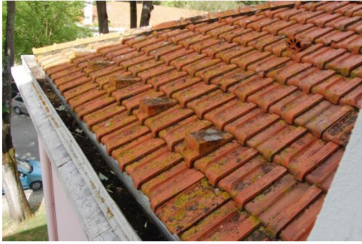
Figura 3.10.3. Entulho no algeroz, obstruindo o adequado escoamento das águas pluviais [Fonte: Autora, Data: 25-05-2016]
