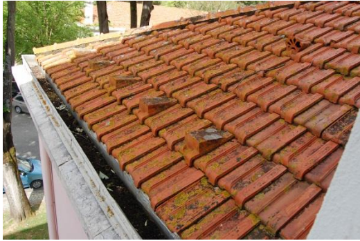
Figura 2.3.27. Revestimento cerâmico da cobertura, telhas de marselha – algeroz com entulho [Fonte: Autora, Data: 30-05-2016]
