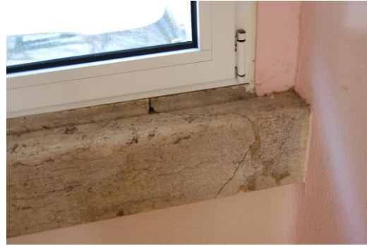
Figura 3.9.2. Fissura no peitoril, pelo interior [Fonte: Autora, Data: 19-05-2016]
