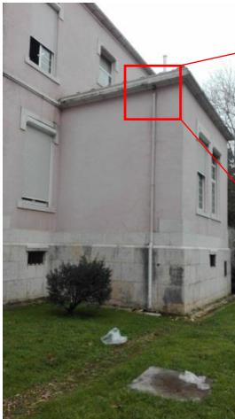
Figura 3.10.5. Tubo de queda separado do bocal (ausência de funil) [Fonte: Autora, Data: 03-02-2017]
