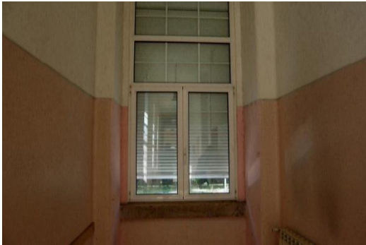
Figura 2.3.35. Revestimento da Parede interior na circulação da Ala Nascente, no Piso 0 [Fonte: Autora, Data: 19-05-2016]
