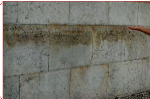
Figura 3.2.4. Manchas de humidade junto ao tubo de queda [Fonte: Autora, Data: 01-09-2016]
