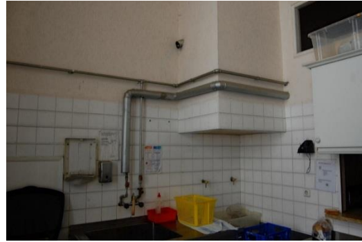
Figura 2.3.45. Tubagem em aço galvanizado, na no Refeitório no Piso 0 [Fonte: Autora, Data: 19-05-2016]
