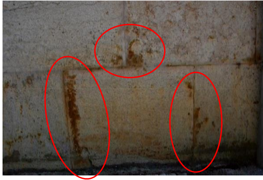
Figura 3.2.15. Aparecimento de manchas de tom alaranjados nas imediações das juntas [Fonte: Autora, Data:
