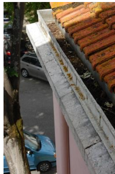
Figura 3.4.6. Deposição de detritos (folhas, terras e sujidades) provocando o entupimento do algeroz [Fonte: Autora, Data: 25-05-2016]
