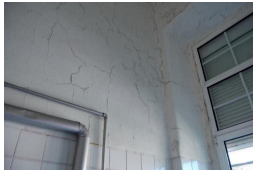
Figura 3.5.2. Fissuração aleatória numa parede de I.S. no R/C [Fonte: Autora, Data: 19-05-2016]
