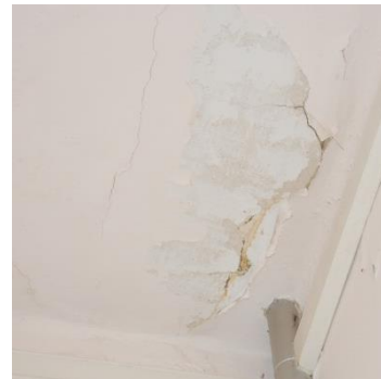
Figura 3.7.2. Destacamento do acabamento (pintura) e fissuração no reboco, no piso superior está localizada uma instalação sanitária [Fonte: Autora, Data: 19-05-2016]
