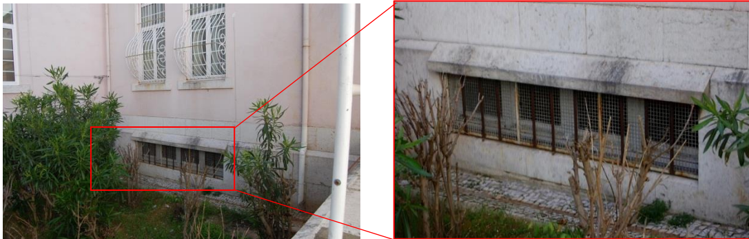
Figura 3.3.1. Gradeamento das Janelas da Cave em ferro, na fachada posterior [Fonte: Autora, Data: 31-05-2016]
