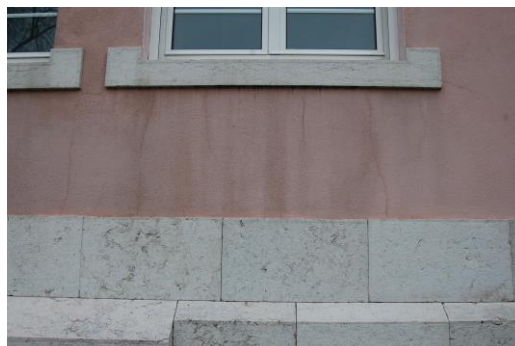
Figura 3.1.16. Manchas de humidade sob os vãos de janela [Fonte: Autora, Data: 03-02-2017]
