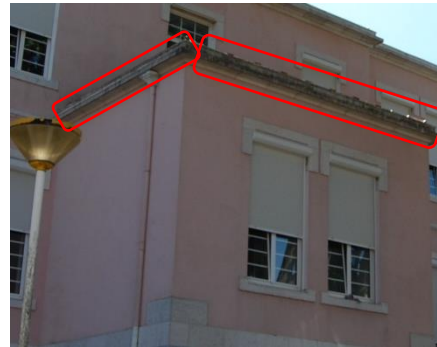
Figura 3.2.11. Crosta negra nos elementos da cornija, na Fachada Lateral poente [Fonte: Autora, Data: 18-05-2016]
