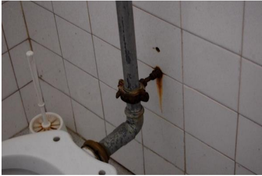
Figura 3.10.1. Corrosão dos elementos metálicos de fixação da tubagem (abraçadeira), na Rede de Abastecimento [Fonte: Autora, Data: 19-05-2016]
