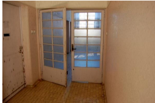
Figura 2.3.36. Revestimento da Parede interior na circulação da Ala Poente, no Piso 0 [Fonte: Autora, Data: 19-05-2016]
