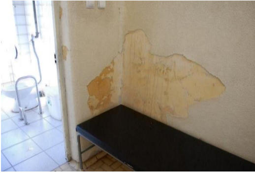
Figura 3.5.3. Destacamento do revestimento das paredes interiores junto a uma instalação sanitária [Fonte: Autora, Data: 25-05-2016]
