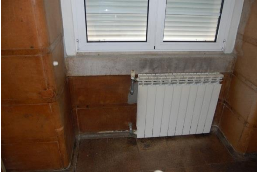
Figura 3.9.1. Manchas escuras no peitoril interior, sobre o radiador de aquecimento central [Fonte: Autora, Data: 20-05-2016]
