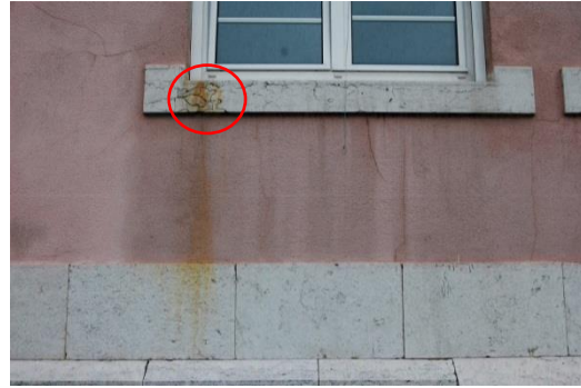
Figura 3.2.16. Aparecimento de mancha de tom alaranjada no peitoril exterior [Fonte: Autora, Data: 03-02-2017]
