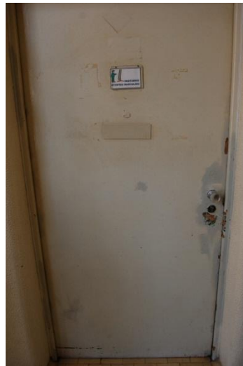
Figura 3.9.4. Porta com alguns remendos, Quarto nº42, Piso 1 [Fonte: Autora, Data: 30-05-2016]
