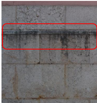
Figura 3.2.10. Crosta negra nos elementos de cantaria [Fonte: Autora, Data:
