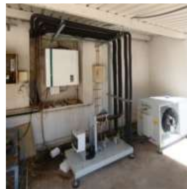
Unidade de condensação
