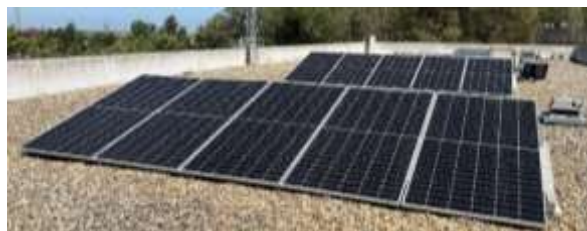
Painéis solares fotovoltaicos
