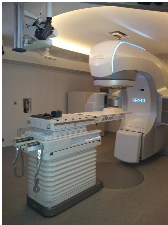
Figura 4.1.1- Varian EDGE, da Fundação Champalimaud, Lisboa.
