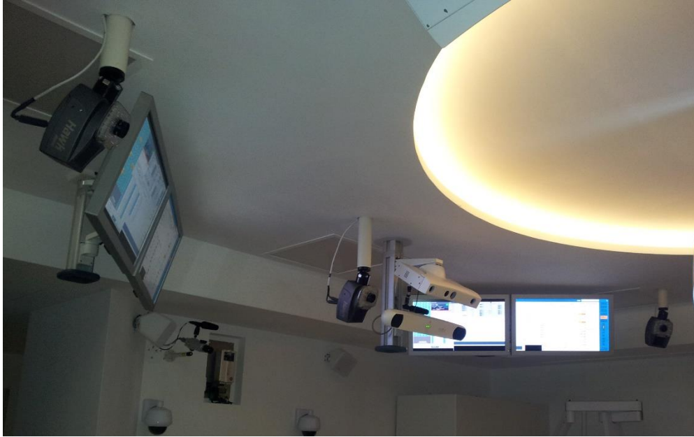
Figura 4.1.3- Conjunto de câmaras de controlo para o sistema OSMS, Fundação Champalimaud.
