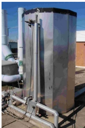
Figura 2.15. Tanque de armazenamento de energia
