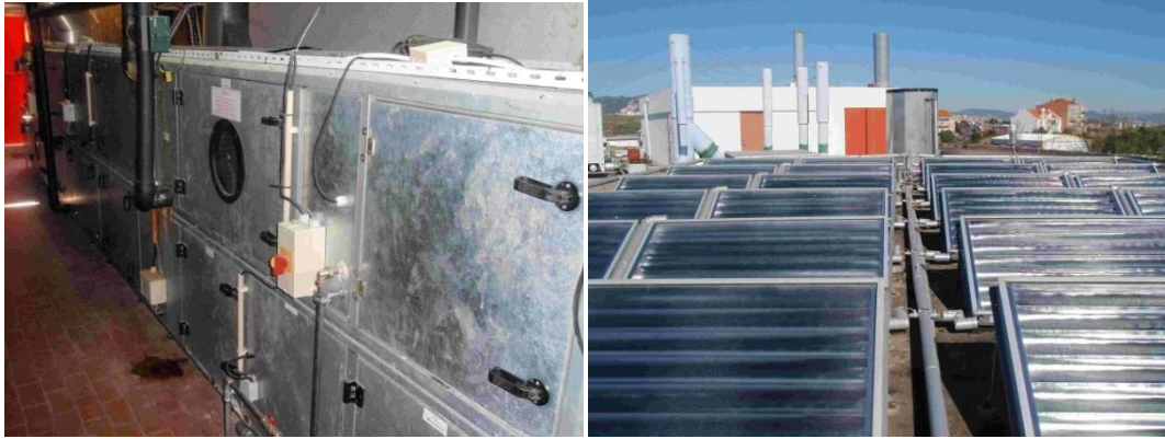
Figura 2.1. Unidade de Tratamento de Ar e campo de colectores solares térmicos
