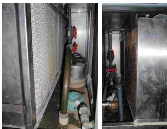
Figura 2.18. Humidificador na conduta de insuflação e na conduta de extracção
