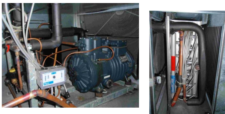
Figura 2.19. Máquina Frigorífica (Bomba de calor)
