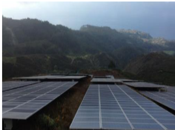
Figura 20 - Parque fotovoltaico do Loiral
