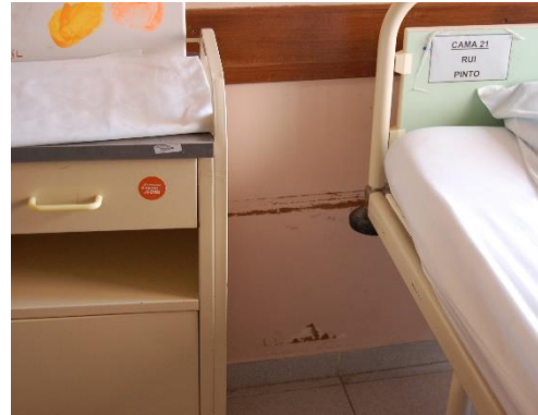
Figura 24 - Abrasão da parede
