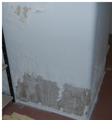
Figura 27 - Humidade ascendente do terreno
