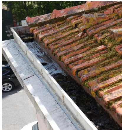
Figura 37 - Acumulação de resíduos na caleira
