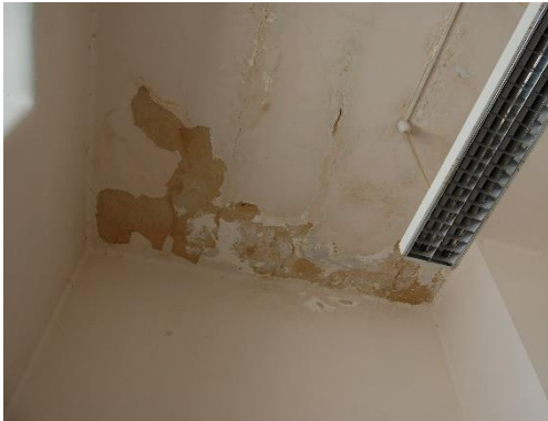
Figura 28 - Degradação do teto
