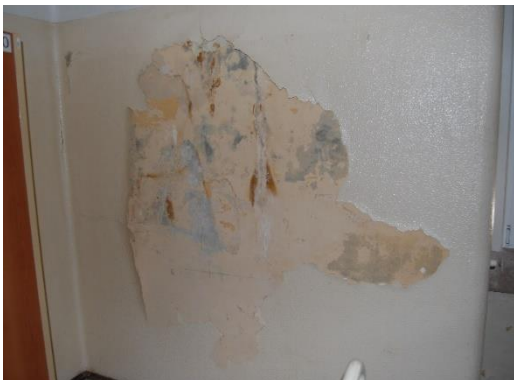
Figura 25 - Destacamento da pintura
