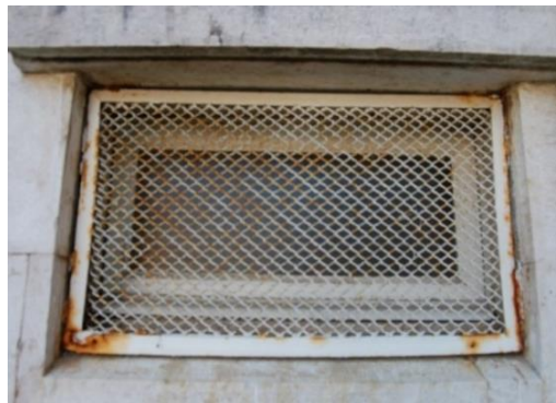
Figura 8 - Oxidação das grades
