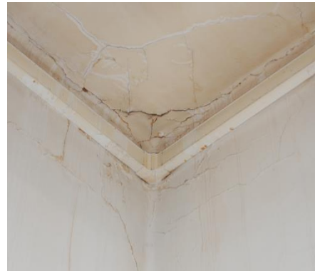
Figura 29 - Fendas no teto
