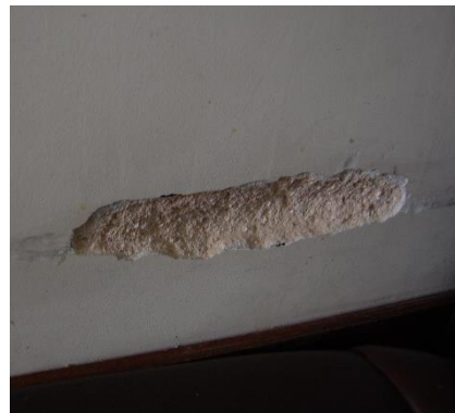
Figura 26 - Destacamento do reboco
