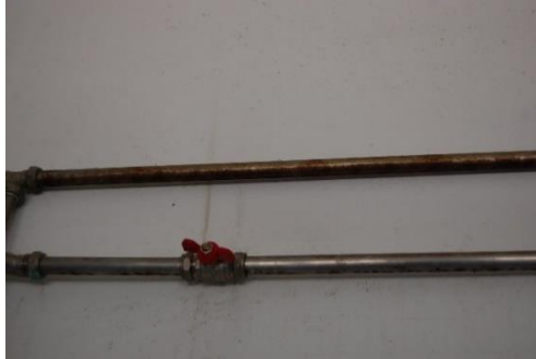
Figura 36 - Oxidação da canalização
