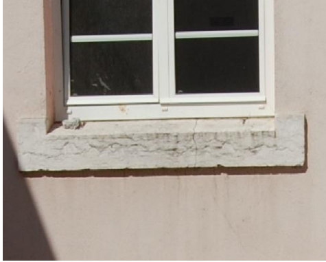
Figura 15 - Fissuração do peitoril
