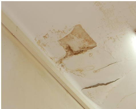
Figura 30 - Destacamento da pintura
