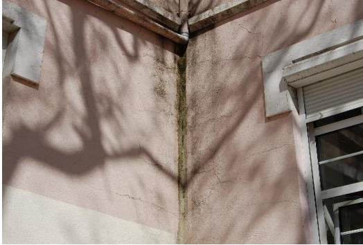
Figura 10 - Colonização biológica na fachada
