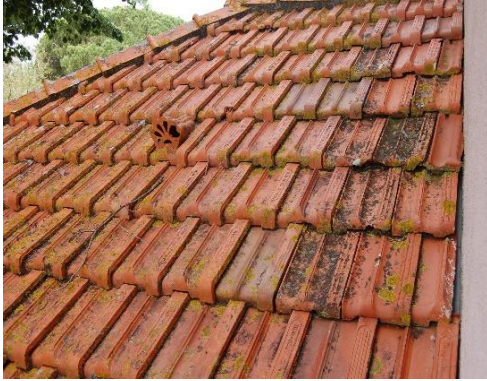
Figura 6 - Telhas partidas e fissuradas
