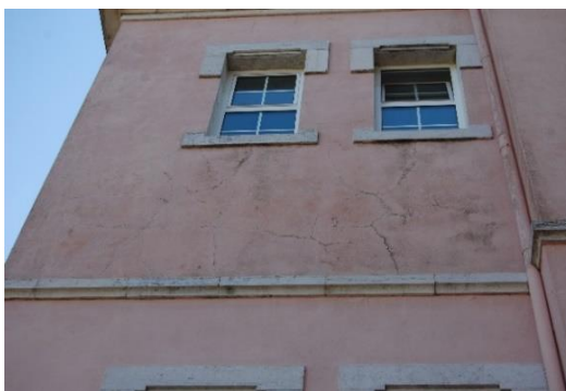
Figura 9 - Fendas no reboco
