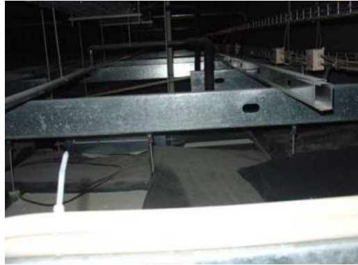
Figura III:41 - Vista do pleno de tecto falso, acima do espaço ocupado, onde se destaca a desordem generalizada da localização dos sacos de isolamento térmico das placas metálicas.
