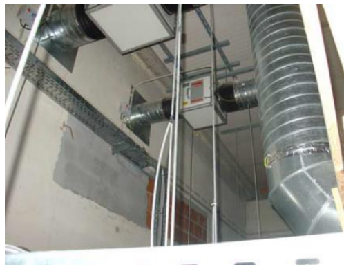
Figura III:35 - Vista de um dos ventiladores de extração de ar ambiente.
