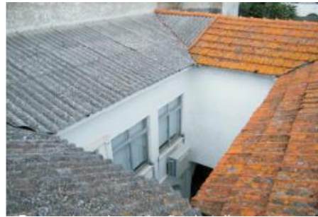
Figura III:17 – Cobertura da zona D onde apresenta chapas de fibrocimento em duas das águas
