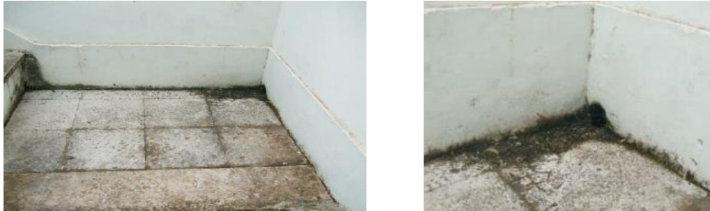
Figura III:10 – Zona de conflitos de águas, falta de proteção dos ralos de escoamento
