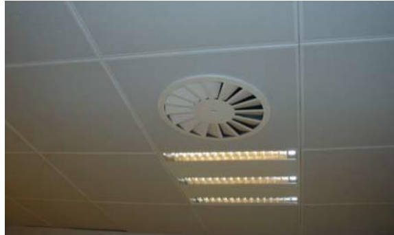
Figura III:36 - Um dos difusores rotativos de tecto, para introdução de ar novo no ambiente interior do edifício.
