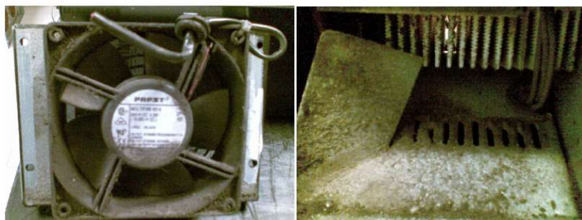
Figura 2.2.3- Esquerda (Unidades de ventilação em mau estado), Direita (Dissipadores dos módulos de potência com canais entupidos) [9]
