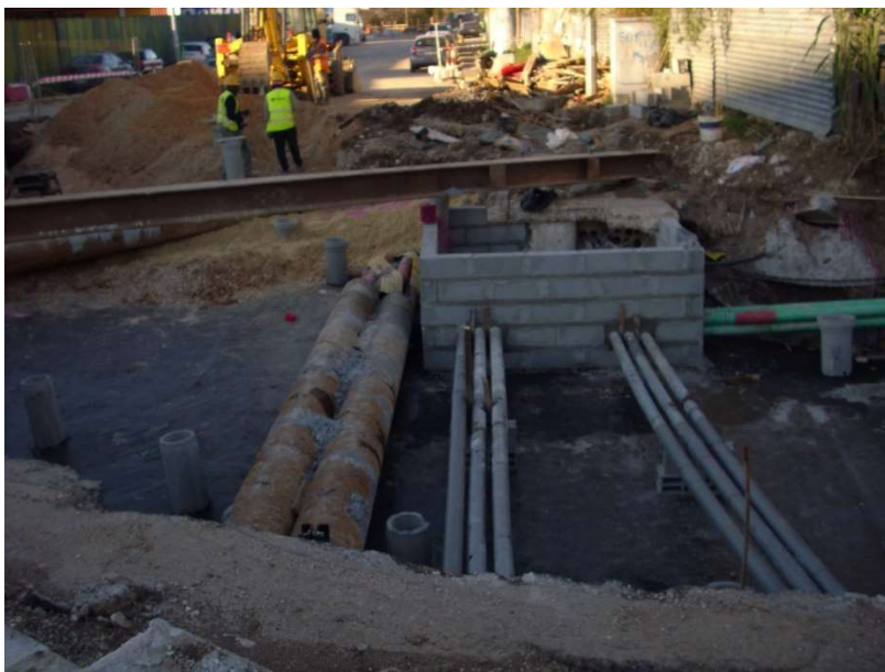
Fig. 54 Caixa de Telecomunicações
