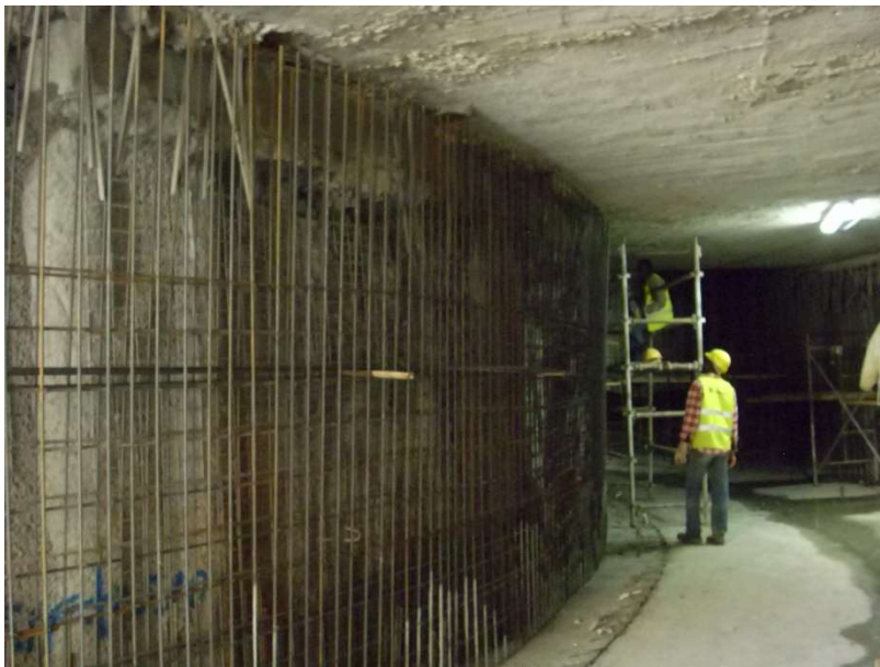
Fig. 37 Execução da armadura na parede interior do canal (após execução do betão projetado)
