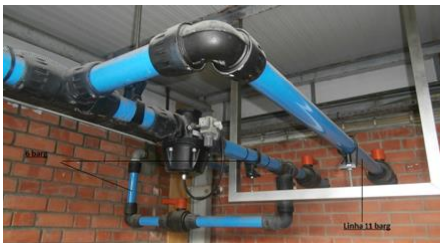
Figura 5.9 Pormenor da rede de distribuição na central de ar comprimido (CCenergia)
