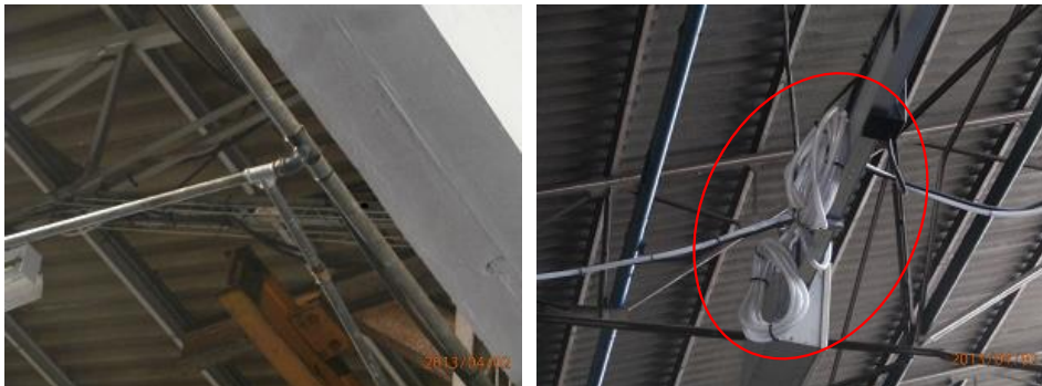
Figura 5.12 Detalhe da rede de distribuição (CC Energia)
