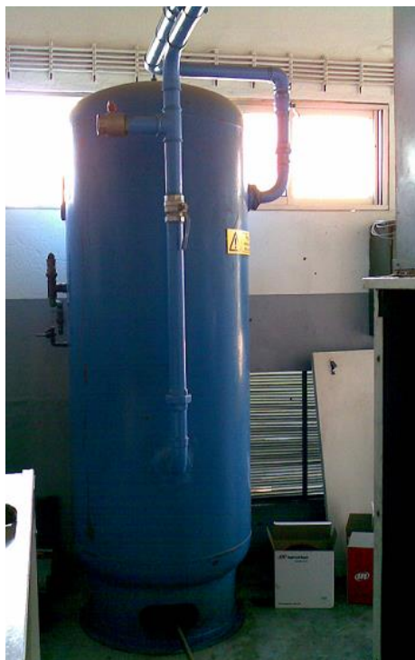
Figura 5.11 Depósito de ar comprimido (CC Energia)
