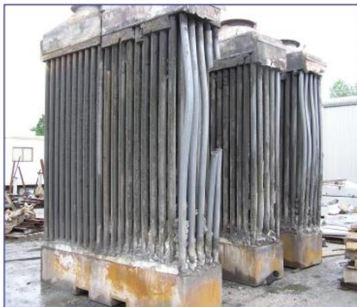
Figura 18 Incrustações em permutadores de calor
