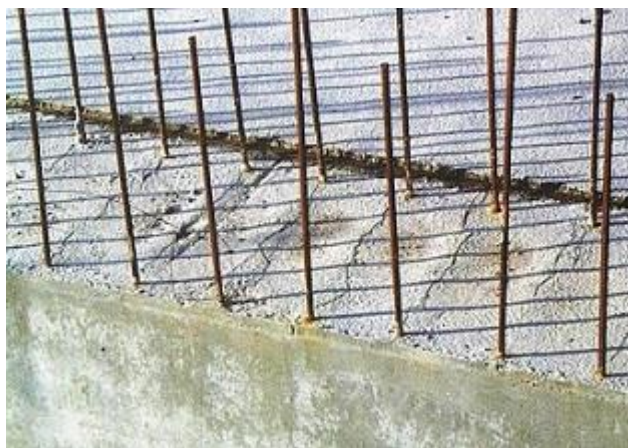
Figura 2.6 Fendilhação por retracção no topo de uma parede de betão armado (Paiva et al., 2006)
