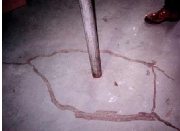
Figura 2.10 Deformações excessivas num pavimento de betão armado (Friedman, 2013)
