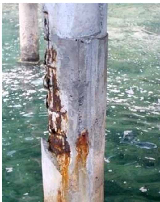
Figura 2.12 Armaduras em meio aquoso em avançado estado de corrosão (A&G Construções)
