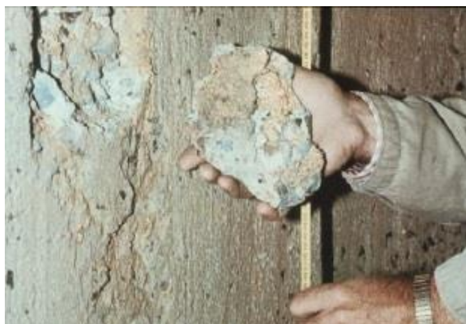
Figura 2.9 Fendilhação do betão devida a reacções expansivas (António Costa, 2009)
