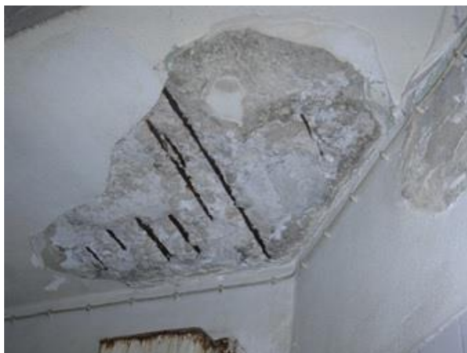
Figura 2.11 Delaminação do betão de recobrimento de uma laje devido à corrosão das armaduras (PDIG, 2013)
