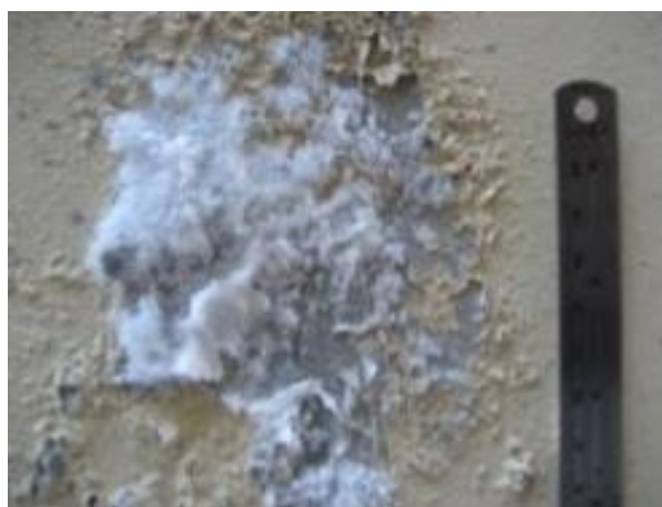
Figura 2.13 Destruição do revestimento por acção da deposição de sais (Moura, 2010)
