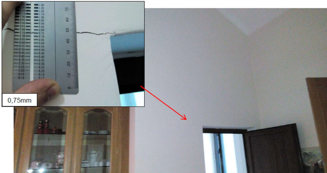
Figura 41- Fissuração no vão de acesso principal (local 5)
