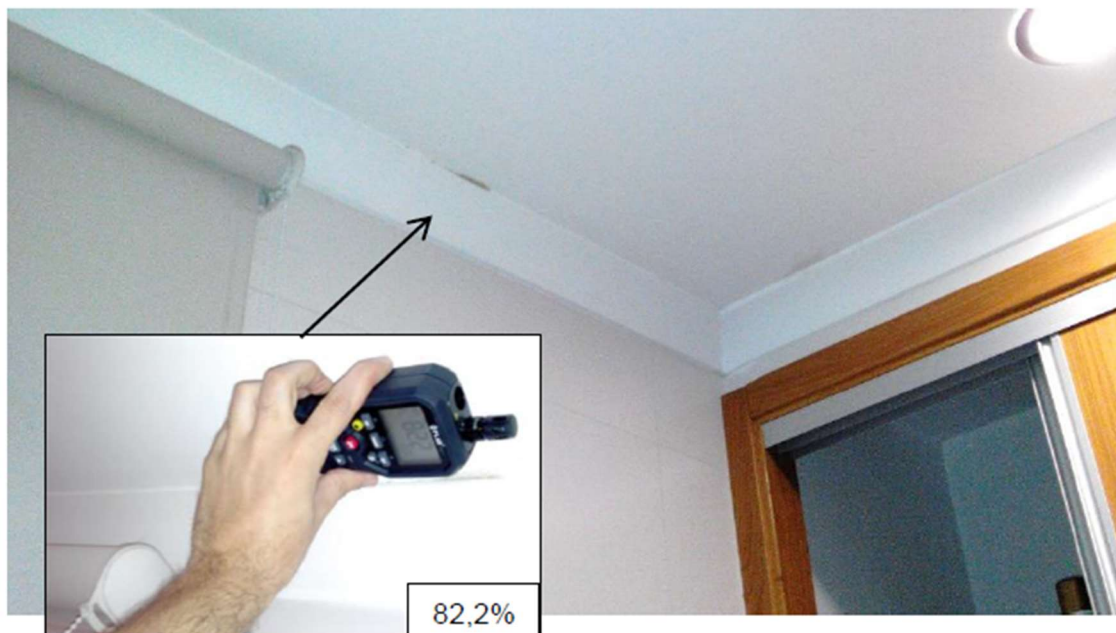
Figura 38- Formação de bolores sobre vão de janela (local 2)
