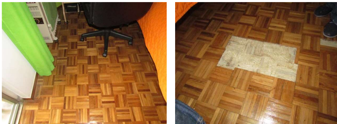
Figura 147 – 1º-D – Quarto – Danos ao nível do pavimento de tacos de madeira
