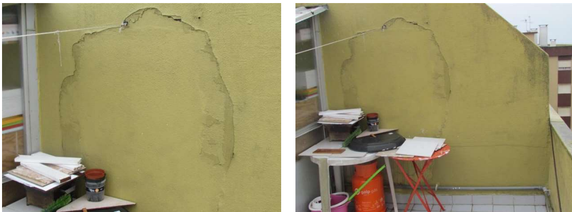
Figura 144 – Terraços – Zona onde foi efetuada abertura (por demolição) durante a obra e que não foi corretamente reparada (reparação de recolocação de telas).
