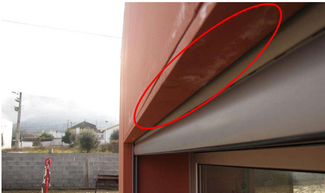
Figura 91 – Escorrências no revestimento por falta de pingadeira
