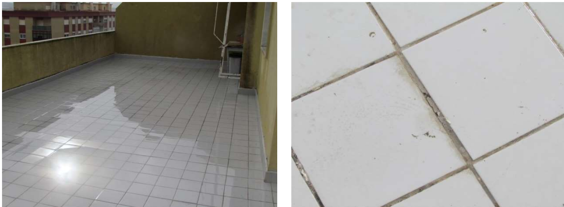
Figura 142 – Terraços – Zonas de acumulação de água (pendentes deficientes) – Empolamento e descolamentos – Perda de material de preenchimento de juntas.
