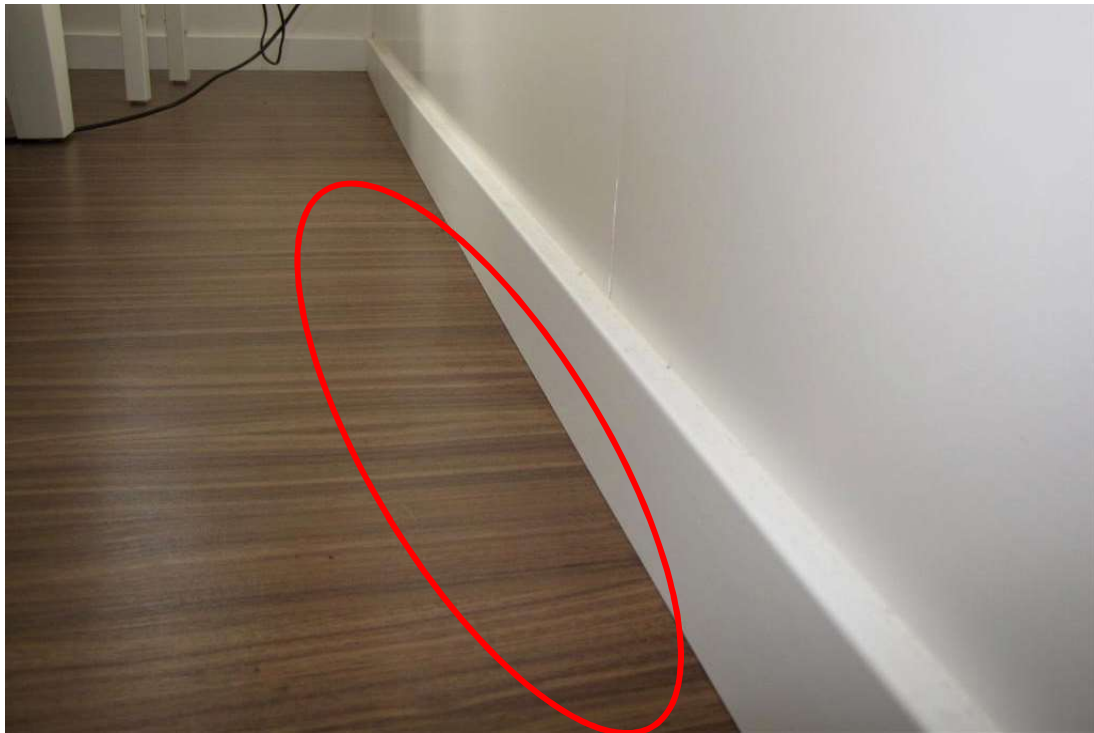
Figura 76 – Manchas de humidade no pavimento e rodapé
