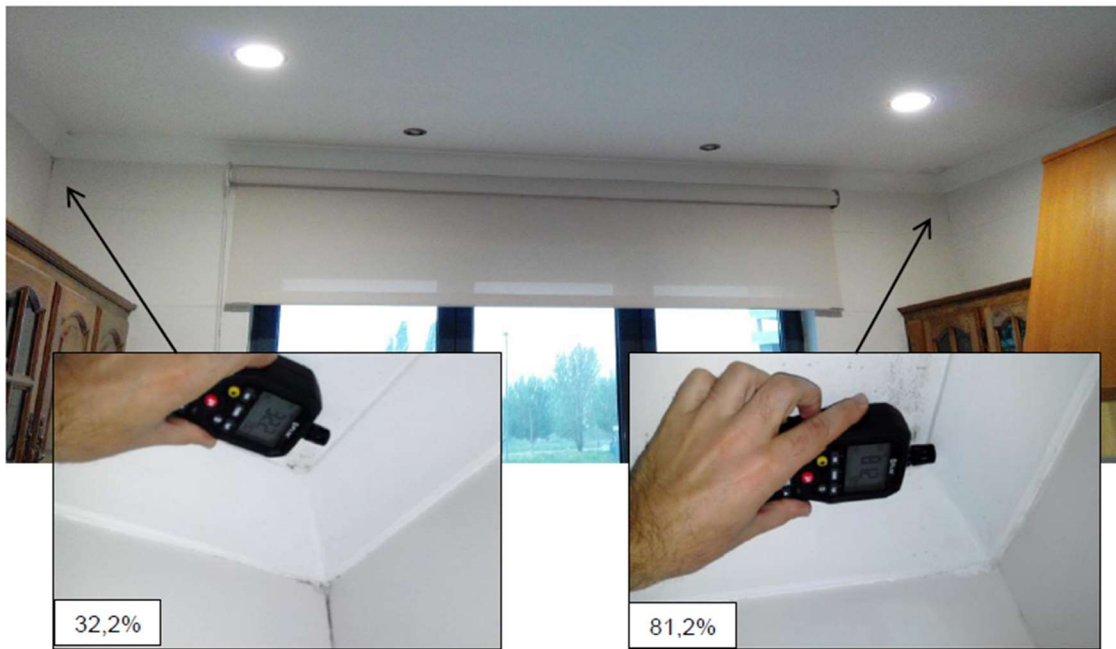
Figura 37 - Formação de bolores nos cantos do teto da cozinha (2 e 3)
