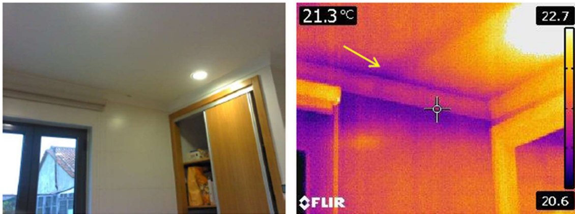
Figura 39 - Análise termográfica do teto da cozinha (local 2)
