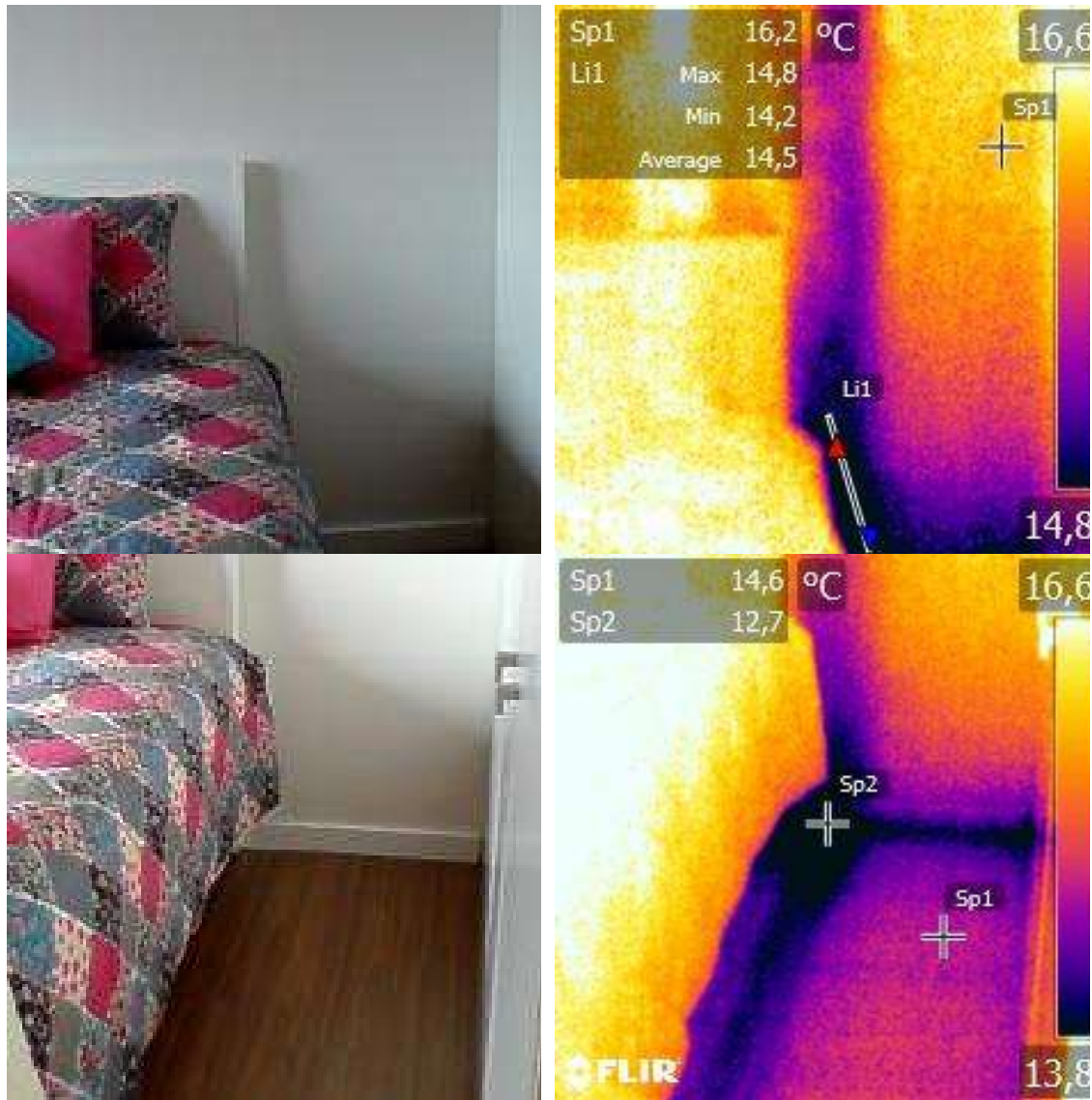
Figura 74 – Ligação entre contentores no quarto 2
