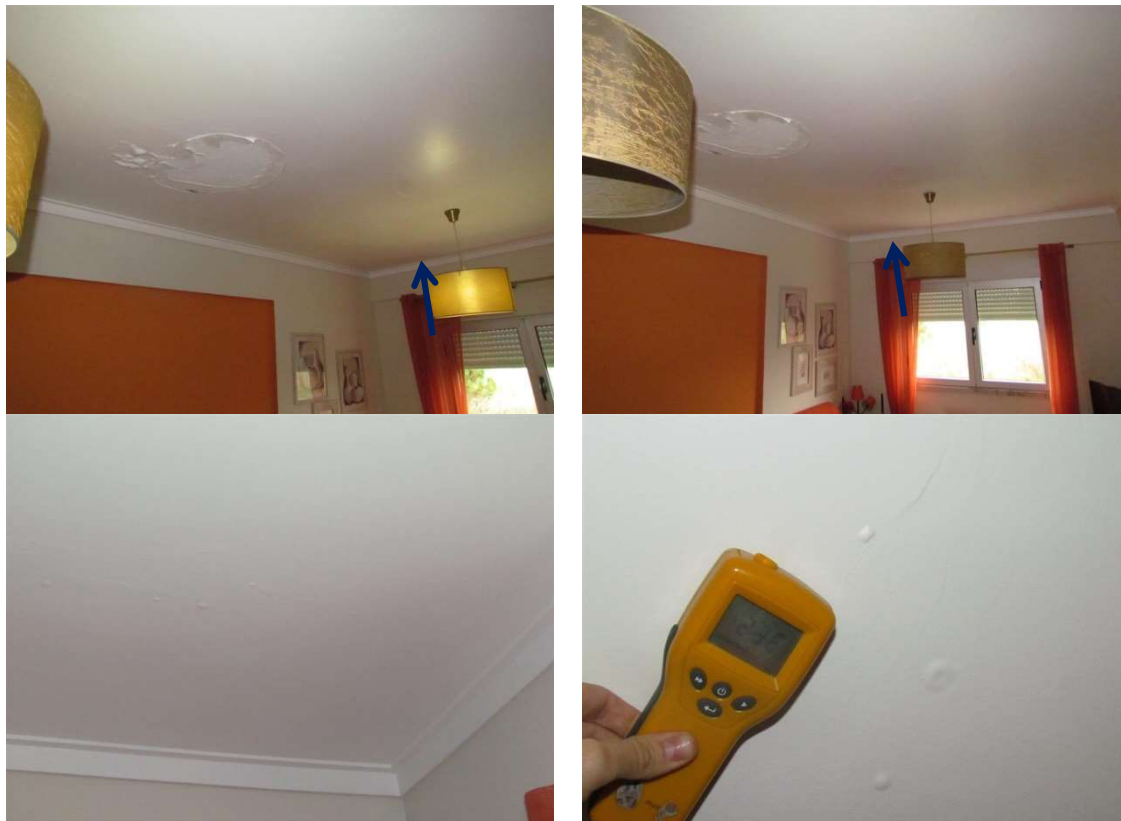
Figura 131 – Fração 4 o -C – Sala – Foco de degradação severa no centro do teto da sala, superfície seca – Foco de infiltração ativa no teto junto do canto da sala, superfície húmida e empolamento da tinta (bolhas).
