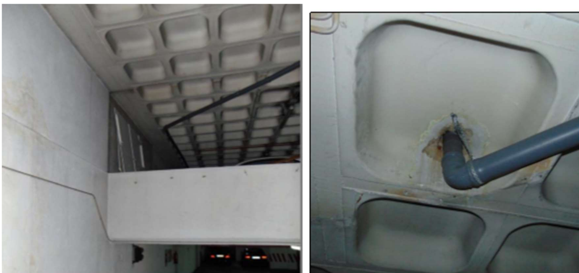
Figura 20 – Acumulação de sais, Garagem -1
