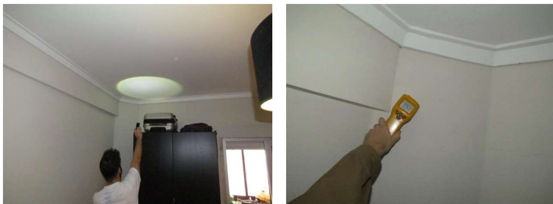
Figura 135 – Fração 4º-C – Quarto 2 – Foco de infiltração ativa junto de courette.
