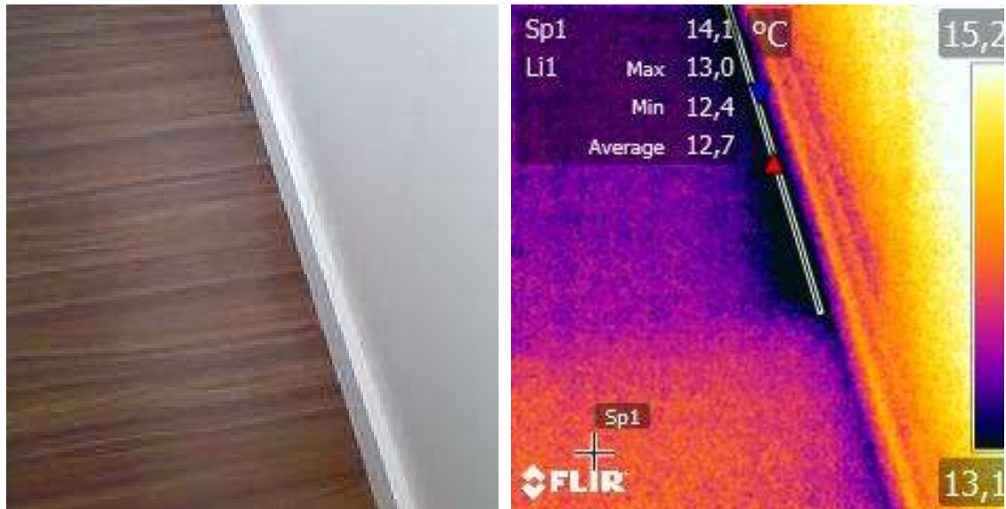
Figura 75– Foco de humidade no pavimento junto ao rodapé (parede norte)
