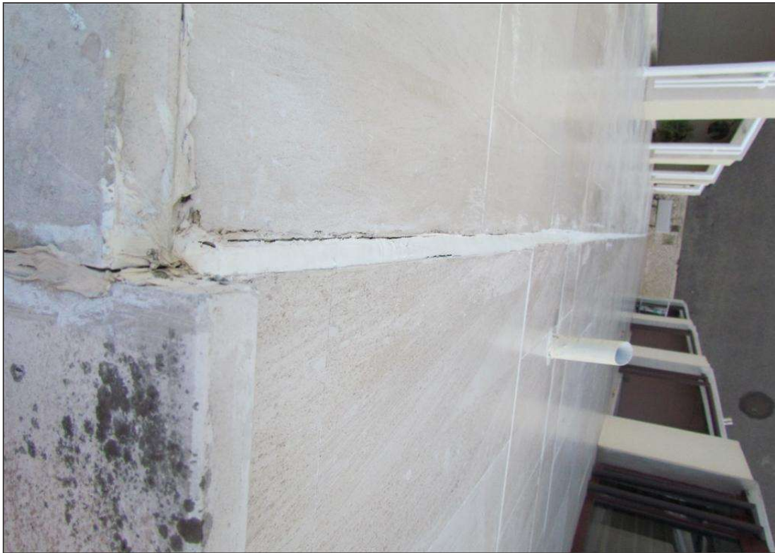
Figura 121 – Desalinhamento das fachadas e fissuração da junta de dilatação entre os dois prédios
