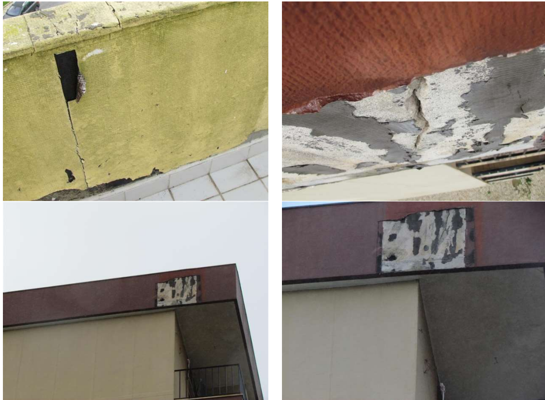
Figura 145 – Terraços – Danos no murete e revestimentos não reparados após a perfuração do mesmo para drenagem do terraço aquando entupimento que ocorreu durante a obra.
