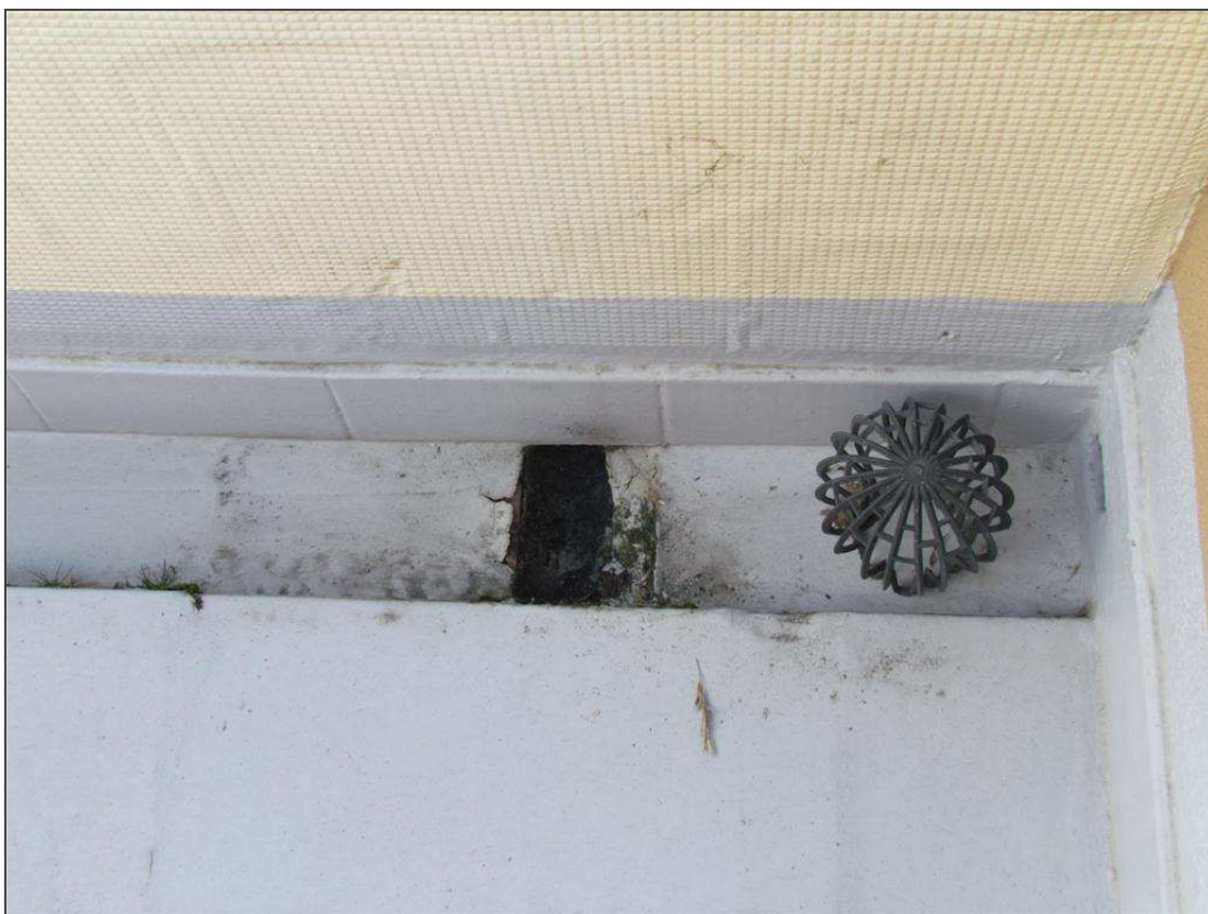
Figura 119 – Presença de vegetação parasitária e fungos, e destacamento do sistema de impermeabilização
