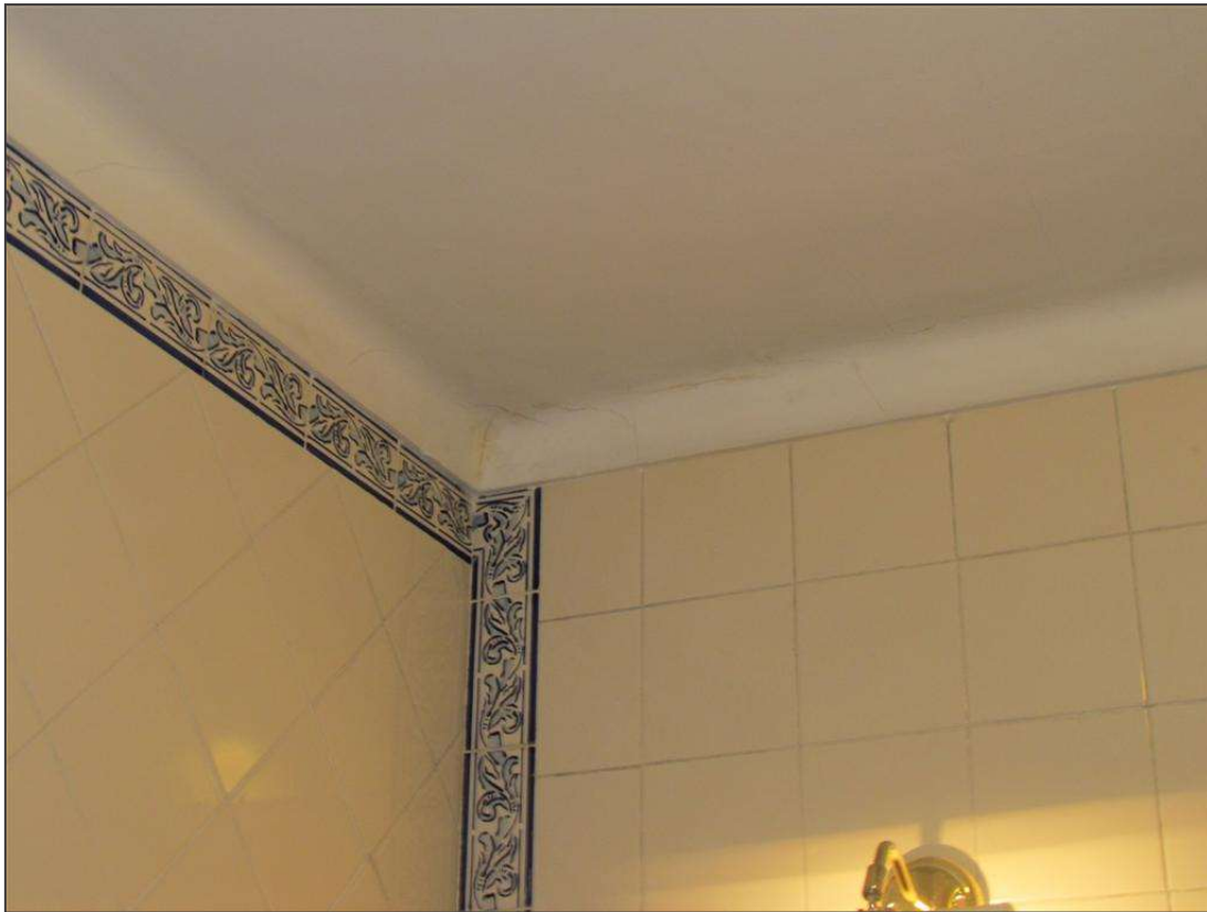
Figura 105 – Manchas de degradação do revestimento e fissuração no roda-teto
