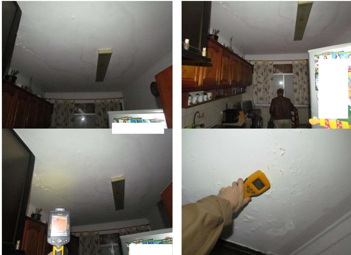
Figura 129 – Fração 4º-B – Cozinha – Degradação severa de revestimentos do teto – Superfície seca.
