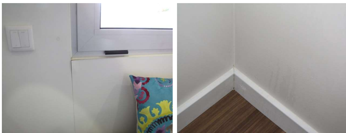
Figura 68 – Condensações junto ao rodapé e destacamento/empolamento do revestimento
