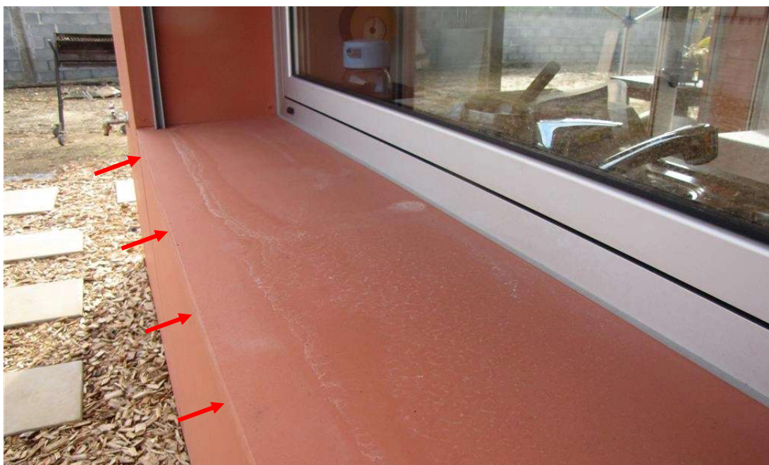
Figura 92 – Manchas no revestimento do peitoril devido à fraca pendente
