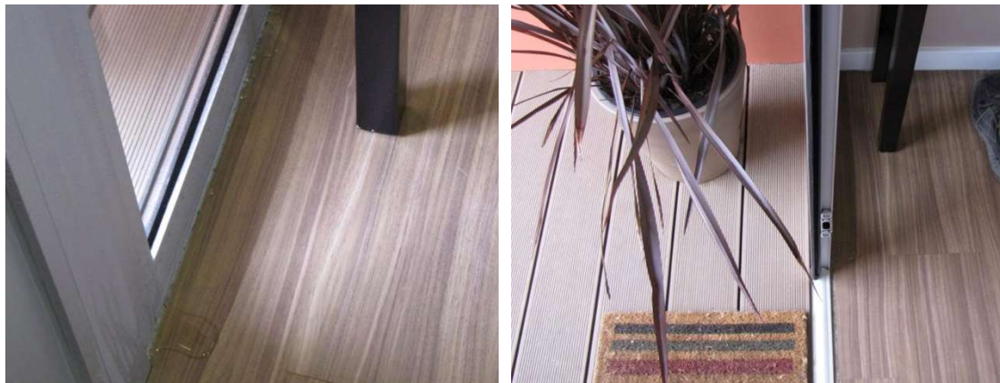
Figura 62- Condensações na caixilharia do vão envidraçado junto à porta
