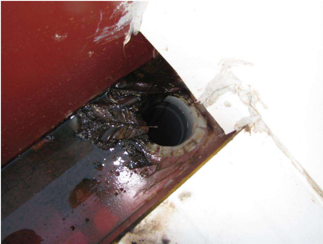
Figura 86 – Inexistência de ralo de pinha
