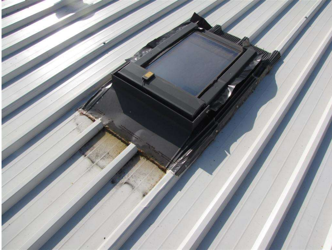
Figura 84 – Manchas no revestimento da cobertura
