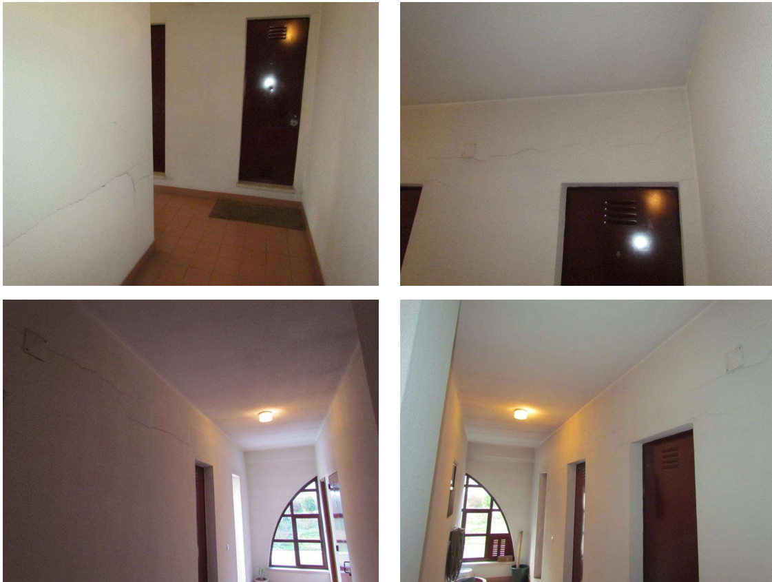
Figura 117 – Fissuração horizontal nas paredes ao longo das arrecadações
