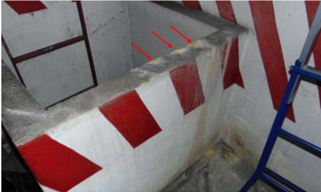
Figura 19 – Acumulação de sais, Garagem -1
