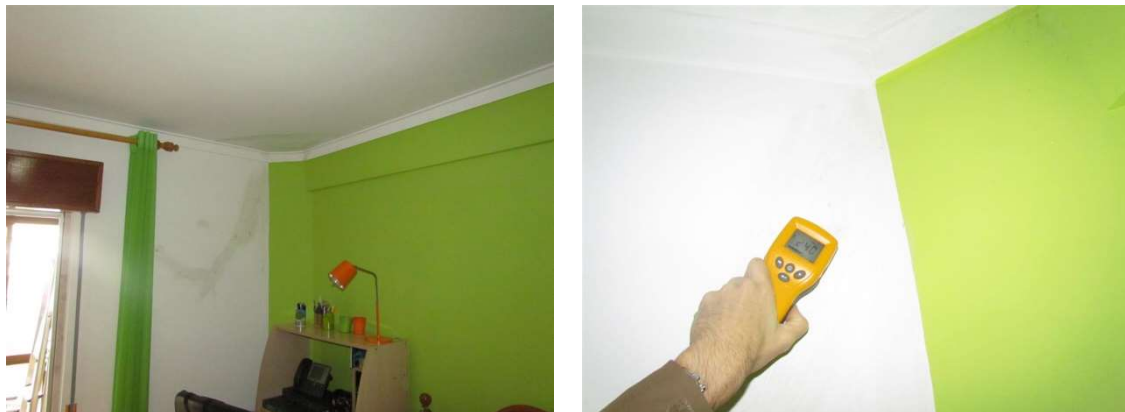
Figura 146 – 1º-D – Quarto – Danos nos revestimentos junto da courette – Superfície húmida.
