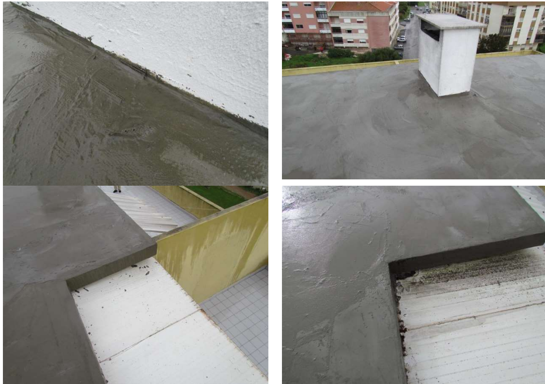
Figura 140 – Cobertura – irregularidades na superfície de acabamento e a armadura de reforço à superfície em algumas zonas – Ausência de remates em torno das chaminés – Resíduos de argamassa em cima dos telhados das marquises e laterais da laje.
