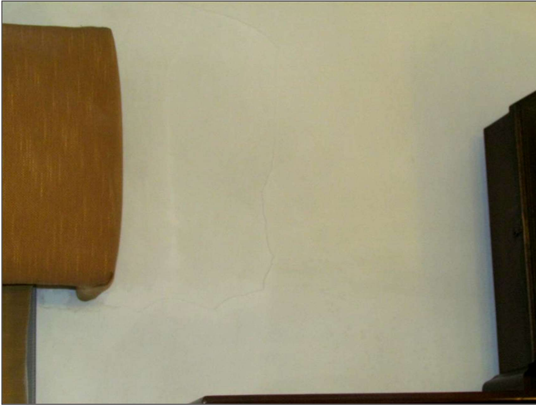
Figura 95 – Fissuração em torno da caixa de estore
