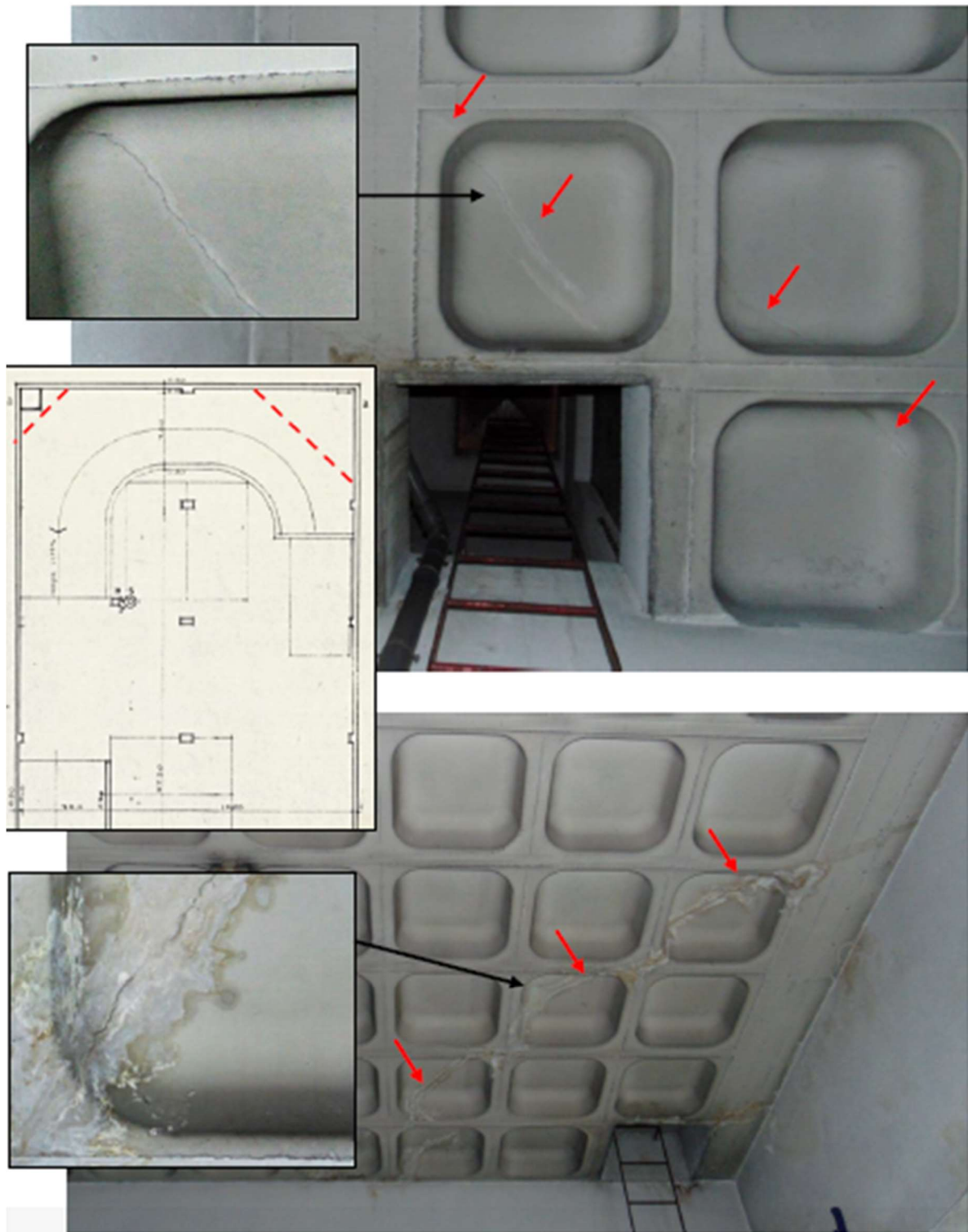
Figura 16-Fissuração, teto de laje Garagem -I
