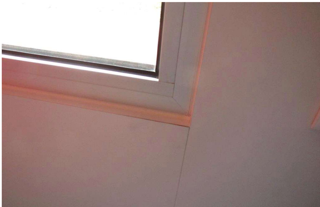
Figura 79 – Condensações no caixilho e empolamento do revestimento da parede
