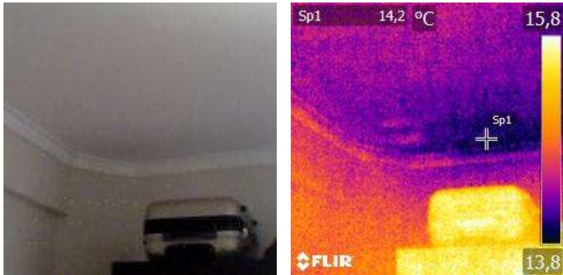
Termograma 2 – Fração 4º-C – Quarto 2 – Foco de infiltração ativa junto da courette (mais notória no teto).
