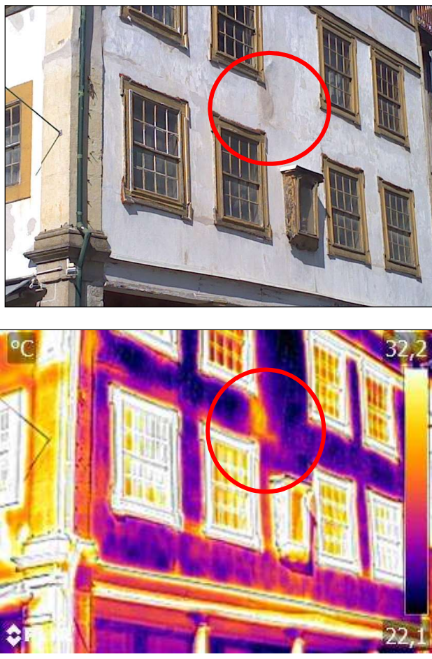
Figura 10- Anomalia no revestimento de uma fachada
