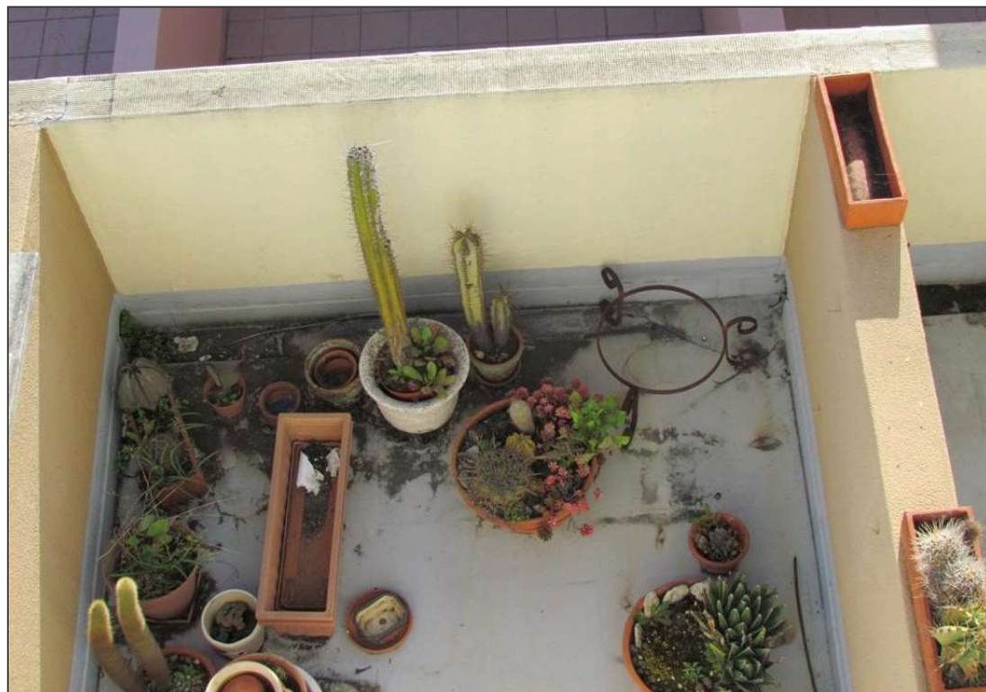
Figura 120 – Fissuração do sistema de impermeabilização do pavimento, presença de vegetação parasitária e acumulação de detritos
