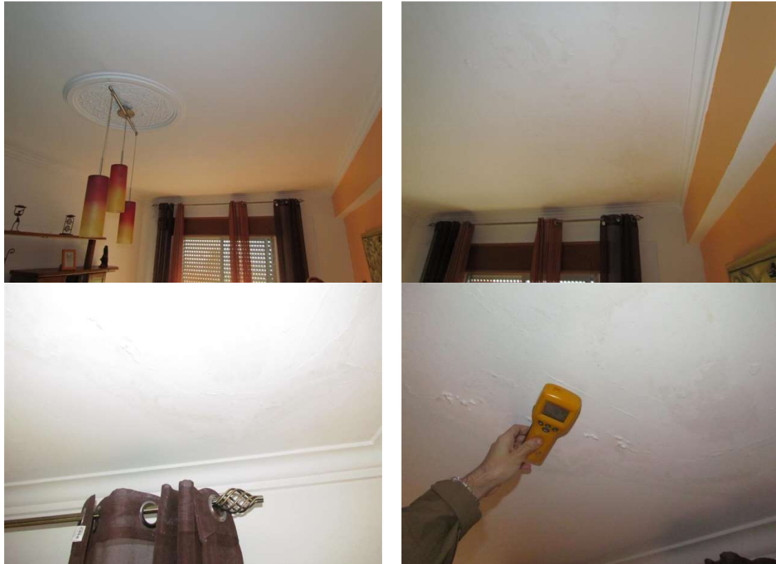
Figura 127 – Fração 4º-B – Sala – Degradação de revestimentos do teto – Superfície seca.
