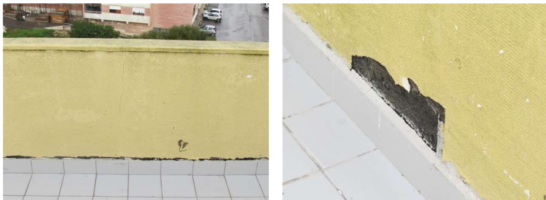
Figura 141 – Terraços – Danos na tela na zona de remate dos rodapés.
