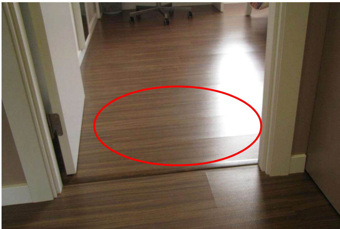
Figura 72 – Empolamento do pavimento flutuante
