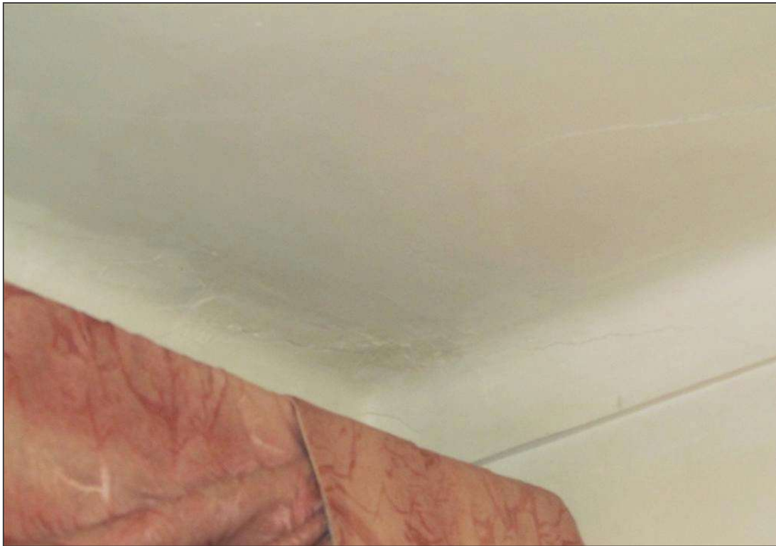
Figura 102 – Fissuração e degradação do revestimento do roda-teto junto vão envidraçado
