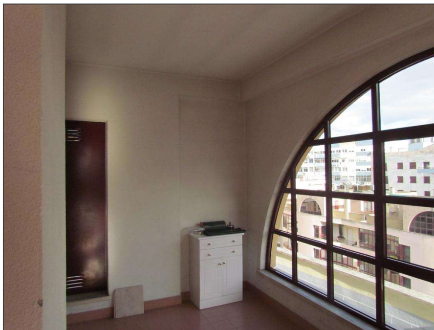
Figura 118 – Manchas de degradação do revestimento no murete sob a soleira do vão envidraçado
