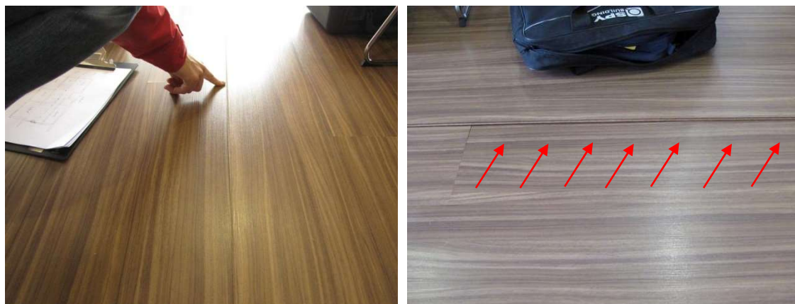
Figura 58-Destacamento do revestimento do pavimento
