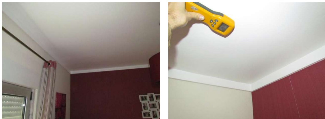
Figura 134 – Fração 4º-C – Quarto 1 – Degradação ligeira no teto – superfície seca.
