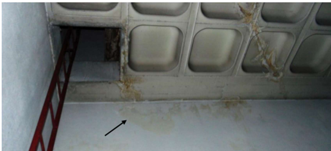
Figura 18 – Deterioração de pintura, Garagem -I
