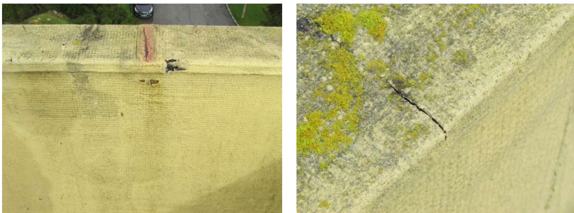
Figura 143 – Terraços – Telas dos muretes degradadas e danificadas (descolamento, empolamentos, fissuração).
