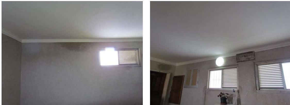
Figura 138 – Topo da caixa-de-escadas – Nada a assinalar – Mancha com sinais aparentes de humidade junto da janela seca à data da inspeção (ver termograma seguinte)
