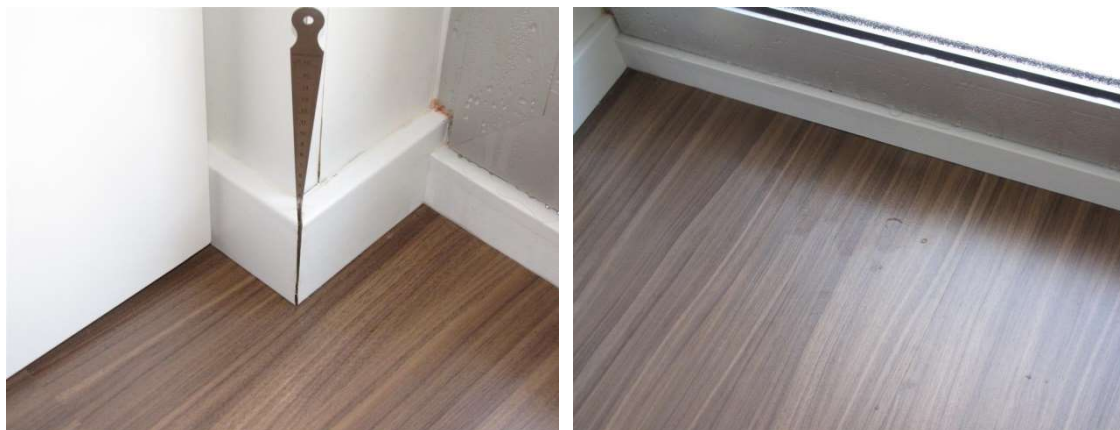
Figura 66 – Condensações junto à caixilharia e empolamento do rodapé
