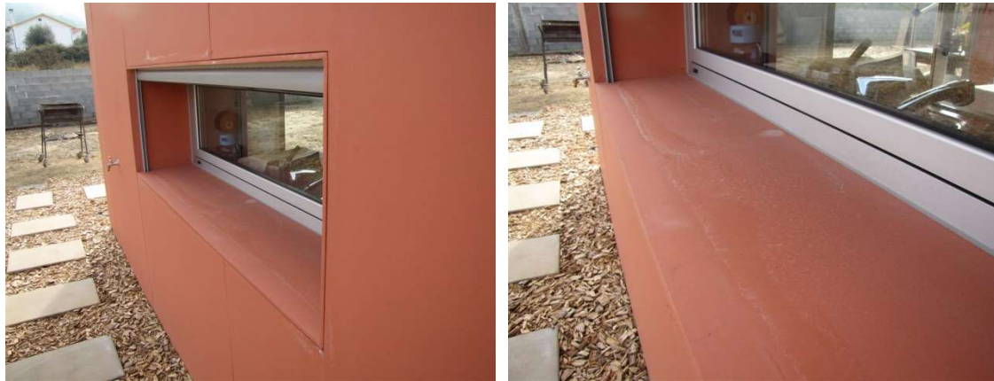
Figura 82 – Escorrências e manchas no revestimento da fachada este
