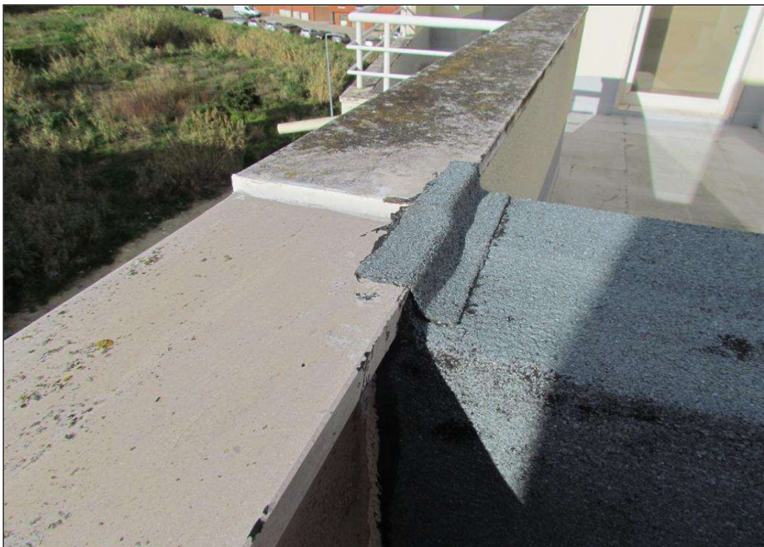
Figura 122 – Deficiente execução de remate com o capeamento do muro
