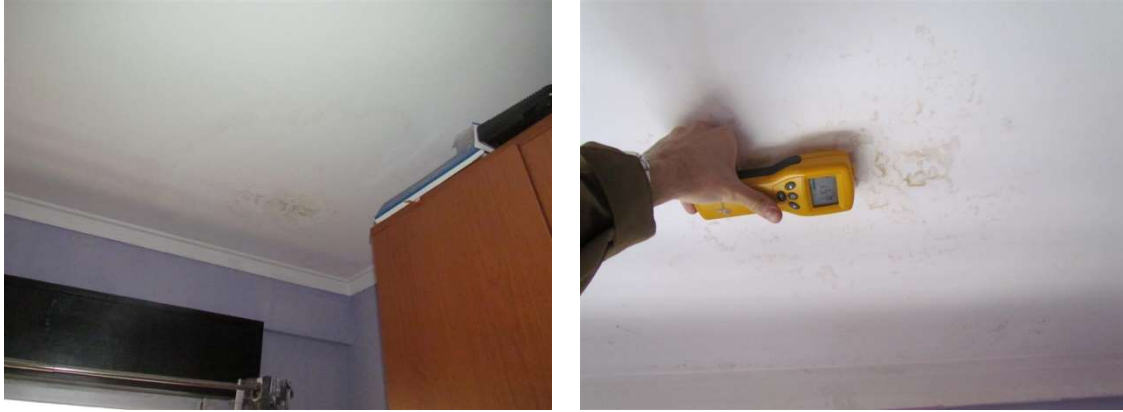
Figura 125 – Fração 4 ª -A – Quarto 2 – Degradação de revestimentos do teto, superfície seca.
