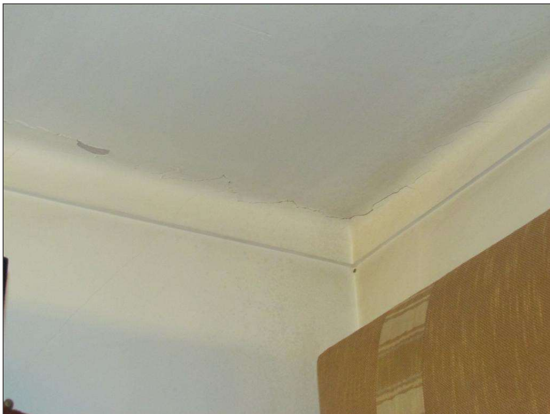
Figura 94 – Fissuração ao longo do roda teto
