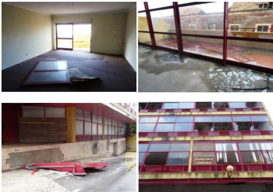
Figura 2.25 - Danos em Caixilharias e Tectos Falsos
