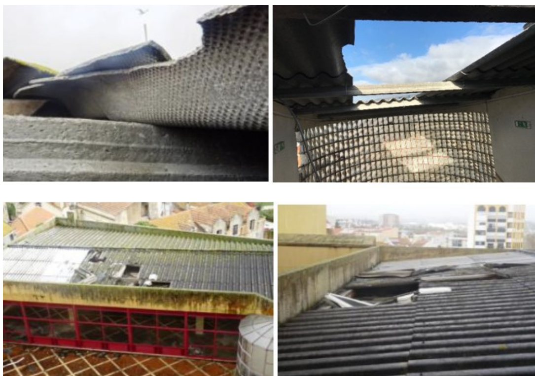
Figura 2.24 - Danos na Cobertura
