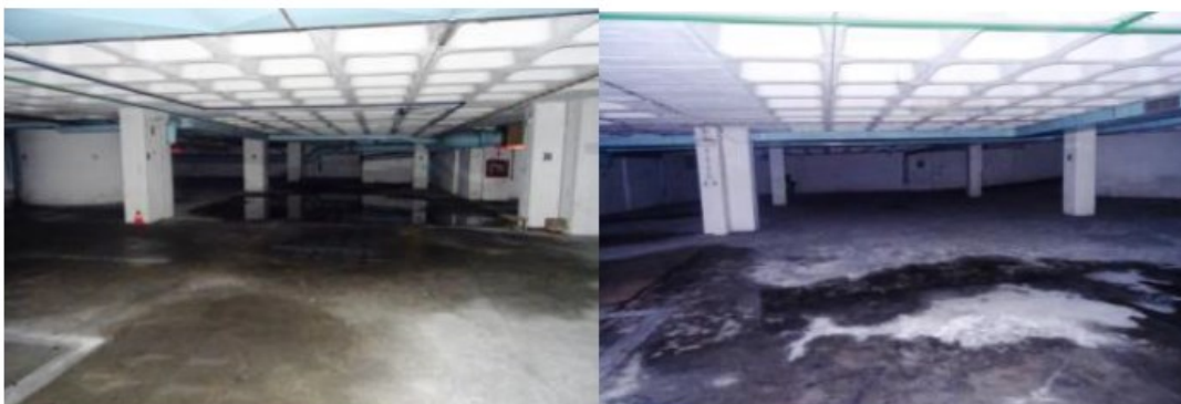
Figura 2.29 - Danos nas zonas das caves devido à inundação
