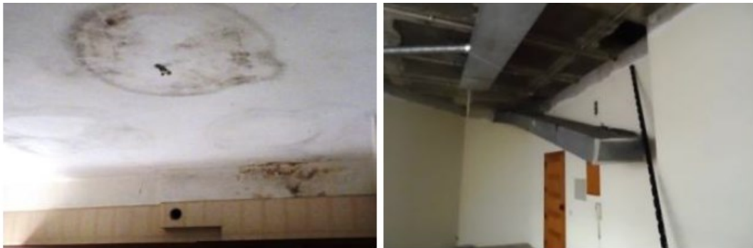
Figura 2.28 - Danos nas instalações especiais Eléctricas e Ventilação
