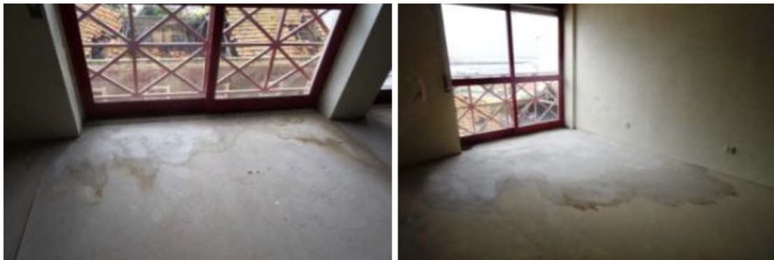
Figura 2.27 - Danos em Pavimentos Interiores
