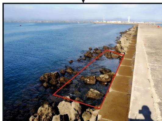
Figura 4.39 – Troço G (ponto 15, talude interior, vista sentido do enraizamento). Cima) situação em 2020; baixo) situação em 2022
