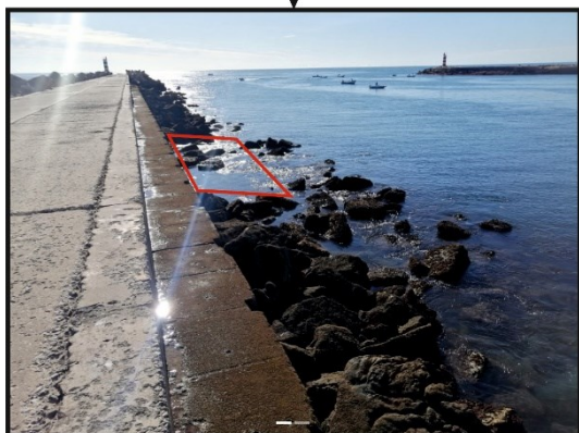
Figura 4.38 – Troço G (ponto 13, talude interior, vista sentido da cabeça). Cima) situação em 2020; baixo) situação em 2022
