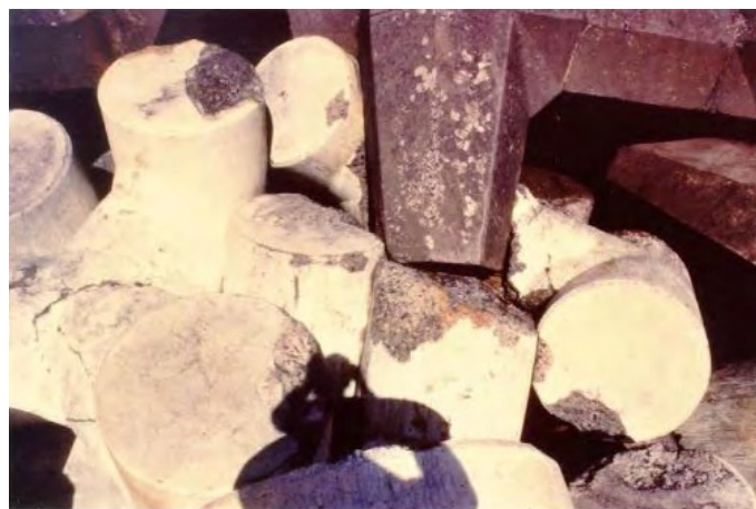
Figura 2.10 – Exemplo de perdas de massa, evidenciada nas arestas danificadas (arestas arredondadas)
